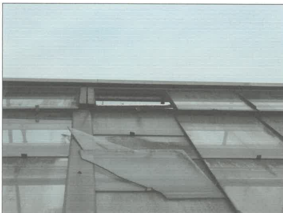
Uszkodzony fragment szklenia dachu.
