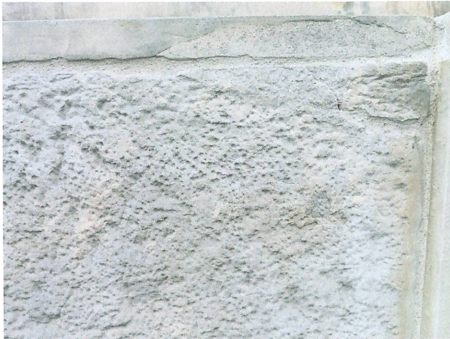
Fot. 11. Widoczne na fotografii: Fragment płyty z boniowaniem, spękania i ubytki.
