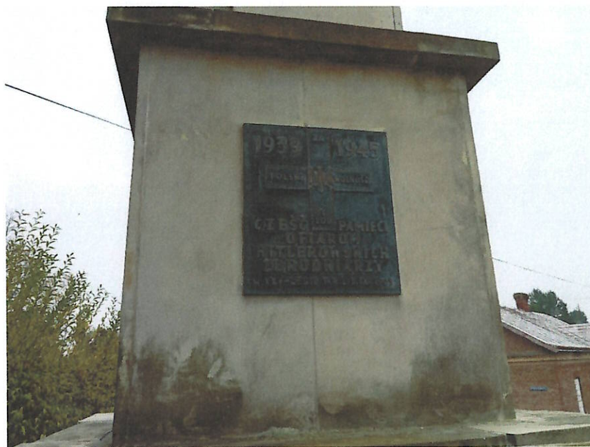
Fot. 5. Widoczne na fotografii: Widok na płytę inskrypcyjną umieszczoną na cokole od strony południowo-zachodniej, odbarwienia biologiczne na płycie z piaskowca.
