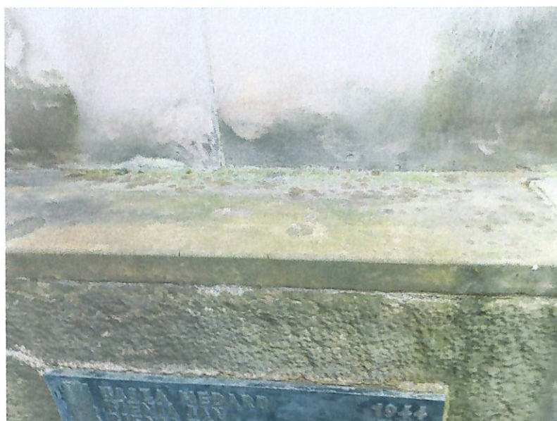
Fot. 14. Widoczne na fotografii: Widok w miejscu łączenia podstawy z cokołem, widoczne niekorzystne zmiany wizualne w postaci nalotów, zaplamień i wykwitów, nawarstwienia i nacieki biologiczne.
