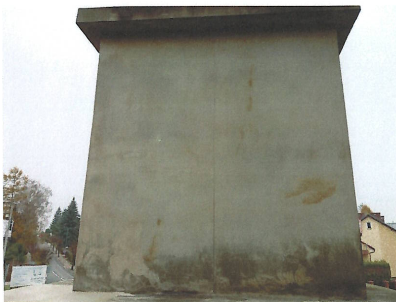
Fot. 8. Widoczne na fotografii: Widok z tyłu – strony północno-zachodniej, płyty piaskowca z widocznymi zabrudzeniami biologicznymi.
