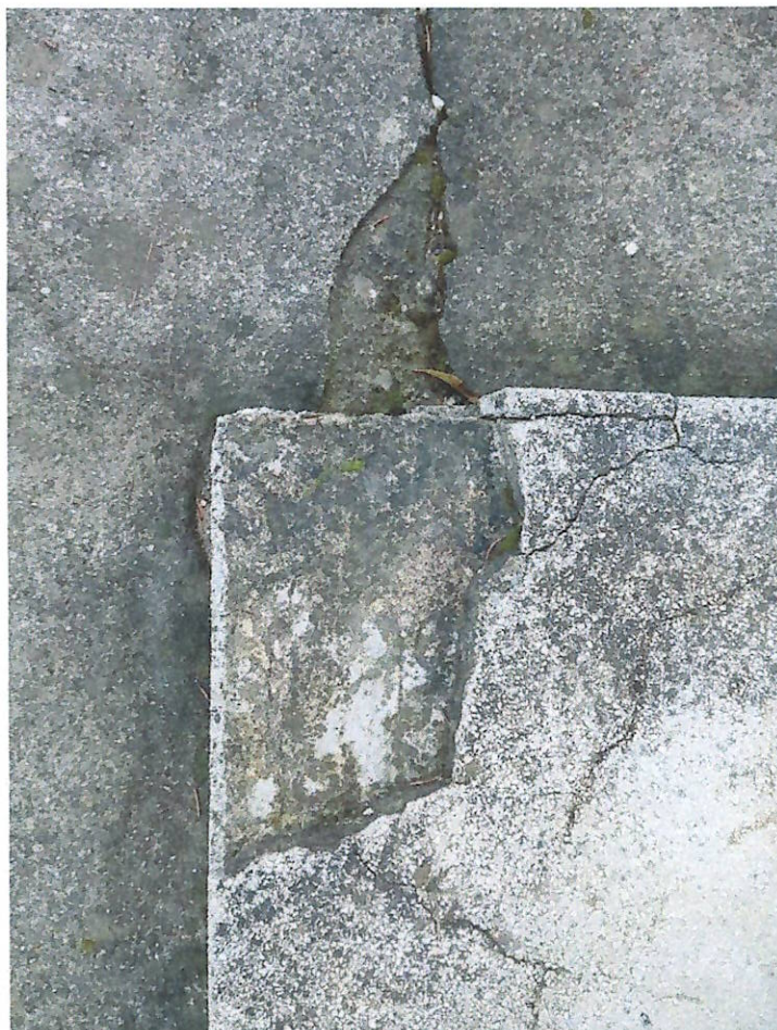
Fot. 13. Widoczne na fotografii: widok z góry na fragment opaski betonowej, widoczny spory ubytek oraz spękania, oraz zabrudzenia.
