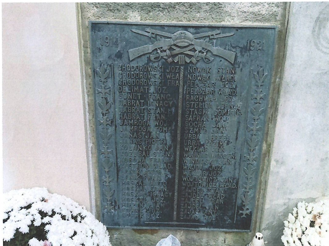
Fot. 7. Widoczne na fotografii: widok z przodu strony południowo - wschodniej, płyta inskrypcyjna umieszczona na podstawie pomnika, widoczny brud, patyna, oraz luźne i sypkie fragmenty, wykwity solne.
