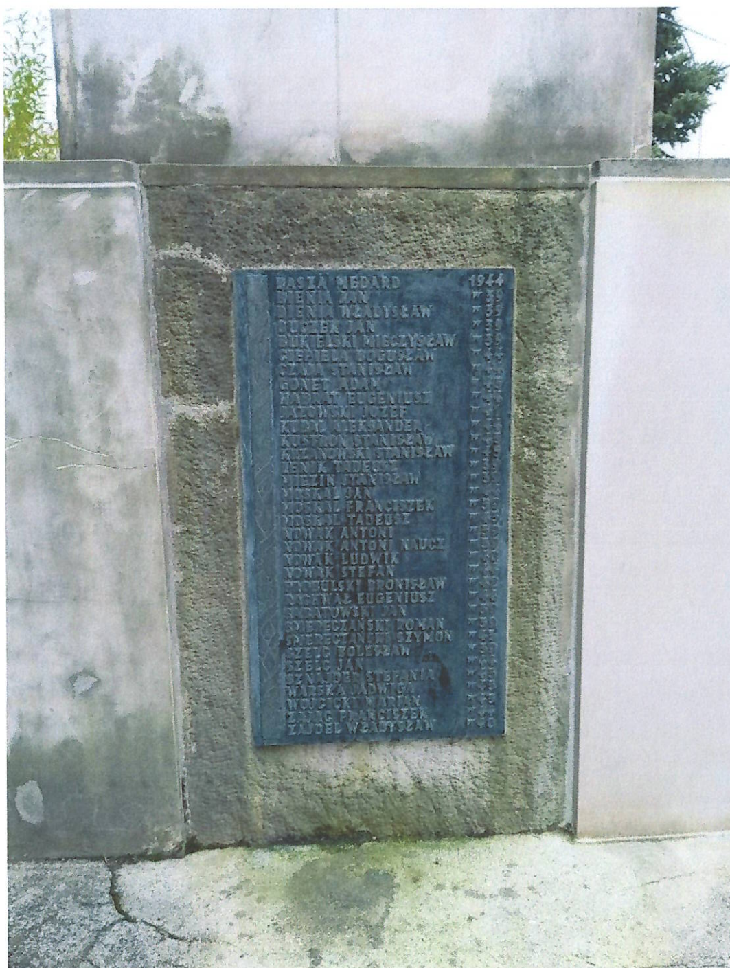
Fot. 6. Widoczne na fotografii: Widok na płytę inskrypcyjną umieszczoną na podstawie od południowo-zachodniej strony, odbarwienia, nawarstwienia biologiczne na powierzchni kamiennej, spękania, uszkodzenia mechaniczne, oraz odspojenia na łączeniach.
