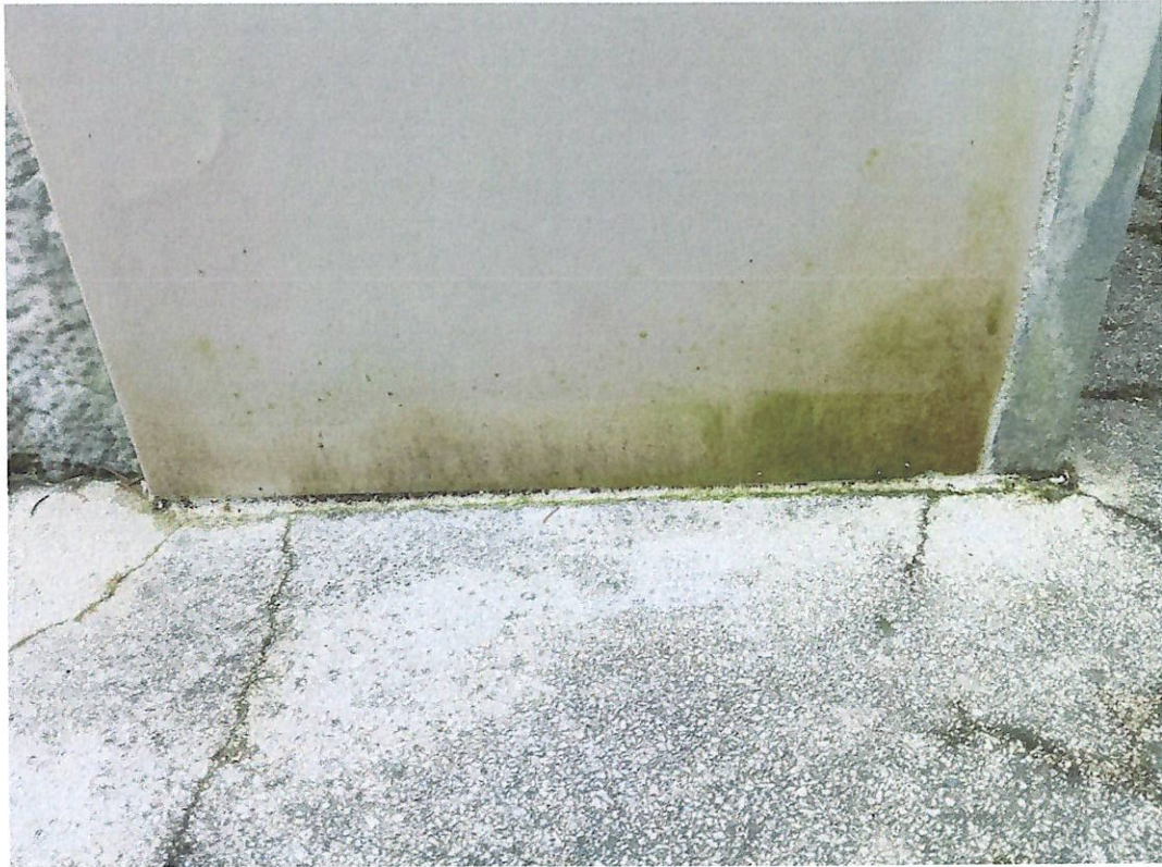
Fot. 15. Widoczne na fotografii: Widok na fragment płyty, dół podstawy przy betonowej opasce, widoczne zielonkawe nawarstwienia flory, oraz spękania na powierzchni opaski betonowej.
