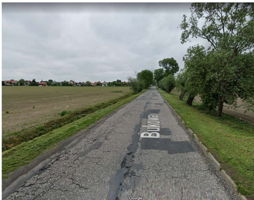
Zdjęcie nr 1 Stan nawierzchni drogi - odcinek nr 1 Rosnowo - Walerianowo - widok w kierunku Rosnowa
