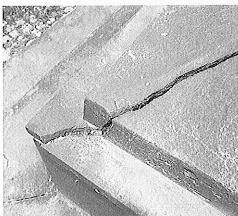
Fot. 13 Podstaw pomnika. Naroże północno wschodnie. Pęknięcie naroża cokołu podstawy na styku ze stopniami.
