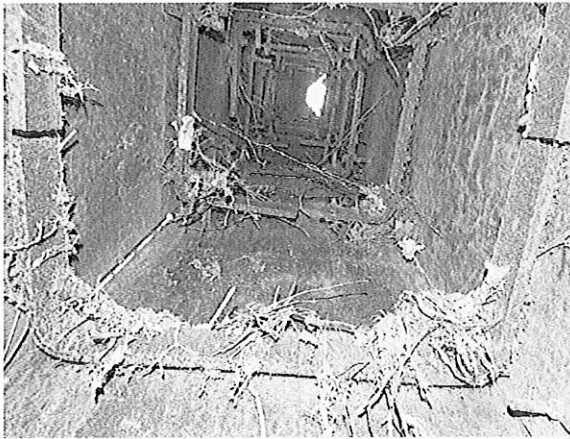
Fot. 21 Wnętrze iglicy. Korozja klamer spinających żeliwne płyty płyty. U góry prześwit świadczący o braku pokrywy na szczycie pomnika.
