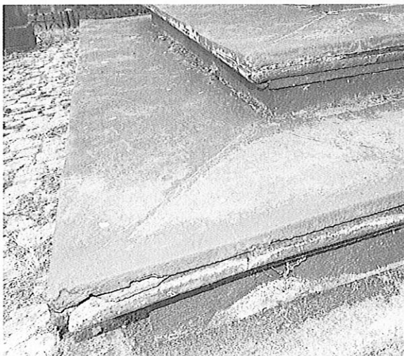
Fot. 15 Uszkodzenia żeliwnych płyt schodów pomnika. Rozwarstwienie płyt stopnicy. Korozja wewnątrz powstałych szczelin
