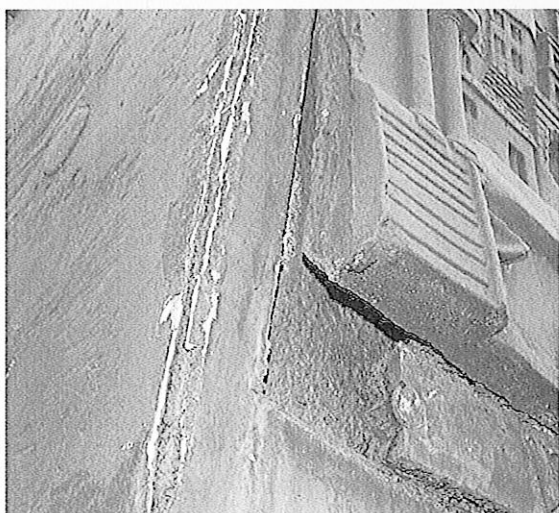
Fot. 7 Iglica pomnika. Intensywna korozja płyty żeliwnej (ściany iglicy) pod płytą z odlewem w formie płaskorzeźby. Uszkodzenia krawędzi płyt na łączeniach elementów.
