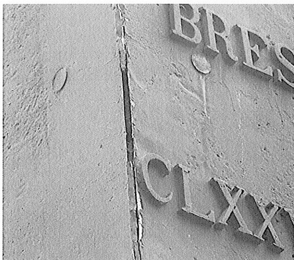
Fot. 5 Iglica pomnika. Odspojenia szczeliwa na styku płyt żeliwnych.
