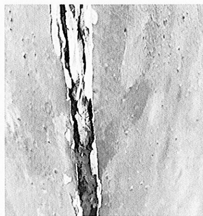
Fot. 14 Podstawa pomnika. Uszkodzenie na styku żeliwnych płyt podstawy. W głębi szczeliny widoczny materiał uszczelniający połączenie.
