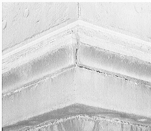
Fot. 8 Gzyms na styku iglicy z podstawą. Pęknięcie i odspojenie żeliwnego odlewu. Korozja na styku łączonych elementów gzymsu.
