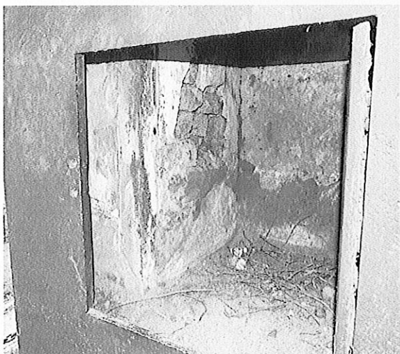
Fot. 17 Otwór rewizyjny z drzwiczkami na północnej elewacji pomnika. Wewnątrz widoczne uszkodzenia wymurowania z cegły i korozja kształtownika konstrukcyjnego.
