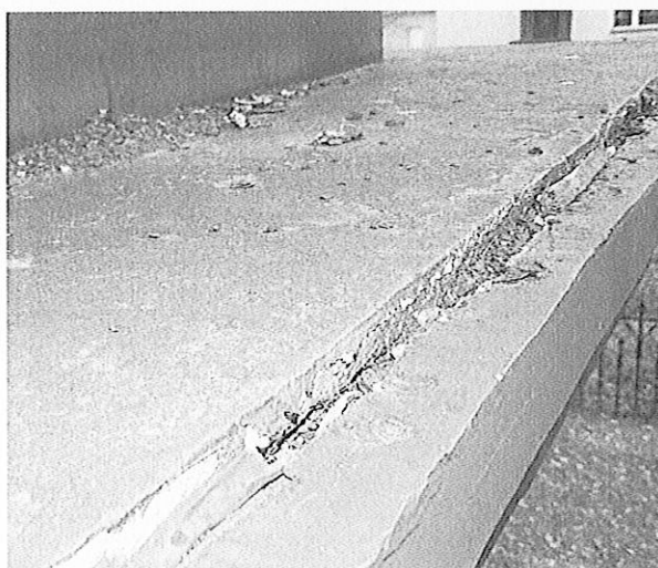
Fot. 11 Uszkodzenia na styku elementów gzymsu pomiędzy iglicą i podstawą pomnika. Ubytki materiału doszczelniającego połączenia.
