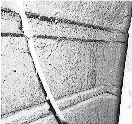
Fot. 19 Wnętrze podstawy pomnika. Korozja niezabezpieczonych żeliwnych płyt podstawy.
