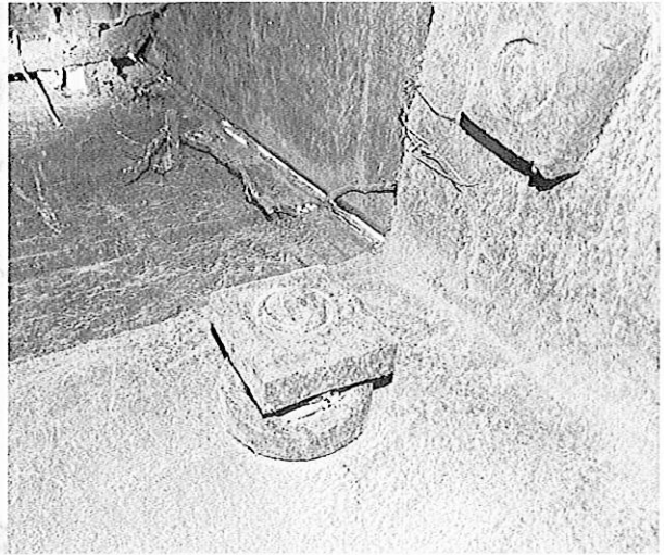
Fot. 20 Wnętrze iglicy. Korozja śrub łączących płyty iglicy z cokołem iglicy. Ubytki szczeliwa na styku żeliwnych płyt.
