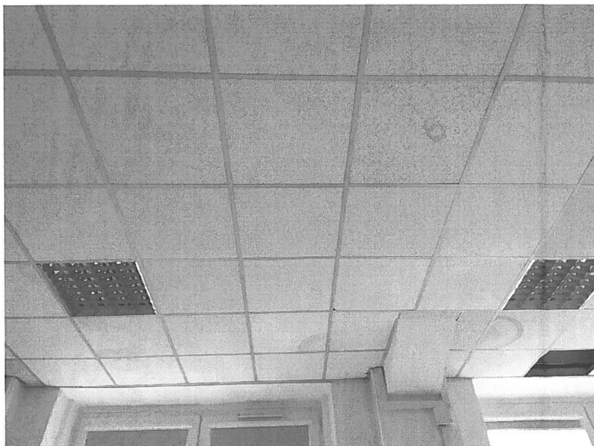
Rysunek 21. Sala ST133. Zacieki na suficie podwieszanym.
