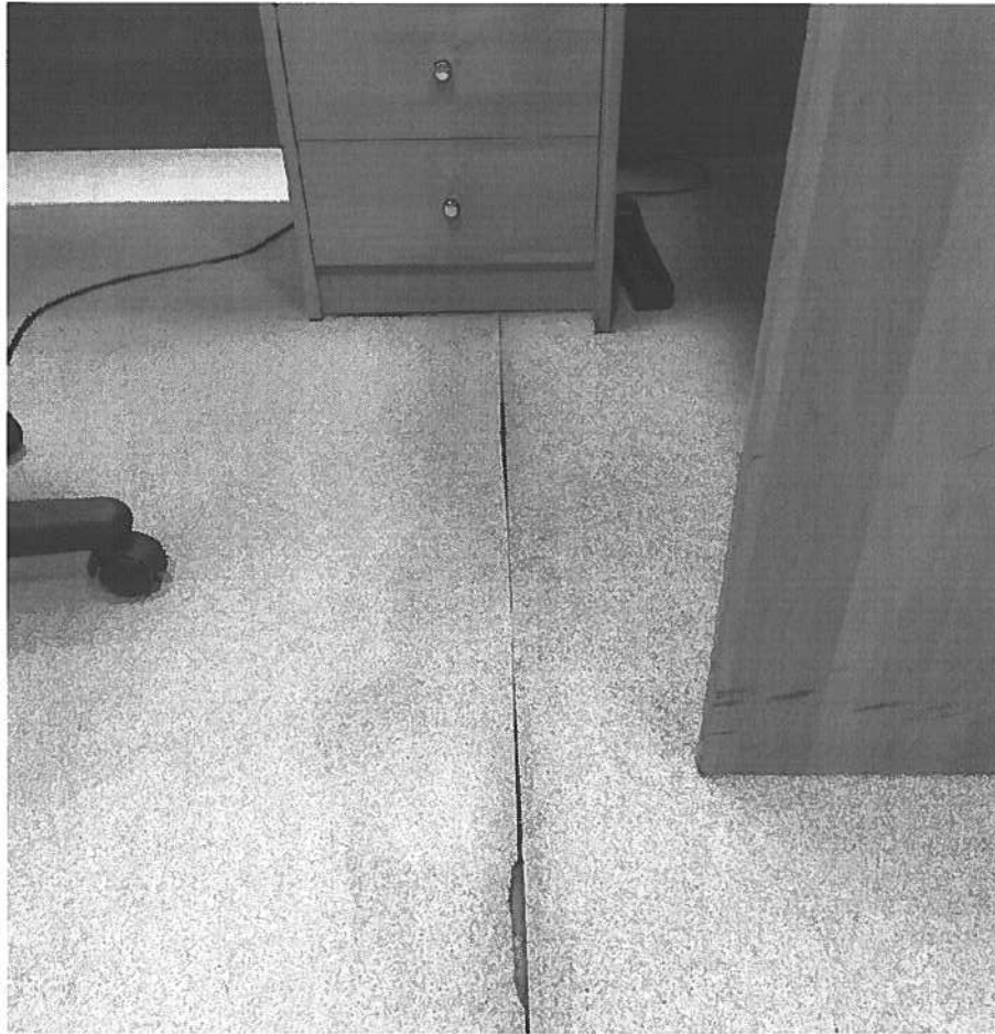
Rysunek 39. Sala ST129. Uszkodzona wykładzina, pęczniejąca od wody.
