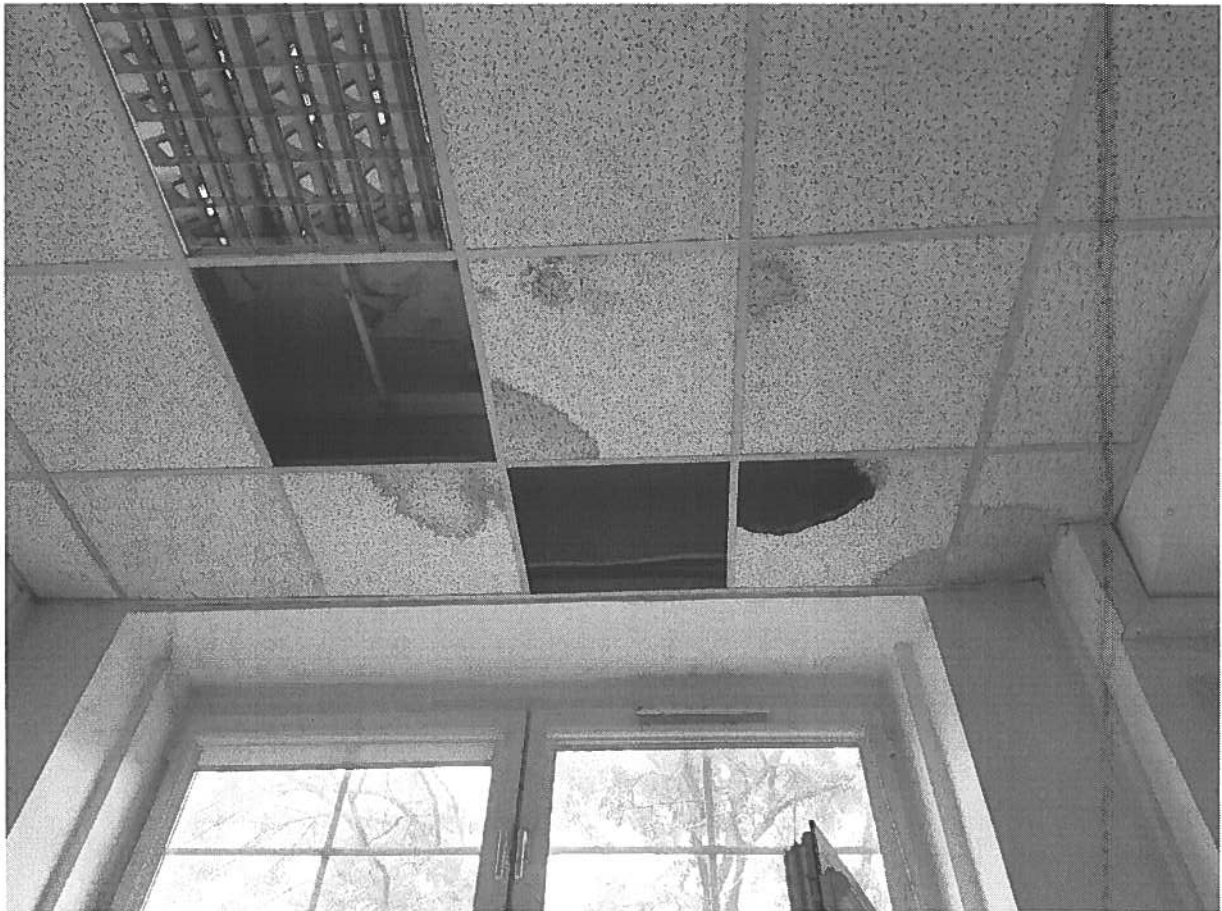
Rysunek 16. Sala ST138. Zacieki na suficie podwieszanym. Widoczne miejsca po kolejnych płytach, które rozpadły się od wody. Jedna płyta jest w trakcie rozpadu.
