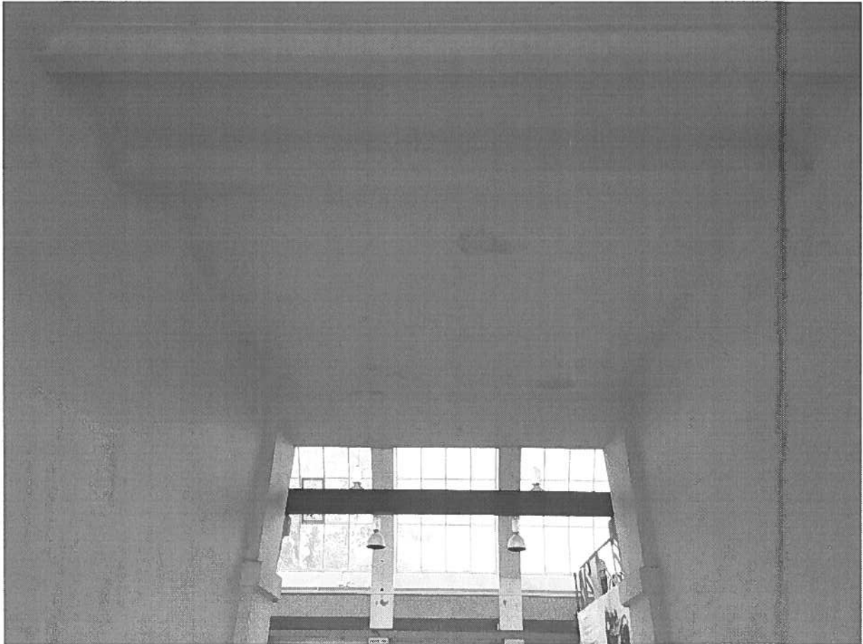
Rysunek 41. Klatka schodowa do sal ST141 i ST138. Zacieki na suficie.
