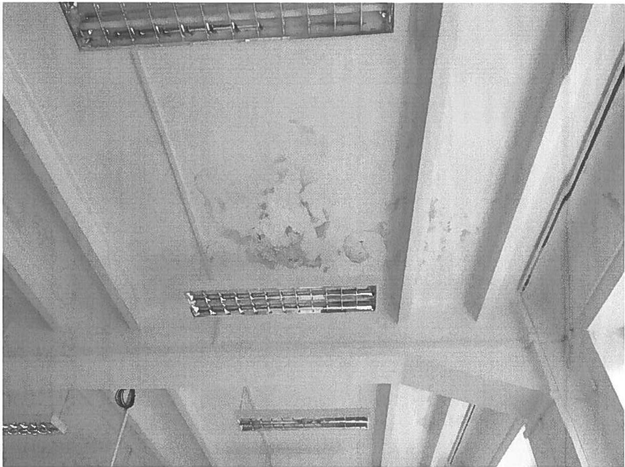
Rysunek 8. Sala ST141. Zacieki na suficie. Odpadająca farba.
