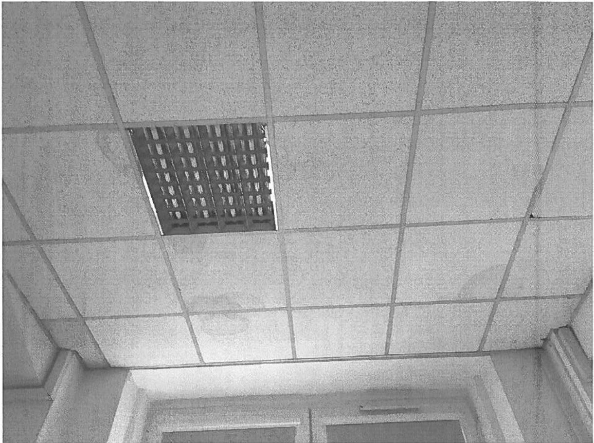
Rysunek 26. Sala ST133. Zacieki na suficie podwieszanym.
