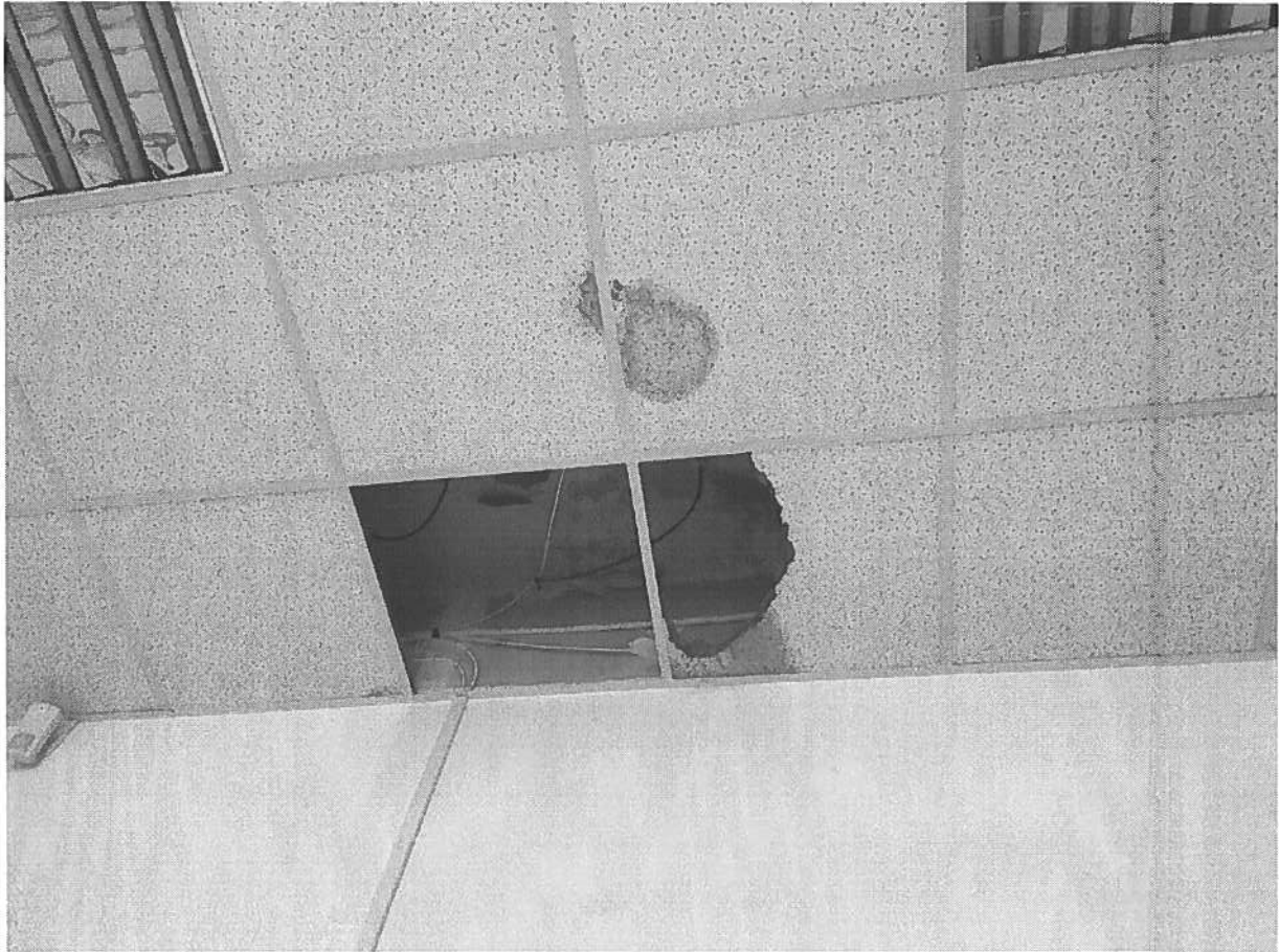
Rysunek 30. Sala ST131. Uszkodzenia sufitu podwieszanego.
