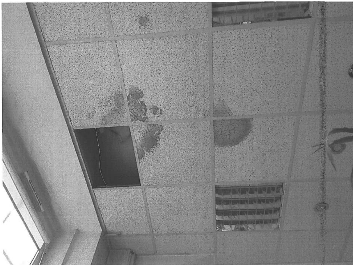
Rysunek 31. Sala ST131. Uszkodzenia sufitu podwieszanego. Widoczne pęknięcia płyt.
