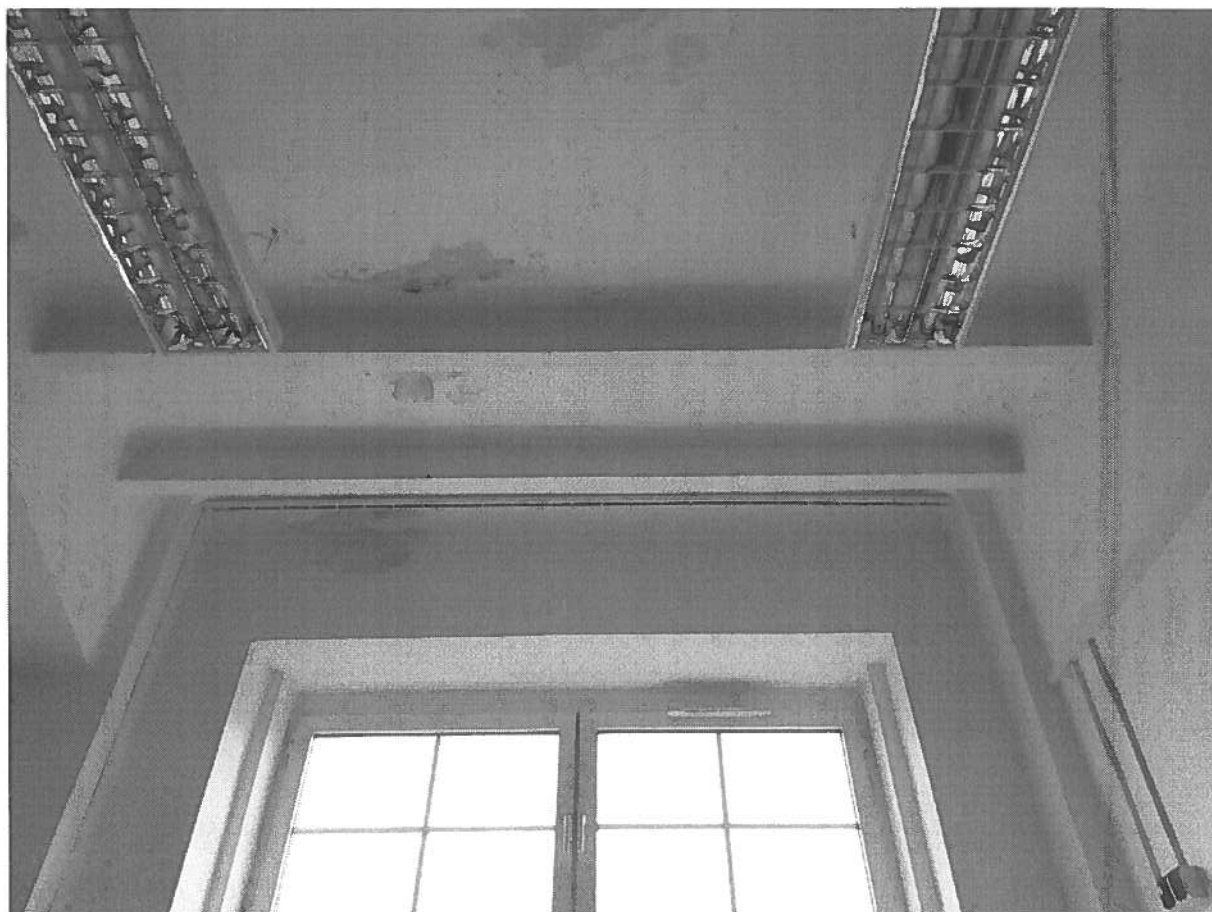
Rysunek 10. Sala ST141. Zacieki na suficie. Odpadająca farba.
