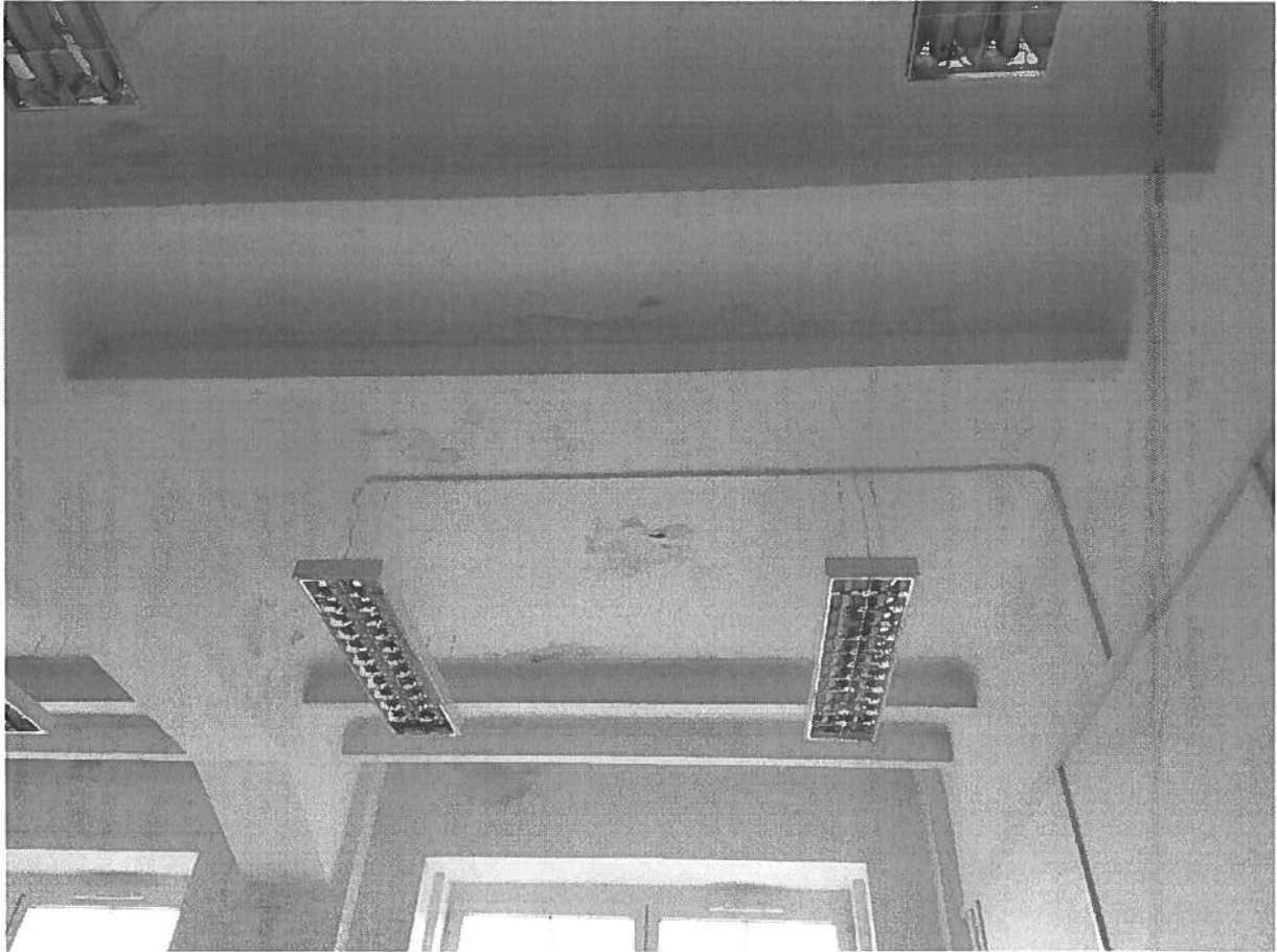
Rysunek 11. Sala ST141, Zacieki na suficie. Odpadająca farba.
