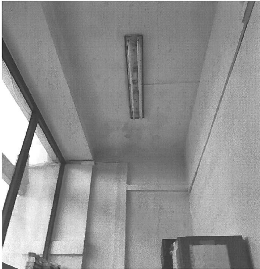
Rysunek 46. Korytarz do pokojów ST129, 130, 131, 132. Zacieki na suficie.
