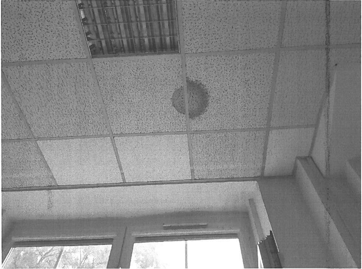
Rysunek 19. Sala ST133. Zacieki na suficie podwieszanym.
