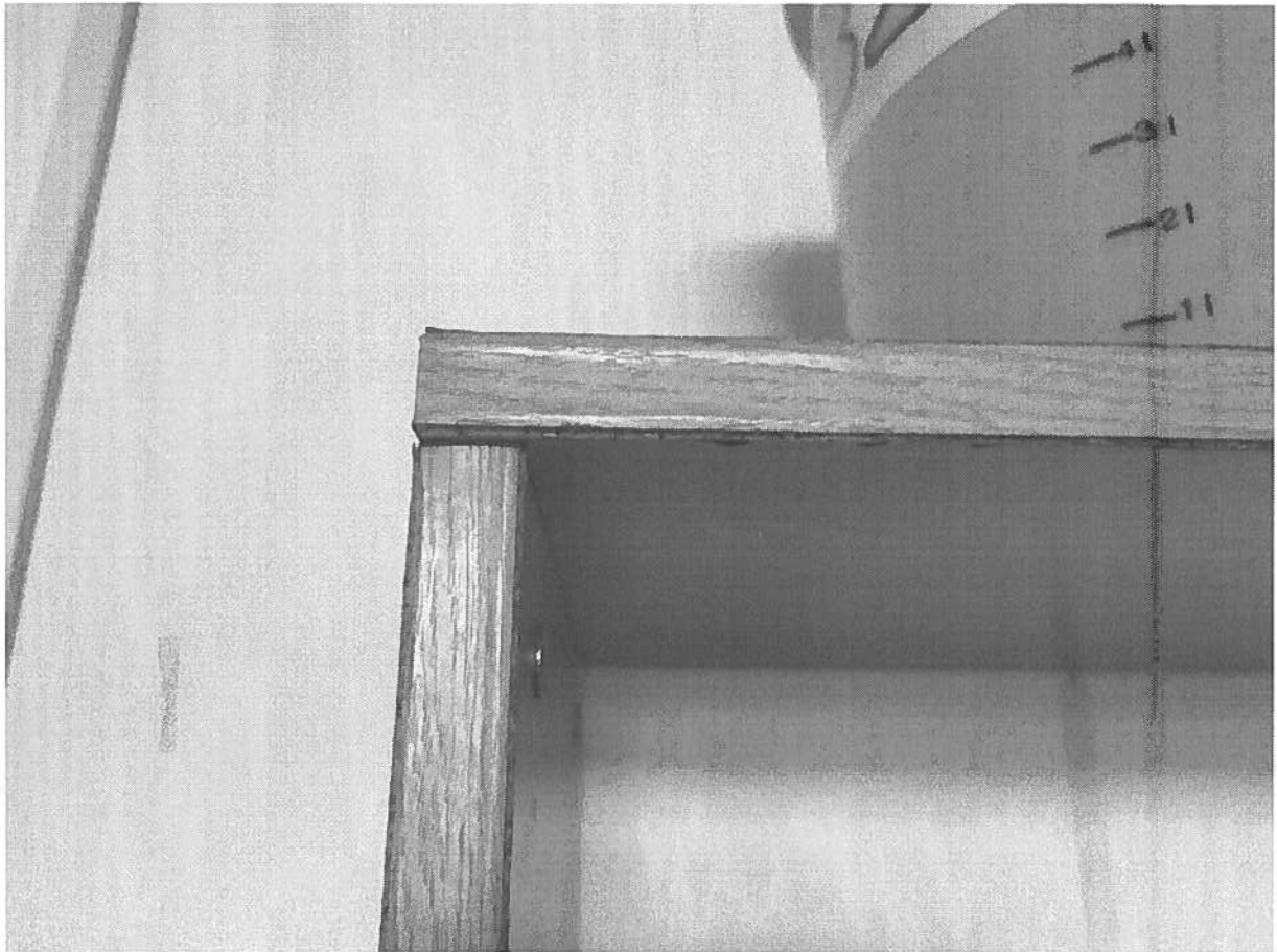
Rysunek 33. Sala ST131. Uszkodzona od wody szafa.
