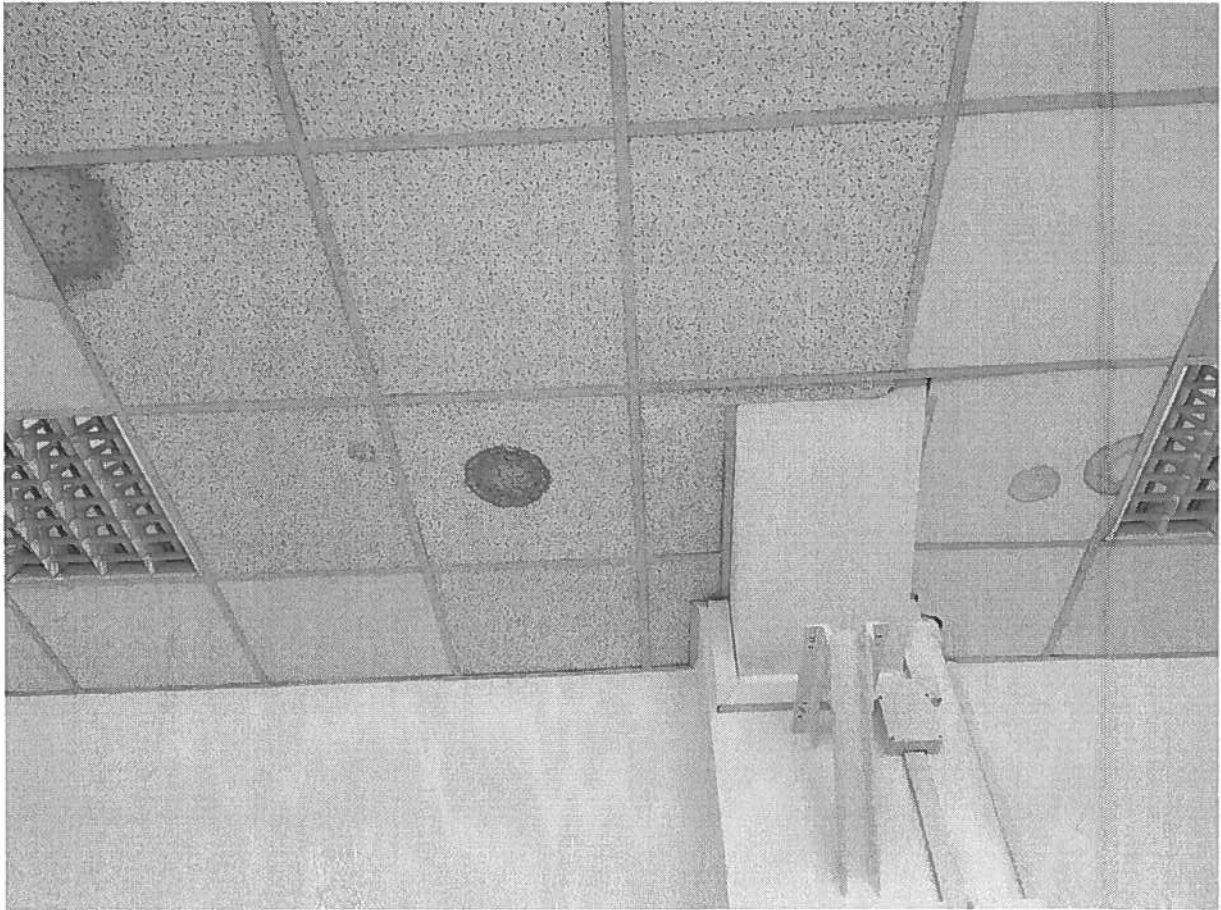
Rysunek 24. Sala ST133. Zacieki na suficie podwieszanym.
