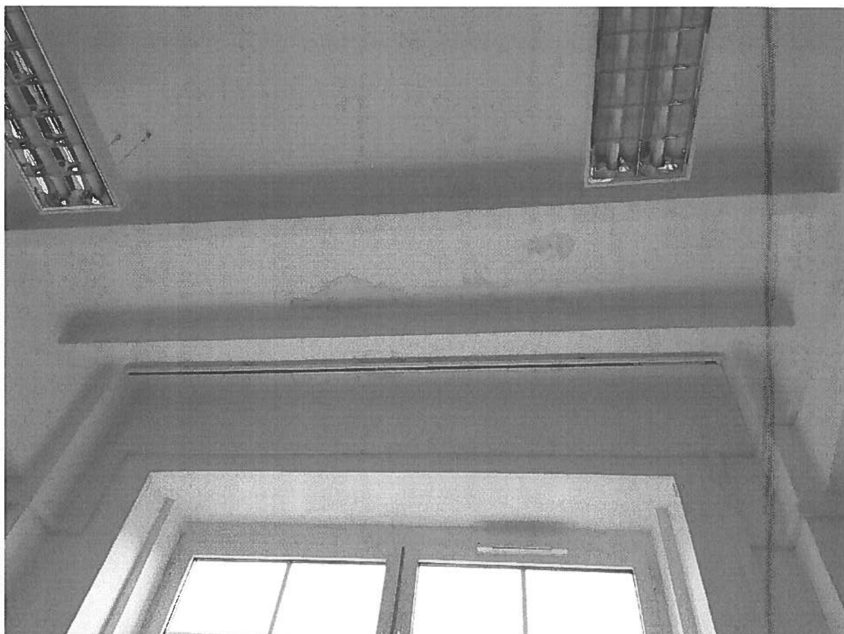
Rysunek 6. Sala ST141. Zacieki na suficie.
