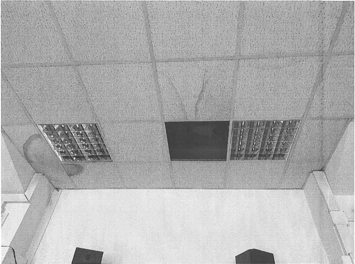
Rysunek 14. Sala ST138. Zacieki na suficie podwieszanym. Widoczne miejsce po kolejnej płycie, która rozpadła się od wody.
