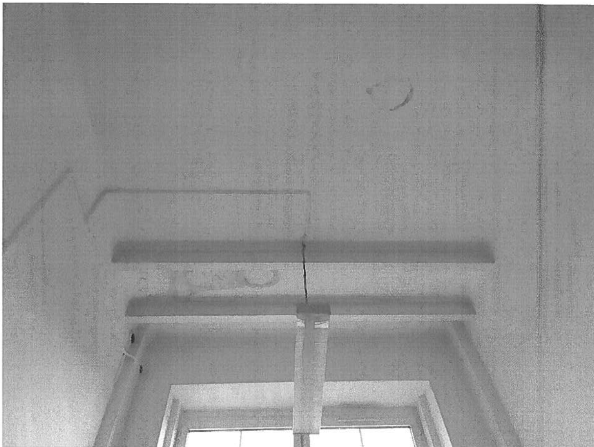
Rysunek 42. Klatka schodowa do sal ST141 i ST138. Zacieki na suficie.
