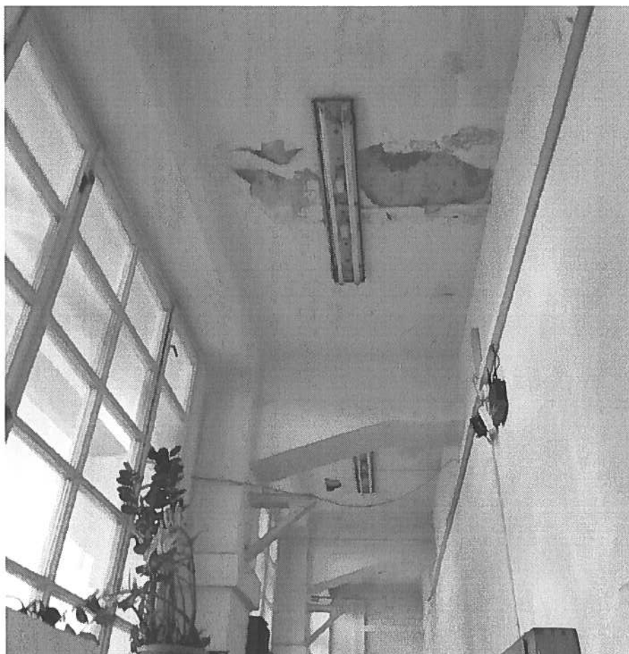
Rysunek 44. Korytarz do pokoi ST129, 130, 131, 132. Zacieki na suficie. Odpadająca farba.
