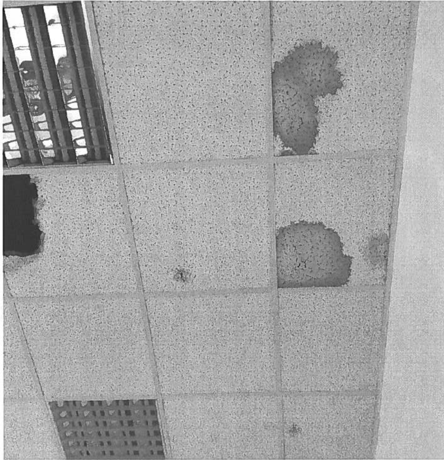
Rysunek 35. Sala ST130. Uszkodzony sufit podwieszany.
