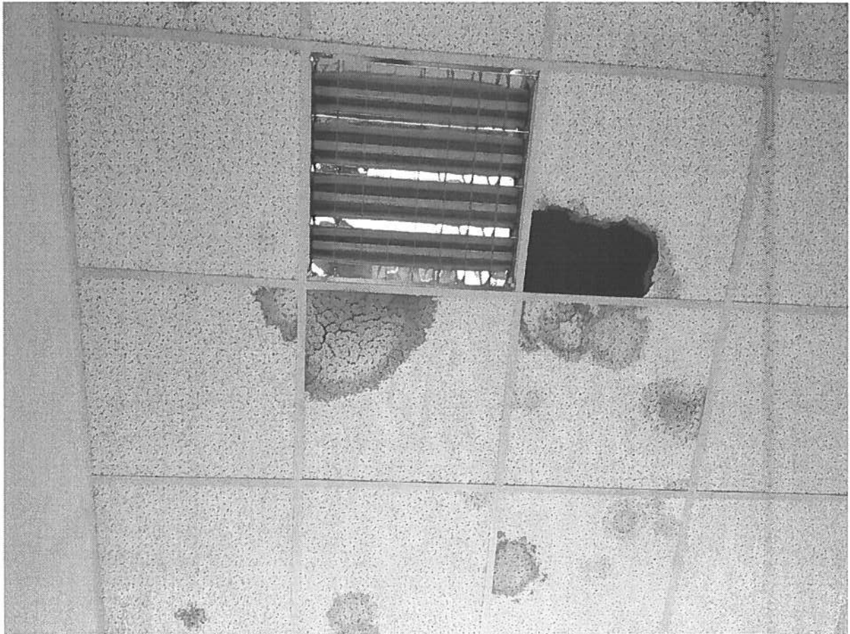
Rysunek 34. Sala ST130. Uszkodzony sufit podwieszany.
