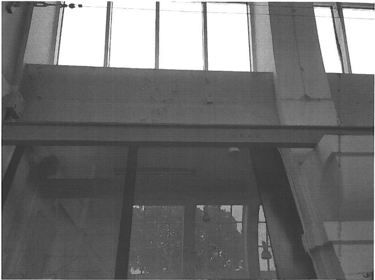
Rysunek 47. Antresola nad Halą Maszyn. Odpadająca farba nad wejściem do korytarza do sal ST129, 130, 131, 132.
