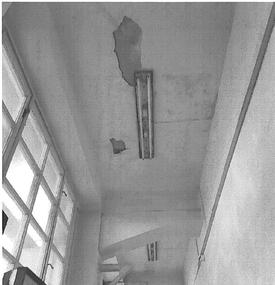
Rysunek 43. Korytarz do pokoiów ST129, 130, 131, 132. Zacieki na suficie. Odpadająca farba.
