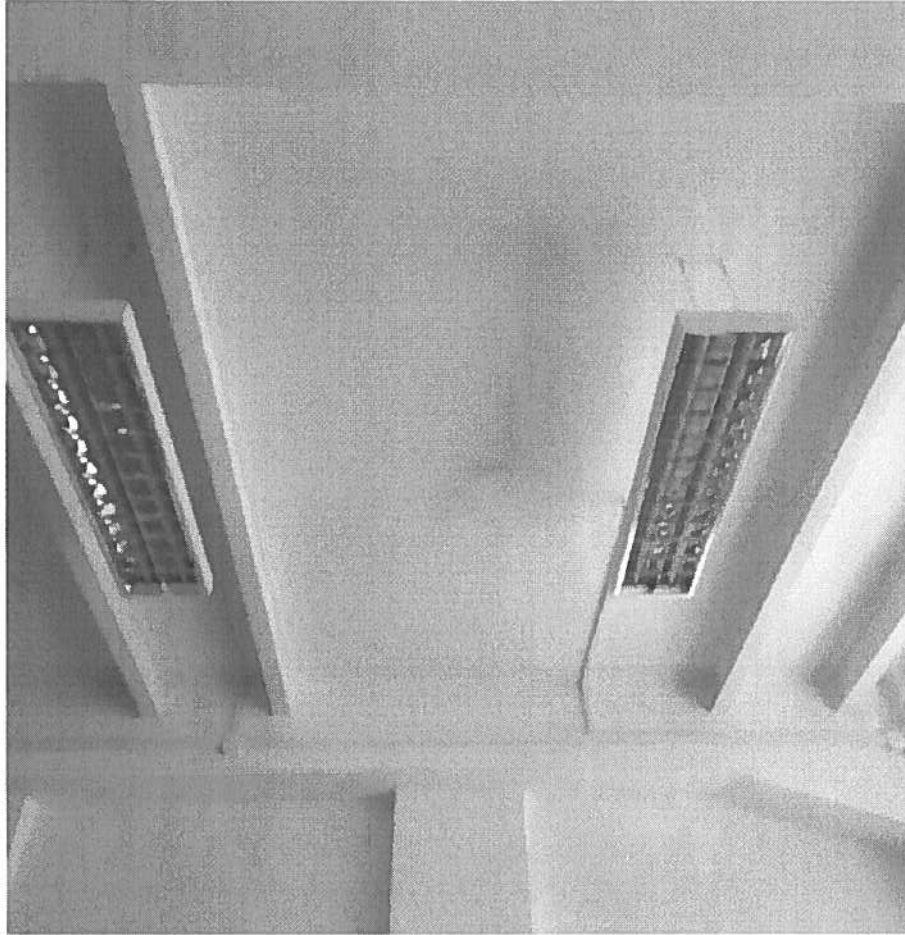
Rysunek 5. Sala ST145. Zacieki na suficie.
