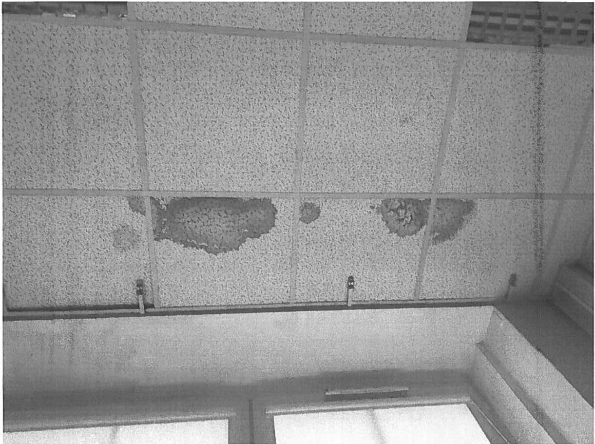
Rysunek 37. Sala ST130. Uszkodzony sufit podwieszany.
