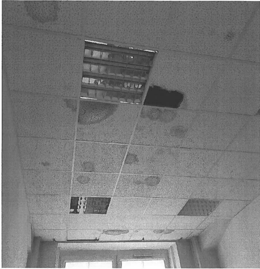
Rysunek 36. Sala ST130. Uszkodzony sufit podwieszany.
