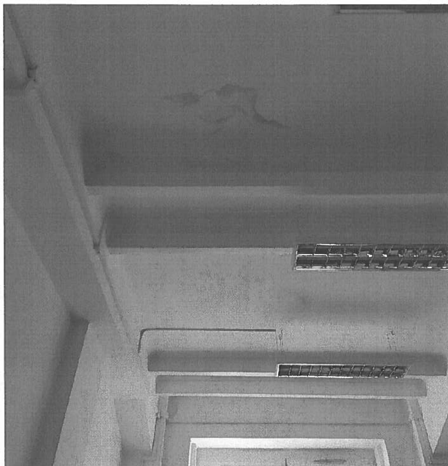
Rysunek 1. Sala ST145 - zacieki na suficie niedawno remontowanej sali.
