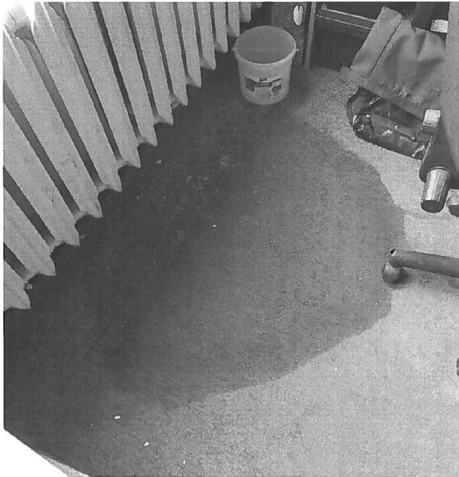
Rysunek 29. Rysunek 28. Sala ST131. Plama wody na wykładzinie. Woda kapiała bezpośrednio z sufitu tworząc kałużę.
