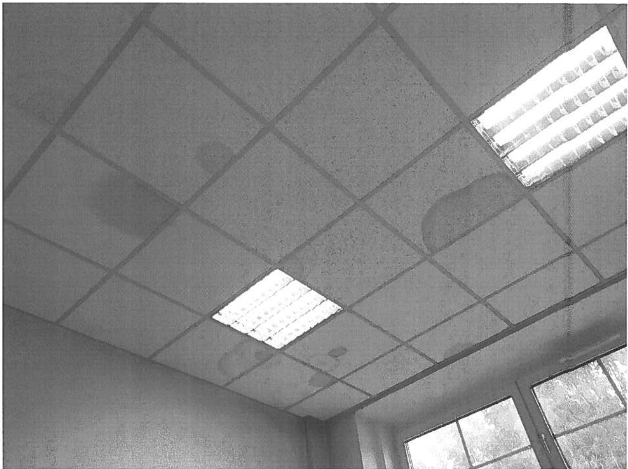
Rysunek 38. Sala ST129. Zacieki na suficie podwieszanym.
