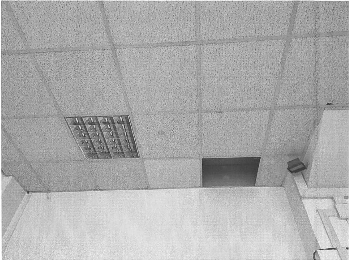
Rysunek 13. Sala ST138. Zacieki na suficie podwieszanym. Widoczne miejsce po płycie, która rozpadła się od wody.
