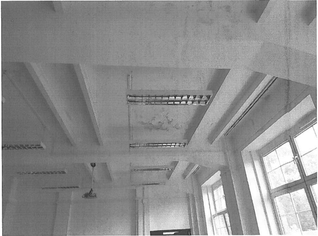
Rysunek 9. Sala ST141. Zacieki na suficie. Odpadająca farba.
