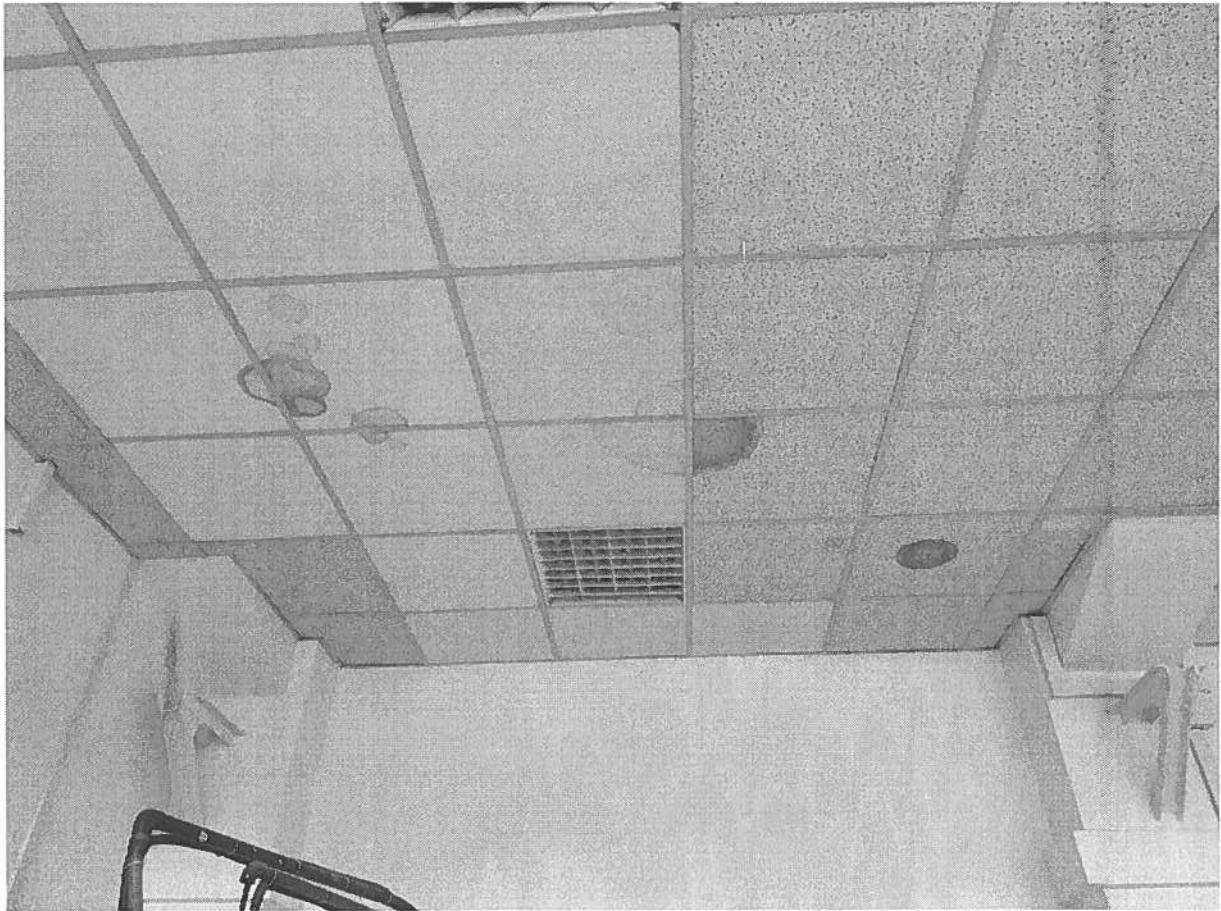
Rysunek 25. Sala ST133. Zacieki na suficie podwieszanym.
