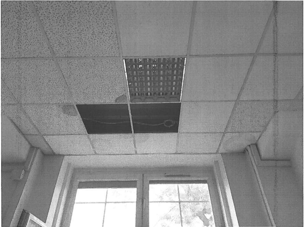
Rysunek 20. Sala ST133. Zacieki na suficie podwieszanym. Miejsca po płytach, które rozpadły się od wody.
