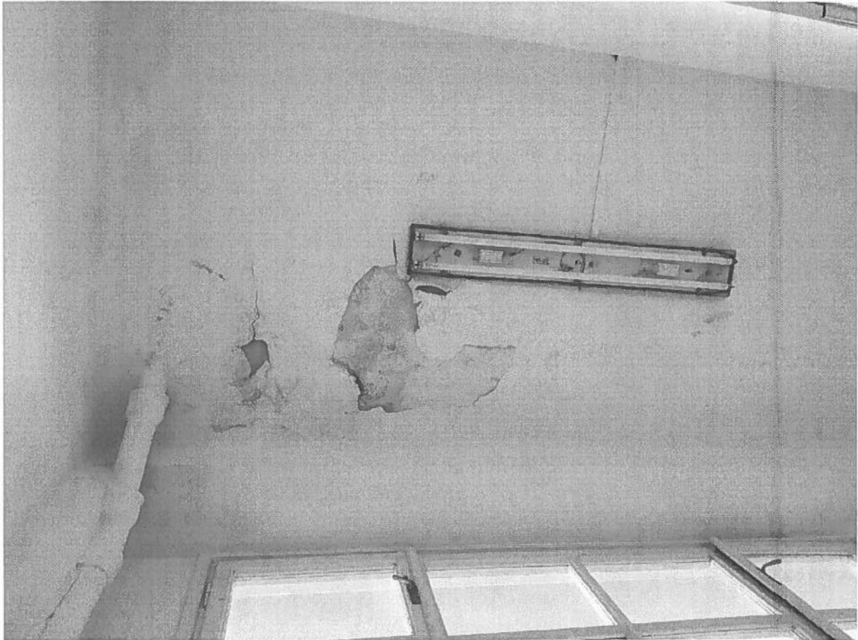
Rysunek 45. Korytarz do pokoiów ST129, 130, 131, 132. Zacieki na suficie. Odpadająca farba.
