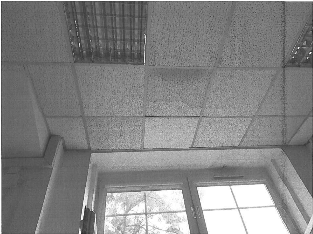
Rysunek 17. Sala ST138. Zacieki na suficie podwieszanym.
