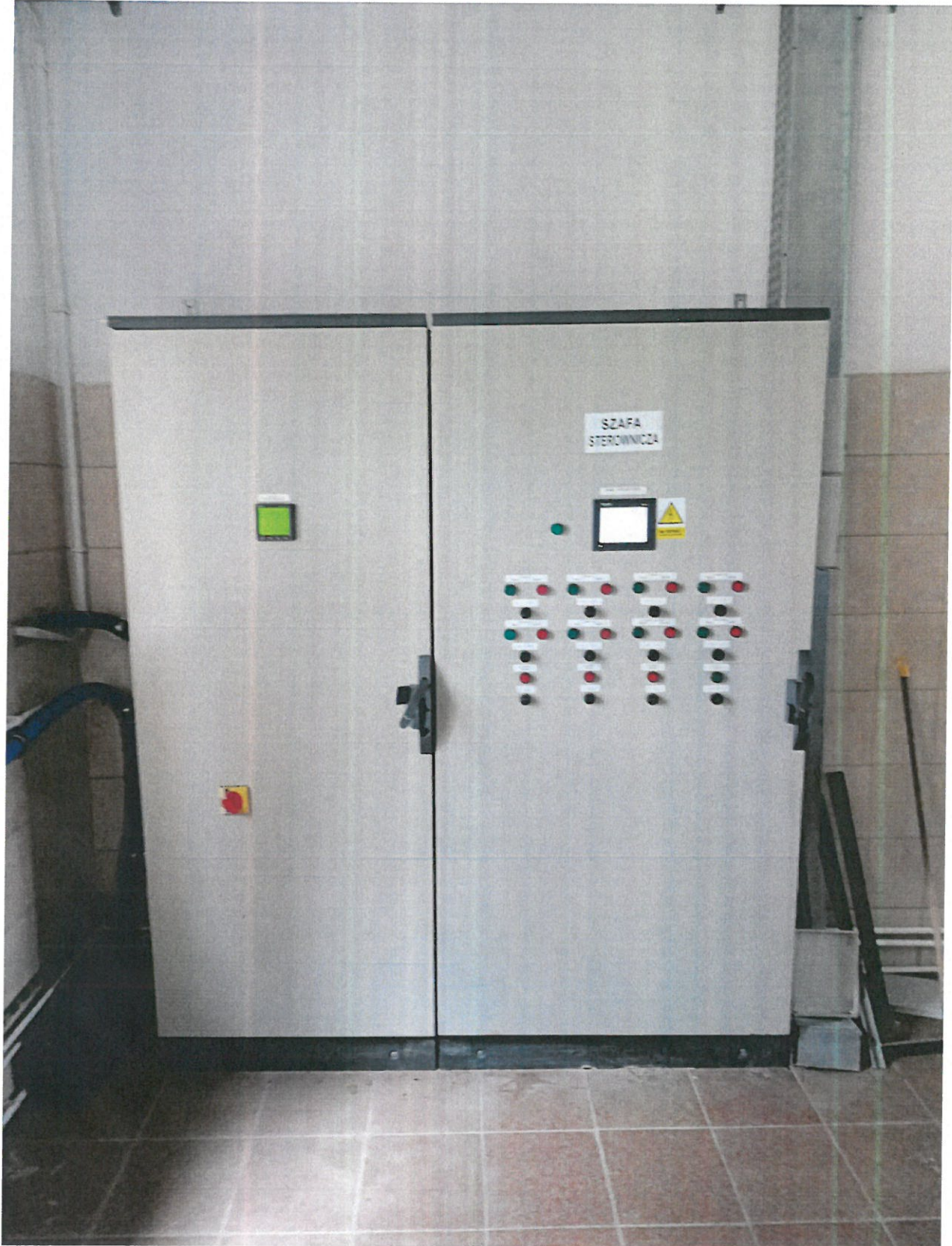
Zdjęcie nr 7- szafa sterownicza
