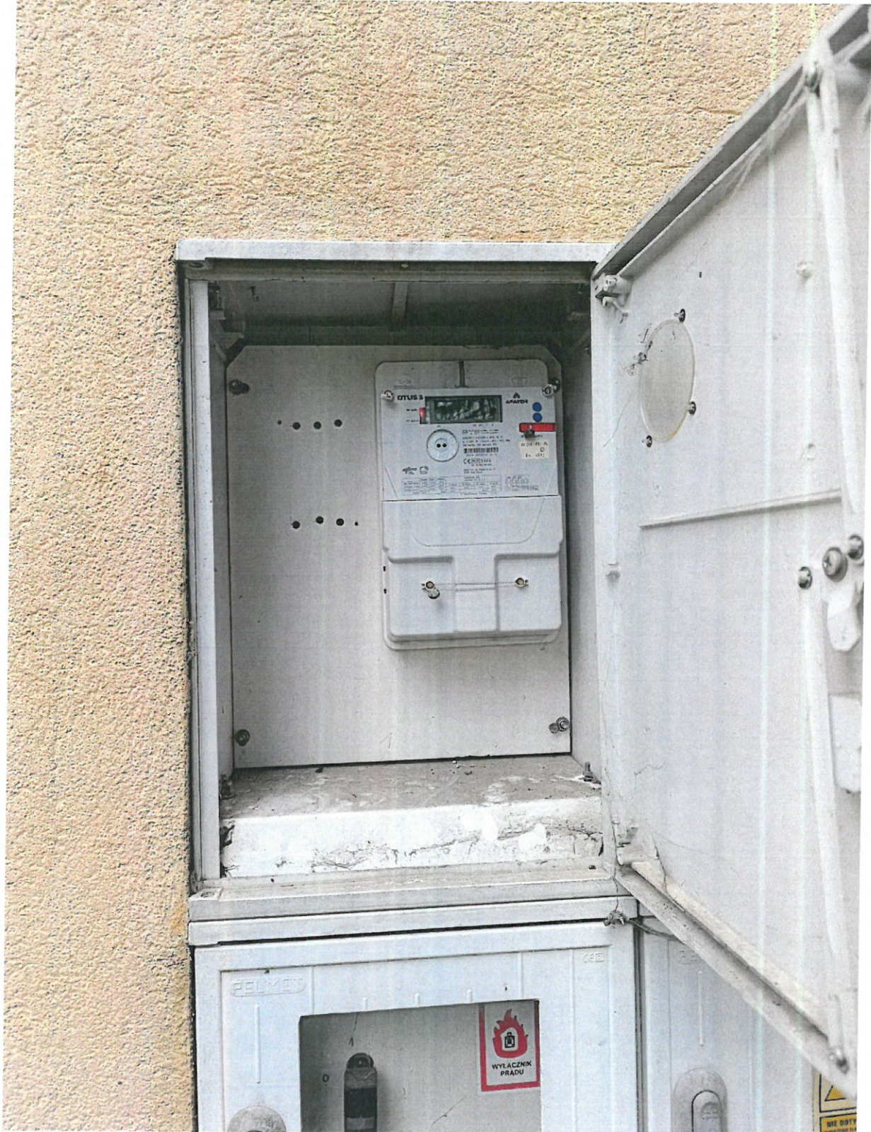
Zdjęcie nr 5- układ pomiarowy instalacji 36,00 kW
