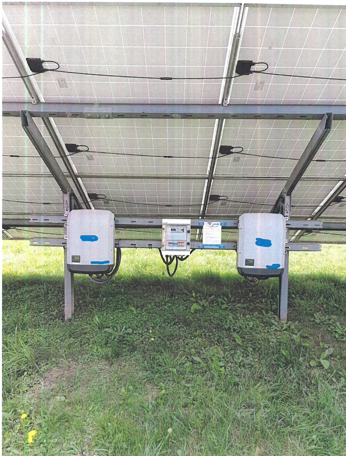
Zdjęcie nr 3- przykładowy montaż inwerterów i zabezpieczeń
