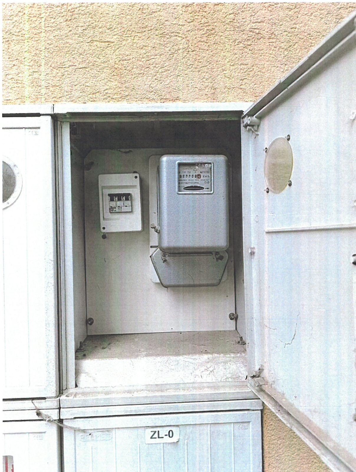
Zdjęcie nr 6- układ pomiarowy instalacji 14,00 kW- do zmiany
