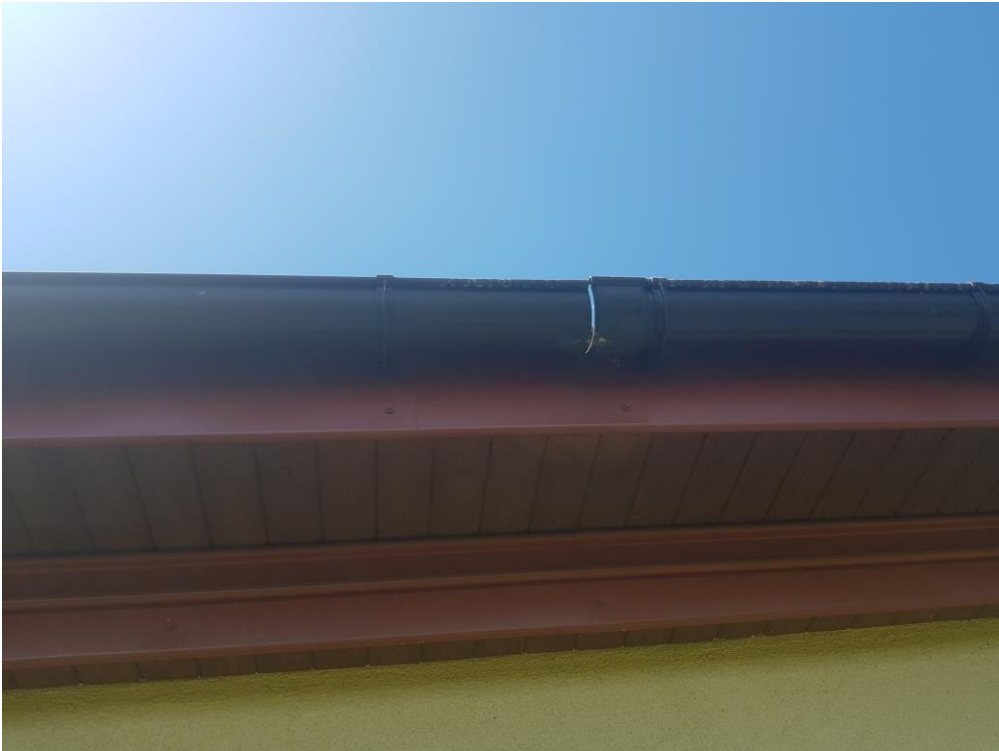
Zdjęcie 2 – Rynny – ubytki i nieszczelności.
