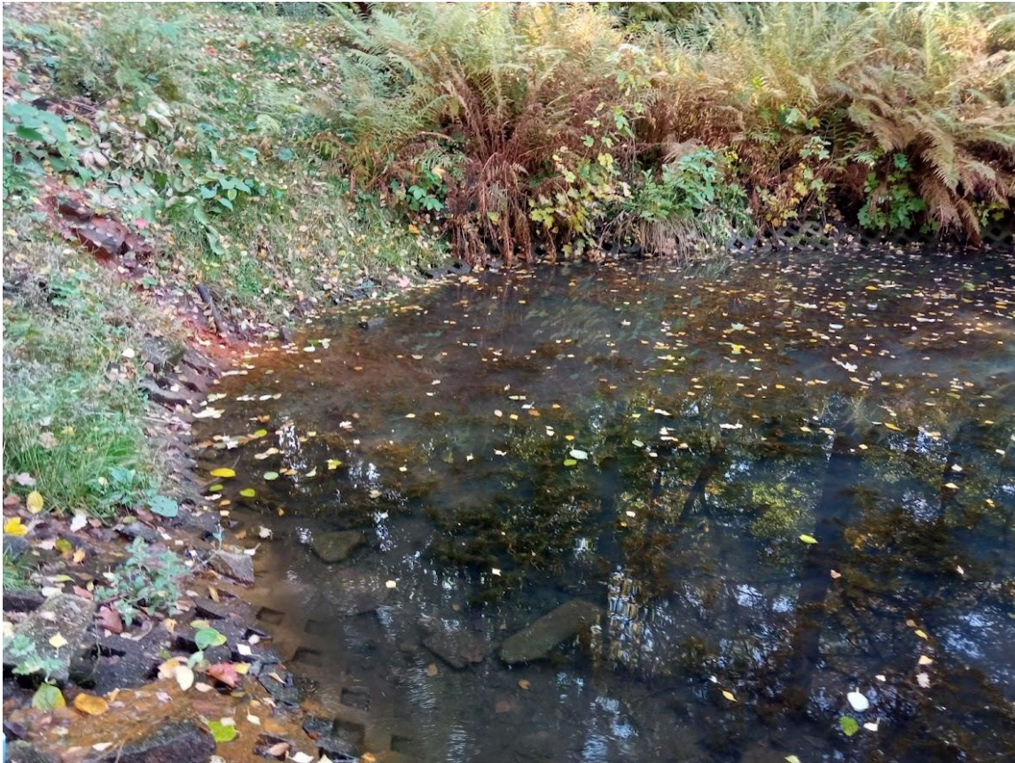
Fot. 5 Betonowe płyty na brzegach stawu [fot. własna]
