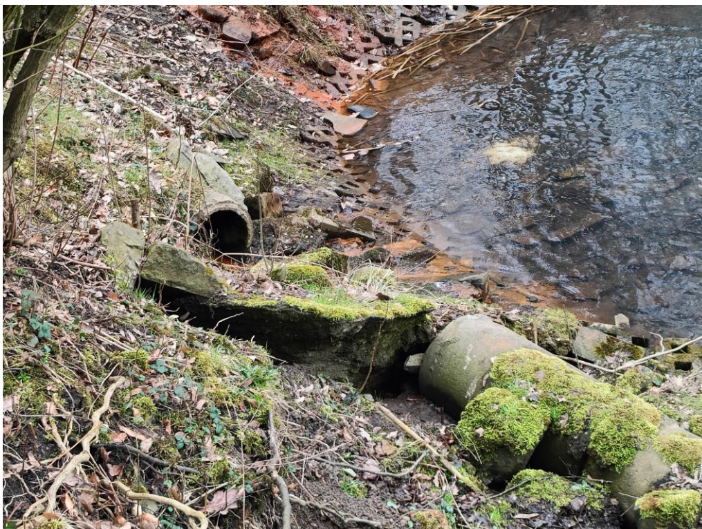
Fot. 8 Betonowa rura do naprawy i uszczelnienia.
