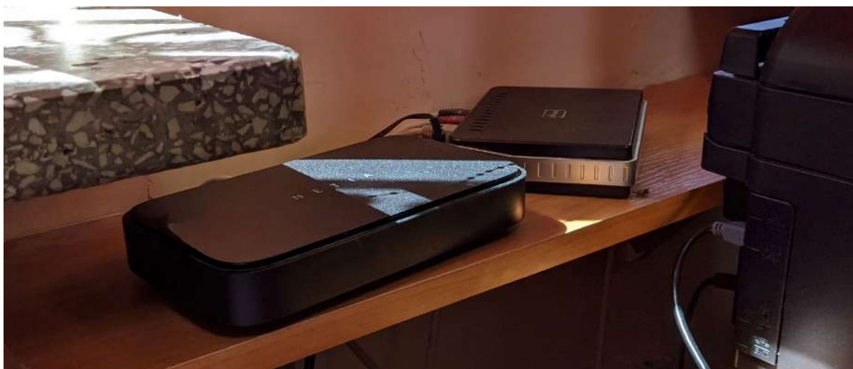
Rysunek 11: Modem operatora w części administracyjnej
