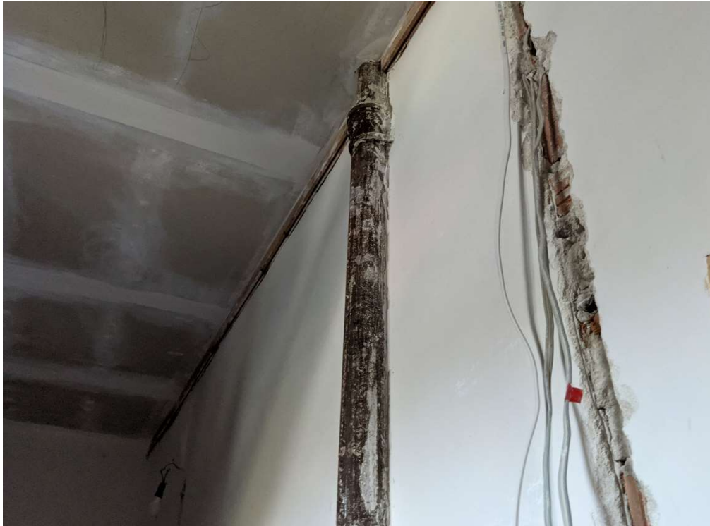
Rysunek 8: Obecne okablowanie w części pałacowej w Parsowie zostało wkute w ściany
