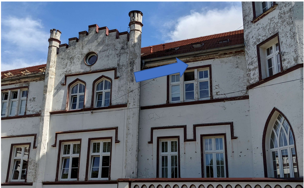
Rysunek 54: Miejsce instalacji access pointa
