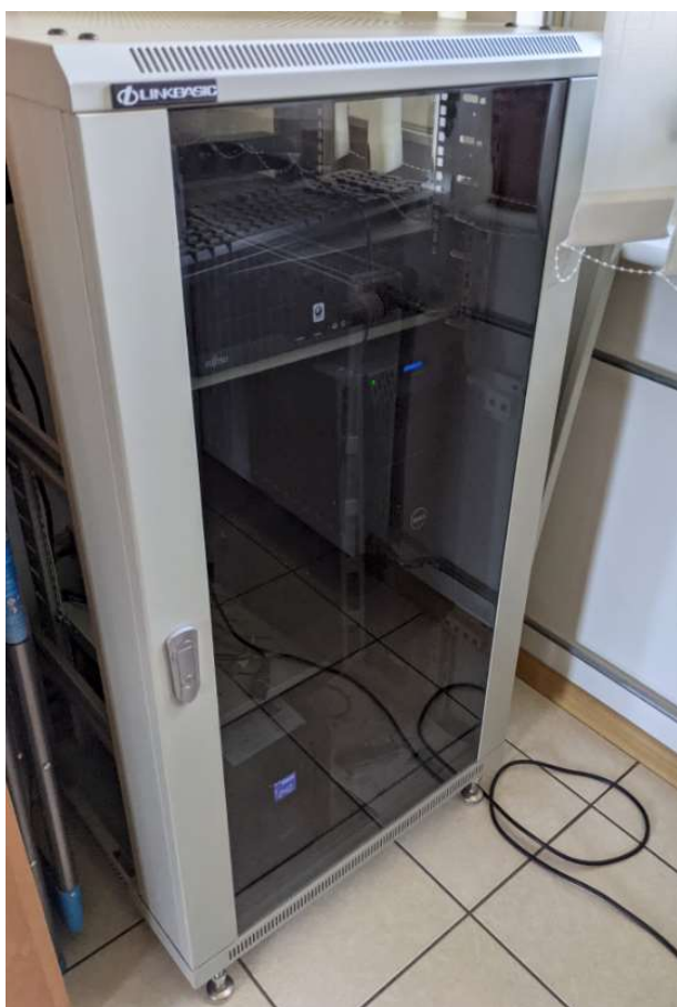
Rysunek 9: Szafa z monitoringiem
