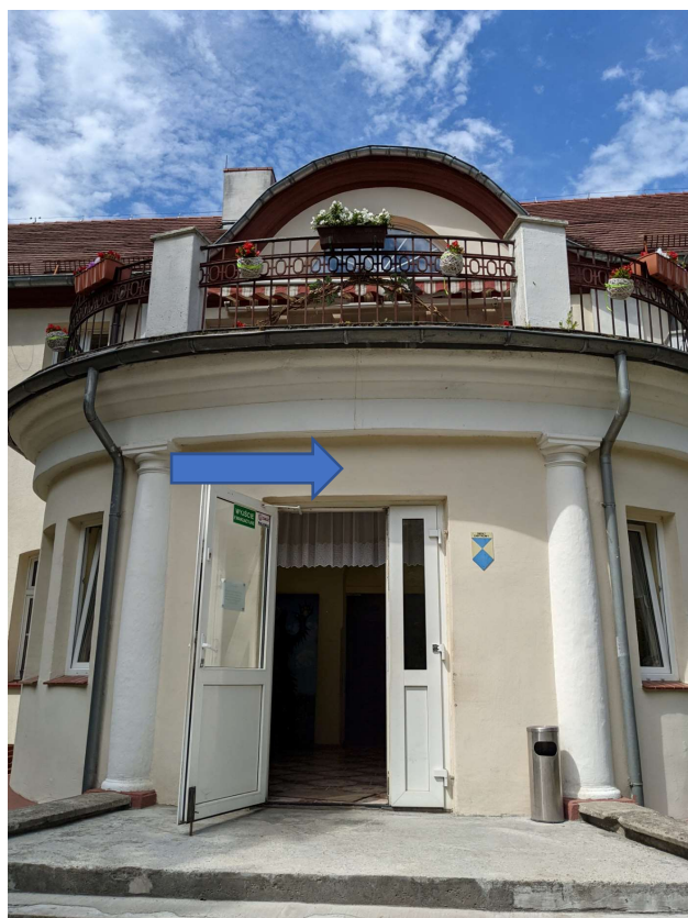
Rysunek 49: Miejsce instalacji na elewacji pałacu
