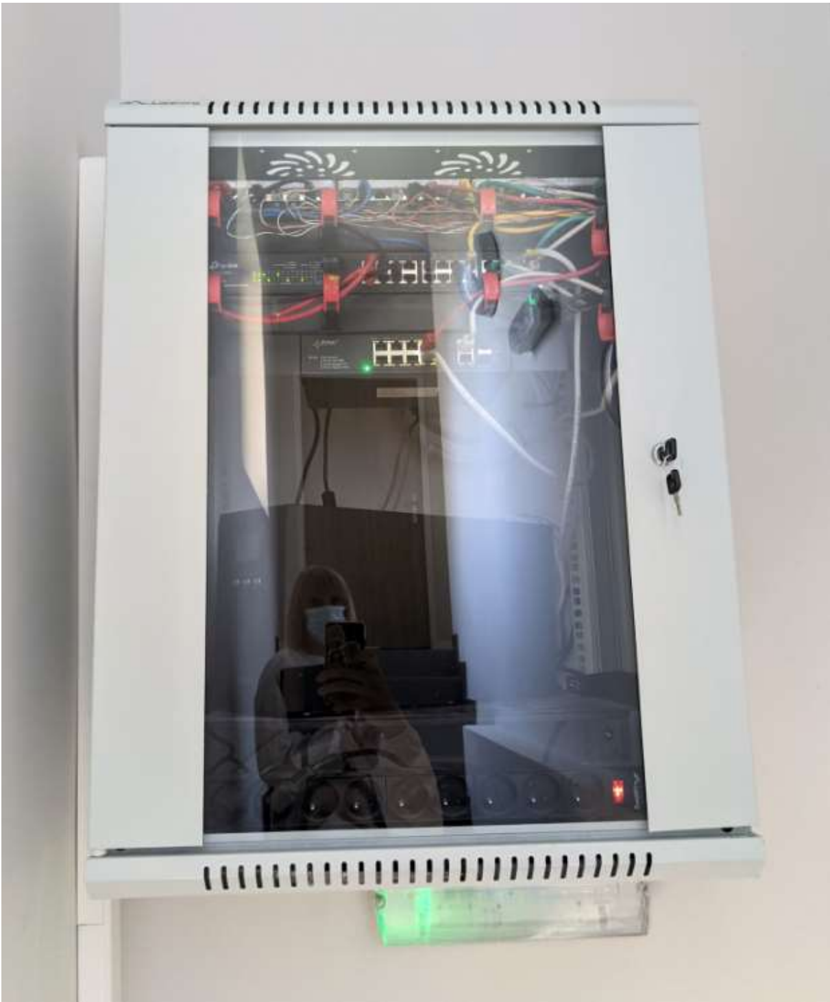
Rysunek 8: Szafa rack w budynku administracji.
