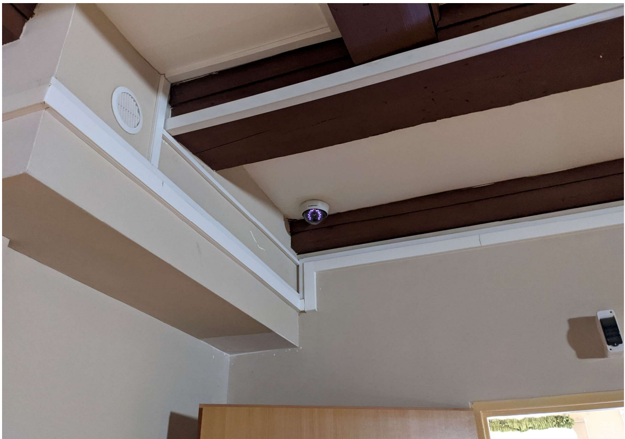
Rysunek 51: Na pierwszym piętrze okablowanie powinno iść w korytach stykających się z istniejącą infrastrukturą
