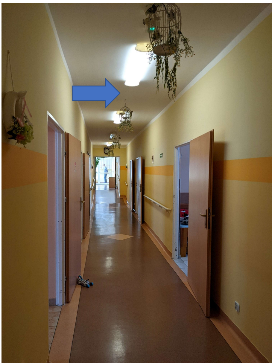
Rysunek 55: Instalacja punktów dostępowych pod sufitem na korytarzach
