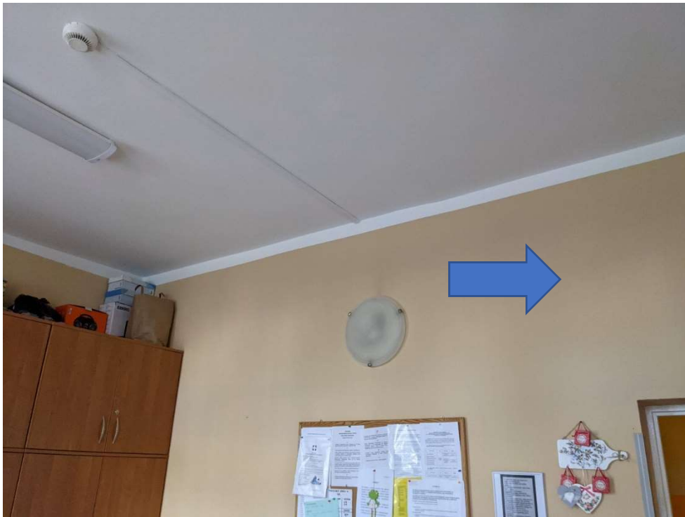
Rysunek 52: Miejsce instalacji szafy rack w pomieszczeniu socjalnym na parterze
