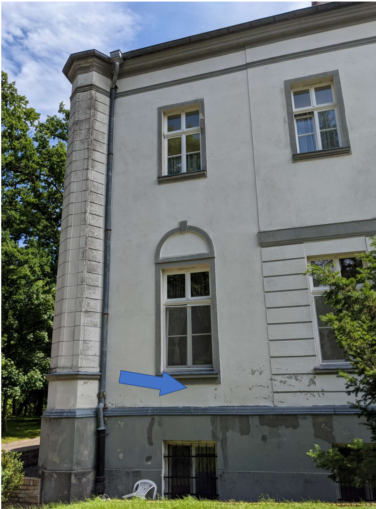
Rysunek 61: Możliwe do instalacji urządzenie pod oknem pod szarym pasem, zlicowane do elewacji, okablowanie do PD na parterze
