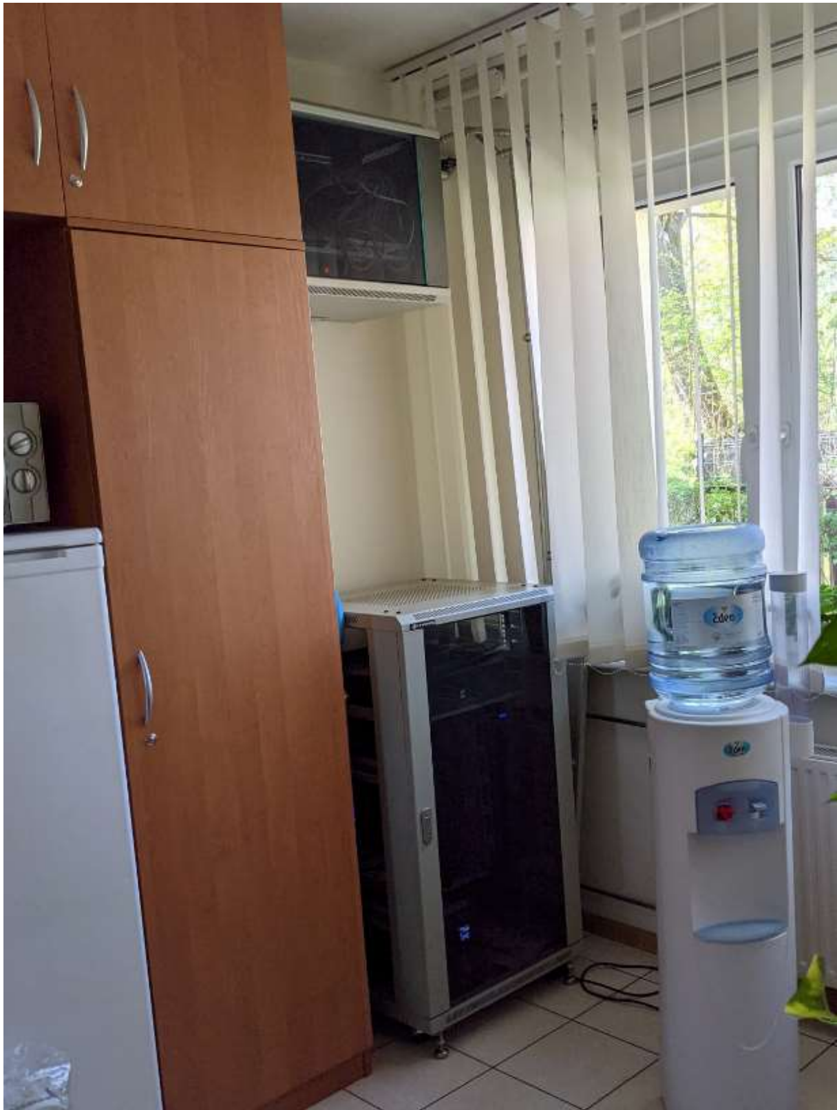
Rysunek 7: Serwerownia w budynku administracyjnym, szafa górna to LAN, a dolna to monitoring
