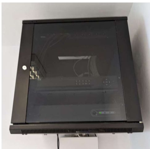
Rysunek 6: Szafa od monitoringu na poziomie niskiego parteru
