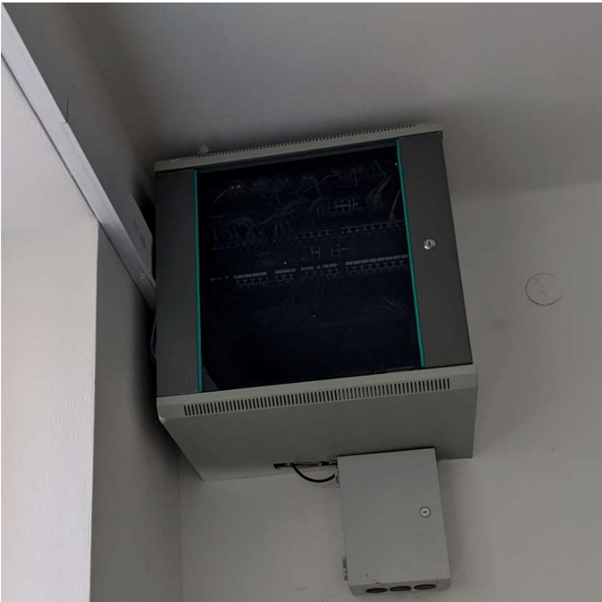
Rysunek 7: Szafa rack na klatce schodowej pomiędzy parterem, a pierwszym piętrzem
