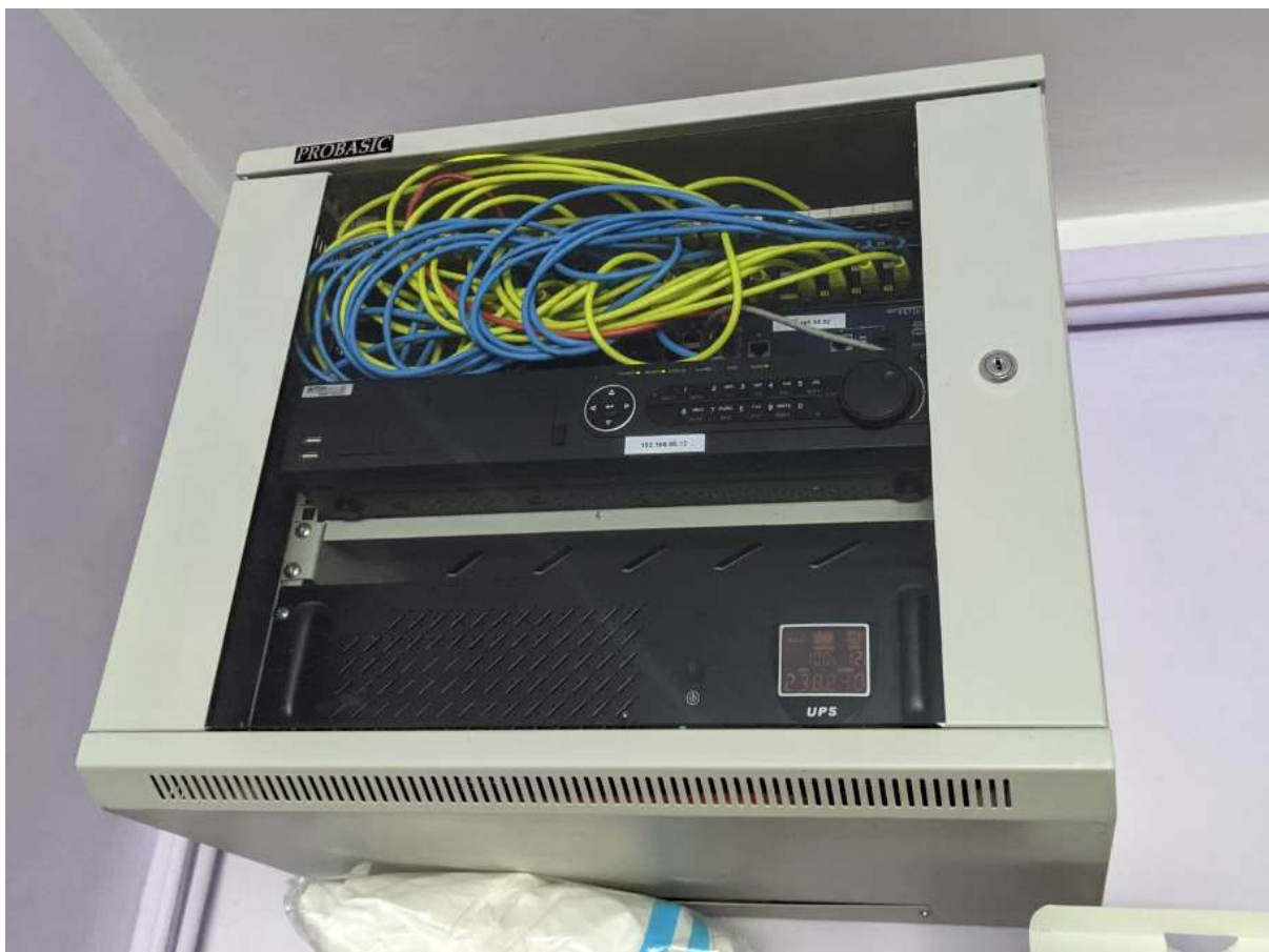
Rysunek 10: Szafa rack monitoringu
