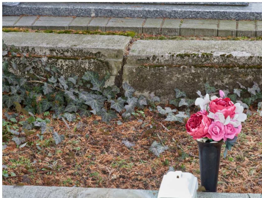
Fot. nr 5. Pęknięcia ogrodzenia z przemieszczeniem
