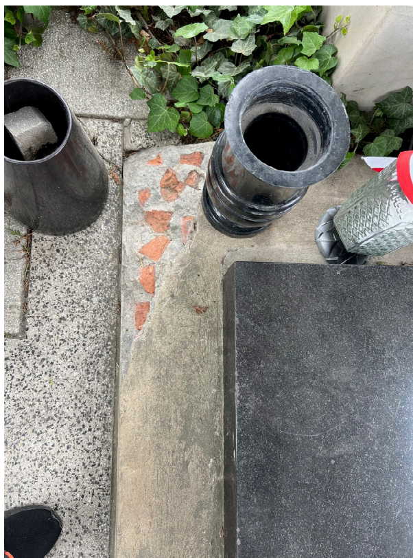
Fot. n r6. Uszkodzony narożnik ceglany
