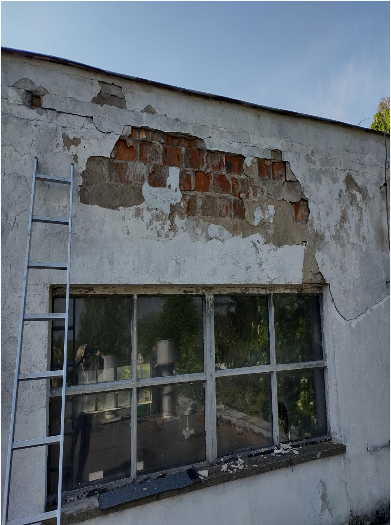
FRAGMENT ELEWACJI DO NAPRAWY
