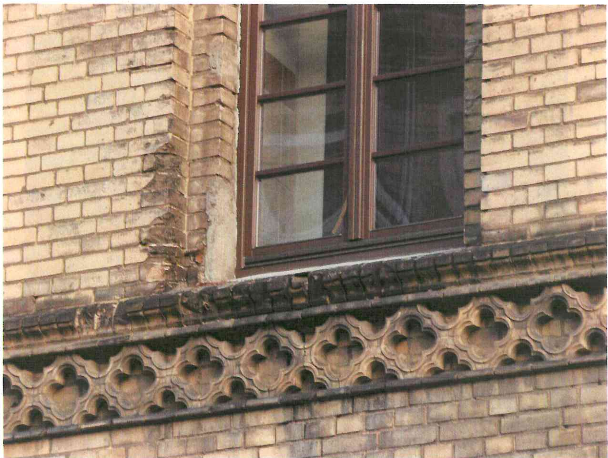
fot.61 Zniszczenia fryzu i ościeży okiennych.
