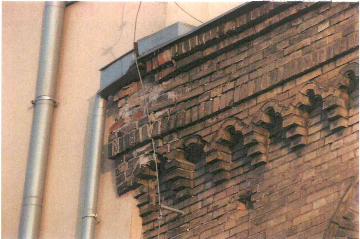
fot.60 Uszkodzenia gzymsu na styku z budynkiem Urzędu Skarbowego.
