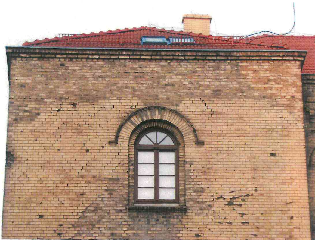
fot.23 Nieestetyczne, powojenne uzupełnienia murów w obrębie górnych partii ścian ryzalitu zachodniego z zakończeniem prostym gzymszem i dachem - bez rekonstrukcji pierwotnej formy.
