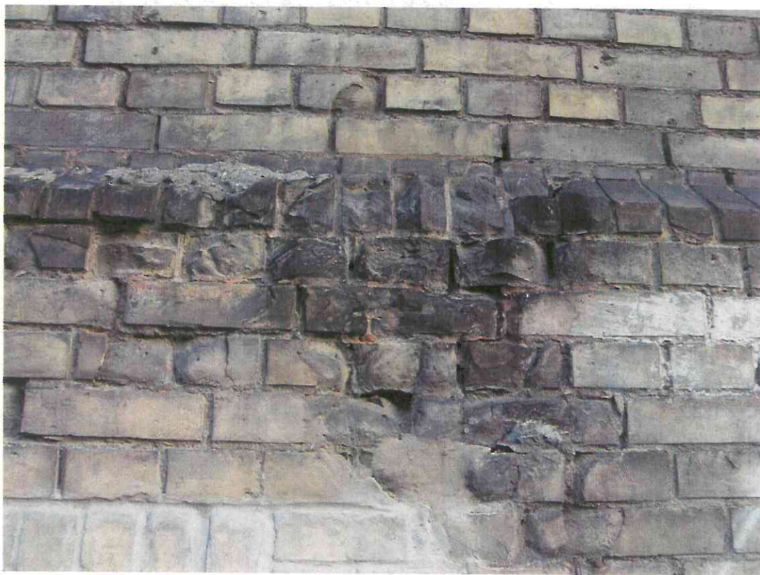
fot.59 Zniszczenia gzymsu i lica muru w partii cokołowej.
