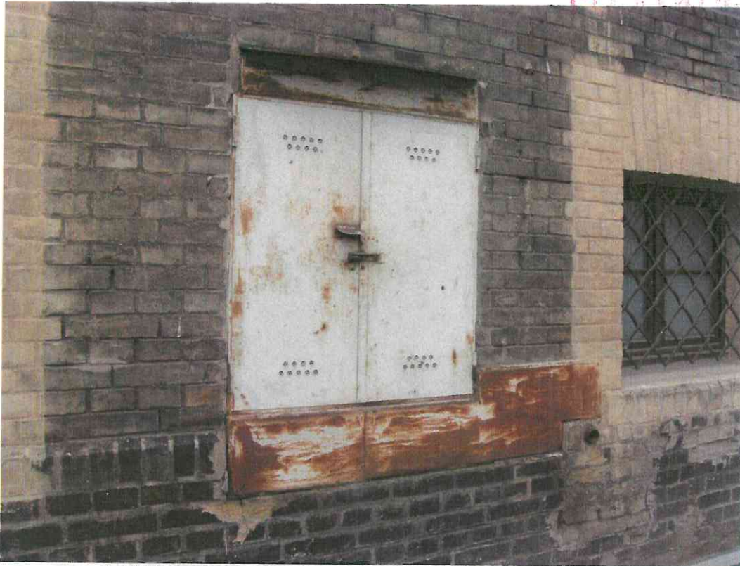
fot.49 Nieestetyczna skłona dawnego przyłącza przeznaczona do wymiany.
