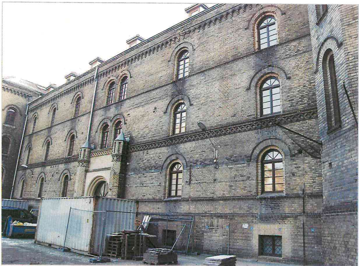
fot.28 Korpus główny, widok od zachodu, widoczne zabrudzenia i ubytki w obrębie cegieł i kształtek
