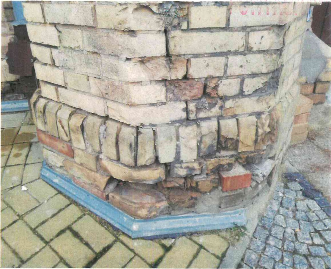
fot.14 -15 Stan zachowania cegieł i spoin w dolnej partii ościeża portalu wejścia.- strona zachodnia
