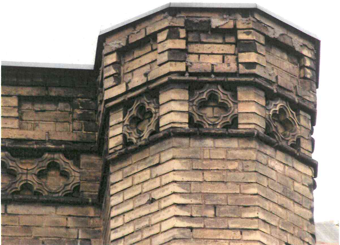
fot.10 Podstawa jednej z wieżyczek flankującej ryzalit. Widoczne zabrudzenia i zniszczenia kształtek ceramicznych.
