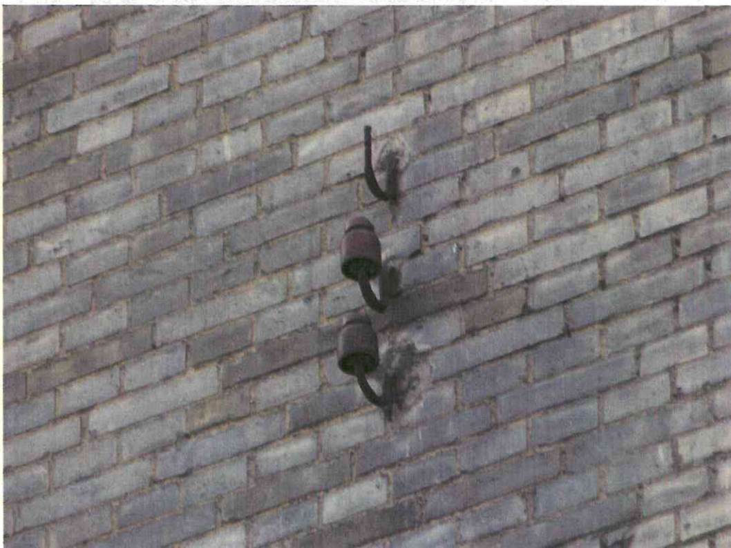
Fot.52. Pozostałości instalacji elektrycznej ( izolatory)- do konserwacji lub usunięcia
