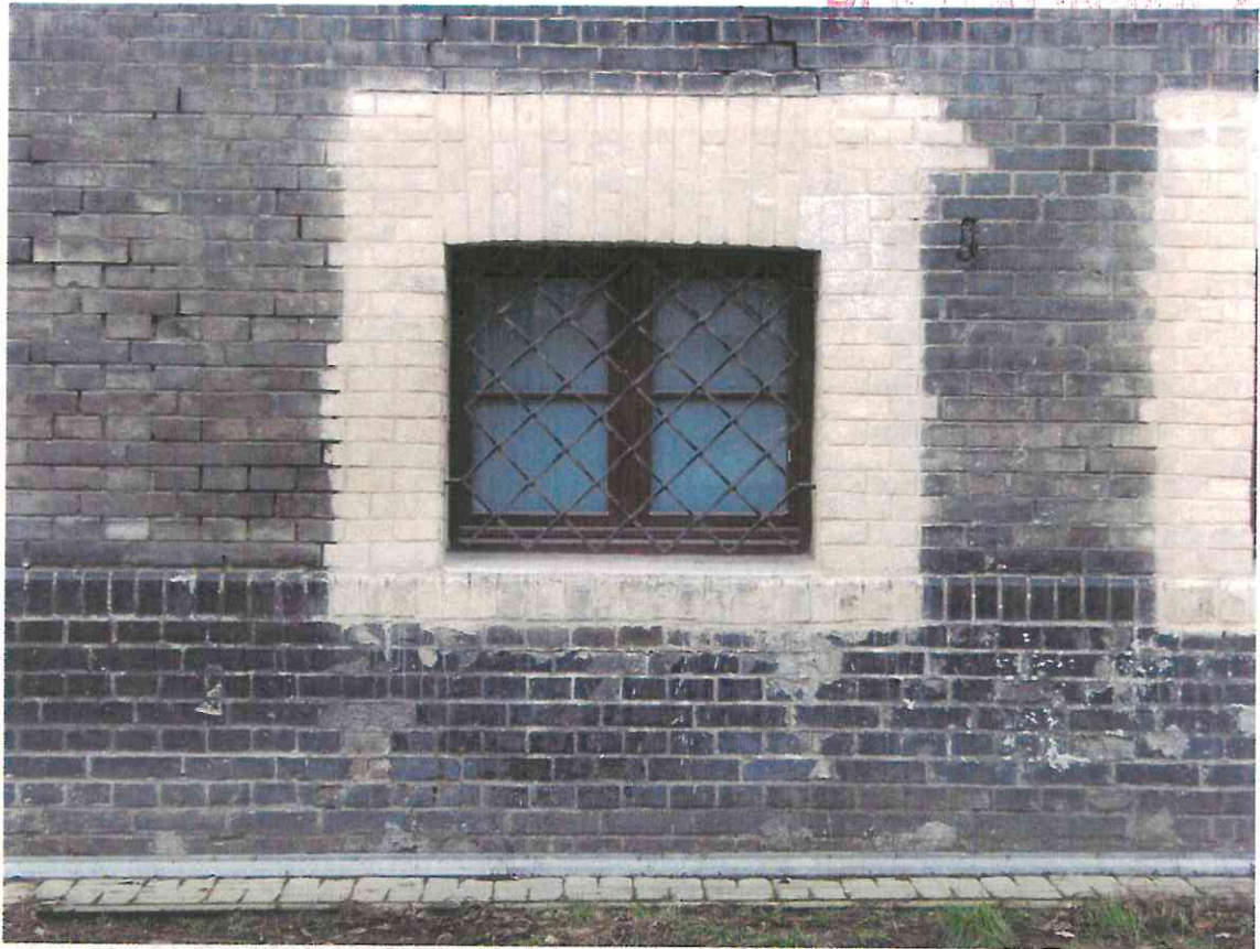
fot.42 Okna w strefie cokołowej, z wtórnym okratowaniem widoczne naprawy i przemalowania ościeży okien piwnicznych wykonane kilka lat temu przy okazji wymiany okien.
