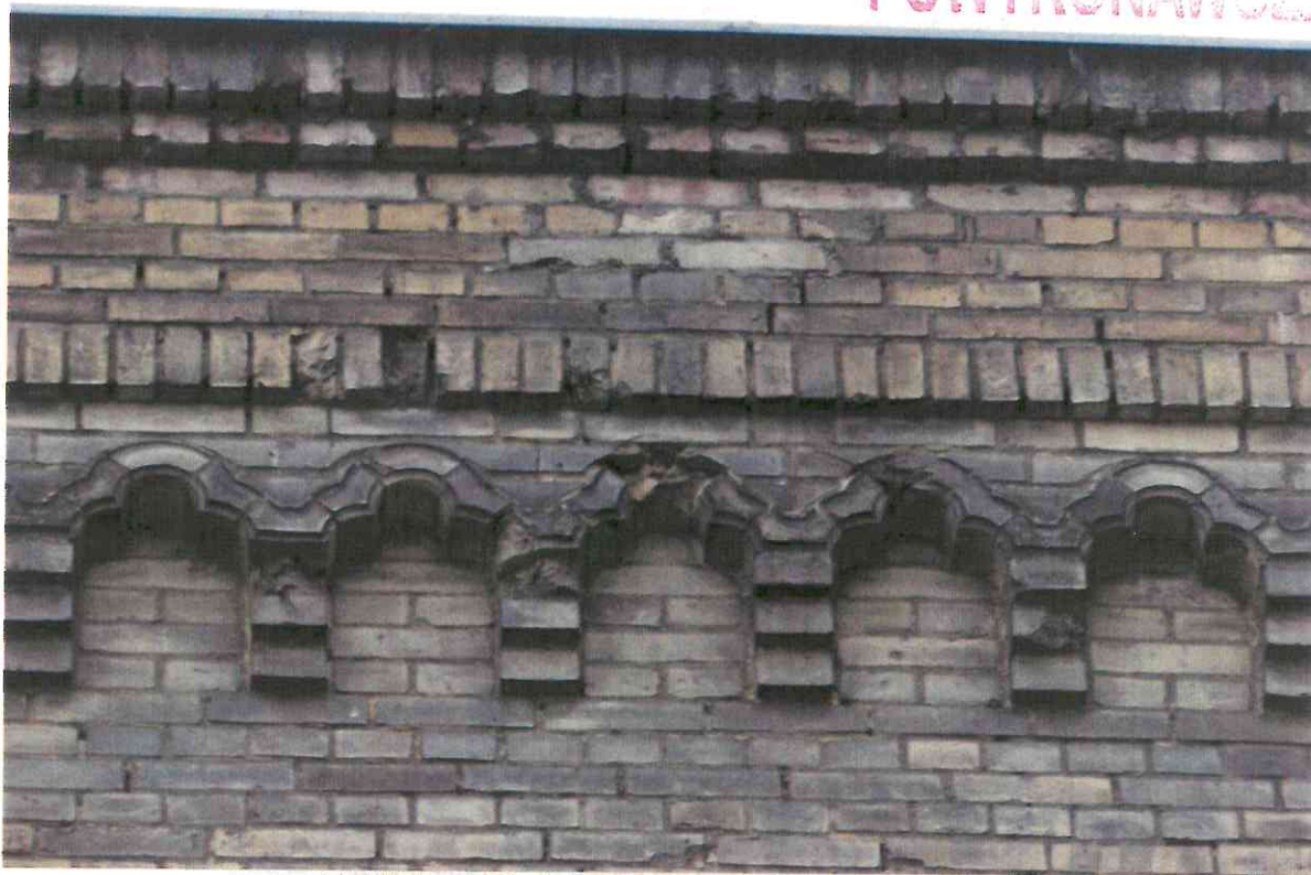
fot.47 Zabrudzenia i ubytki w partiach gzymsu wieńczącego.
