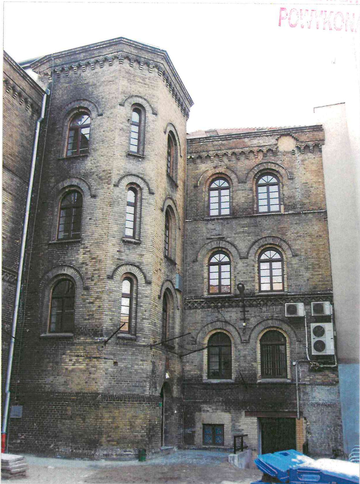
fot.29 Skrzydło zachodnie elewacji wewnętrznych – widoczne zabrudzenia ceglanego lica i kształtek, uszkodzenia mechaniczne, liczne przemurowania i duża ilość wtórnych instalacji i urządzeń szpecących zabytkowa elewację.
