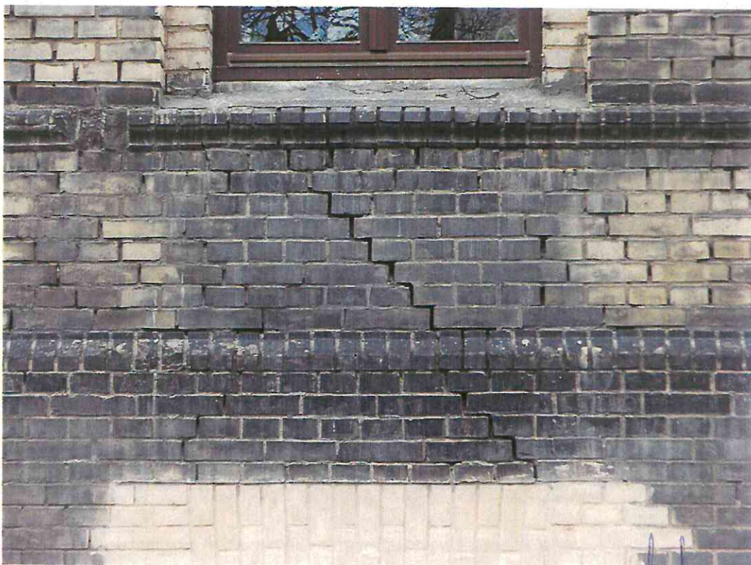
Fot.43 Spękania pomiędzy I i II kondygnacją.
