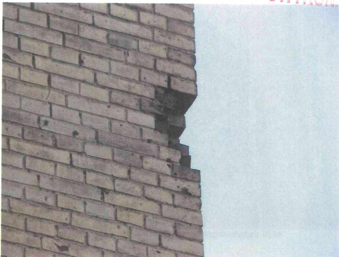
fot.58 Uszkodzony narożnik muru wieży od strony elewacji południowej.
