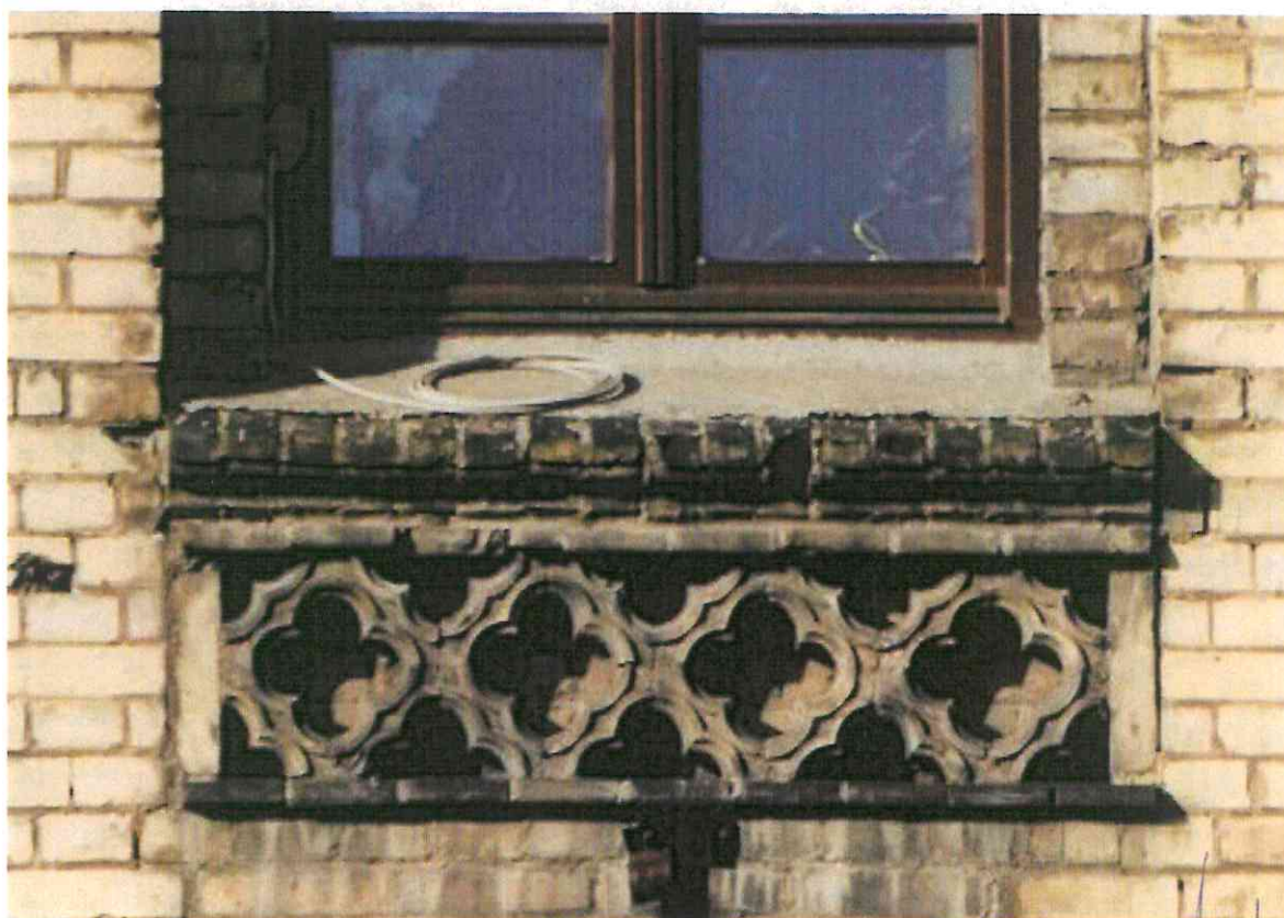
fot.21 Zabrudzenia i ubytki w obrębie fryzu podparapetowego - okno II kondygnacji narożnego ryzalitu
