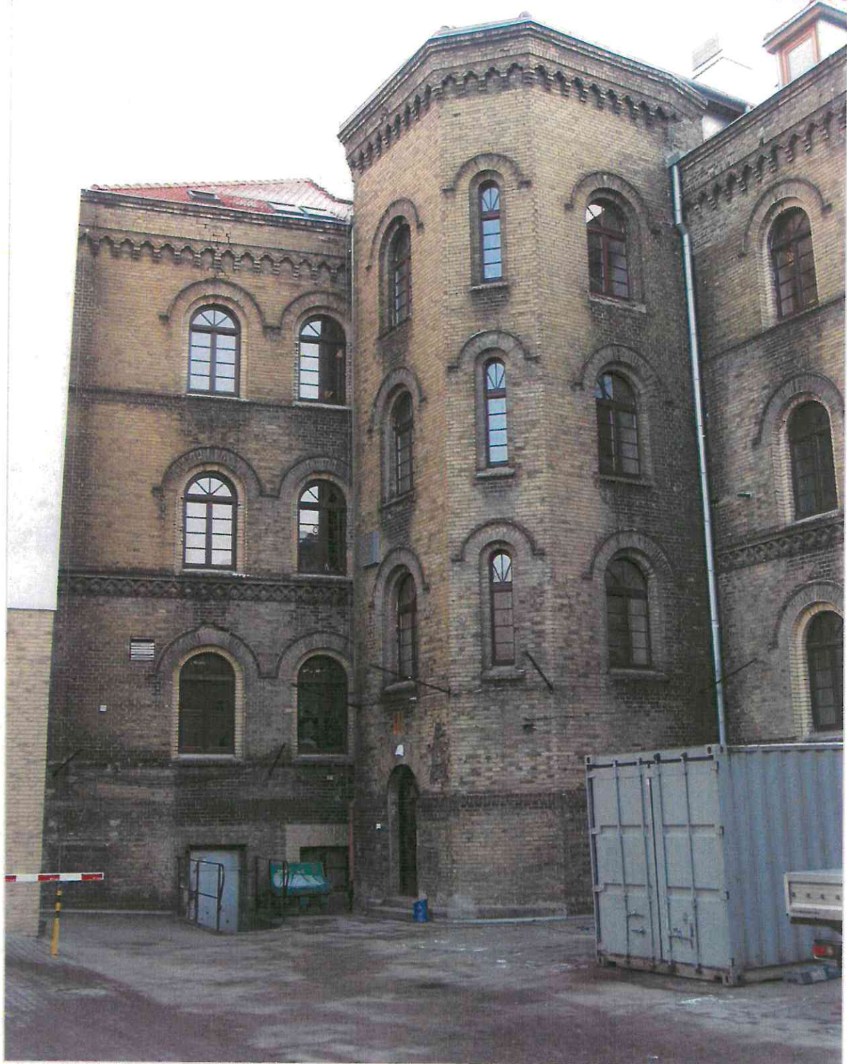
fot.34. Skrzydło wschodnie. elewacji wewnętrznych – widoczne zabrudzenia ceglanego lica i kształtek oraz ubytki i niefachowe uzupełnienia w obrębie ościeży okien
