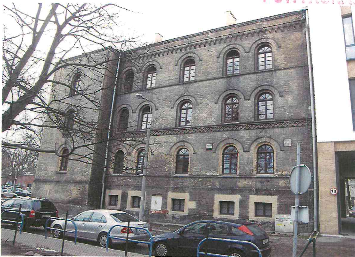
fot.39 -40 Elewacja od strony ulicy Żabi Kruk przed rozpoczęciem prac widoczne zabrudzenia elewacji, w partii przyziemia widoczne naprawy ościeży okien piwnicznych wykonane kilka lat temu przy okazji wymiany okien.
