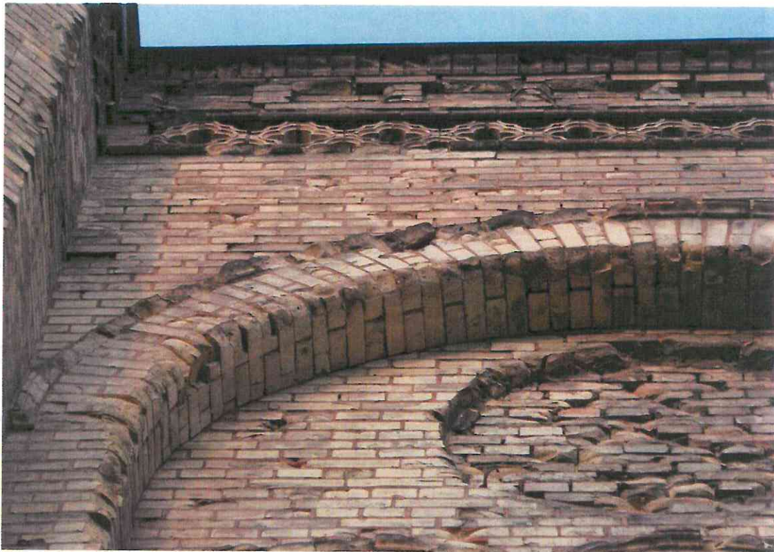
fot.11. Zniszczenia cegieł w obrębie centralnego ryzalitu
