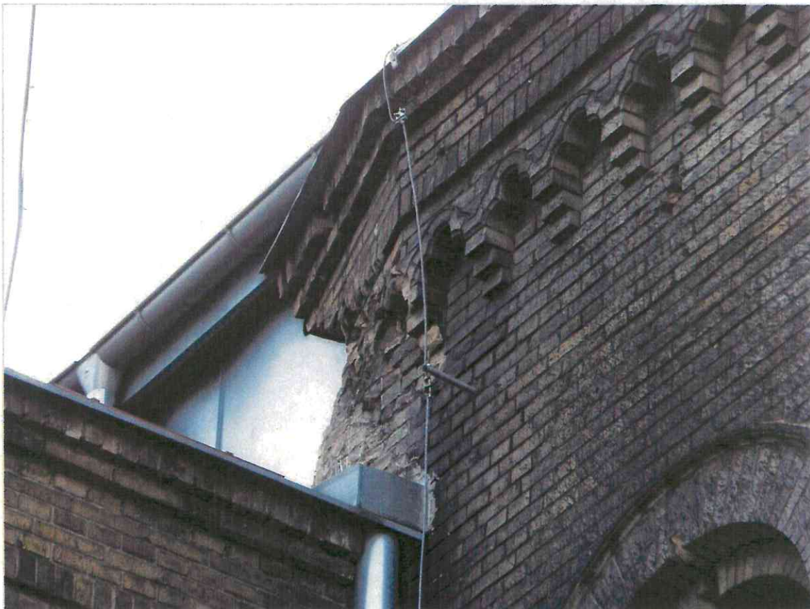
fol.31 Uszkodzenia gzymsu wieńczącego ryzalit zachodniej klatki schodowej oraz zabrudzenia elewacji substancją bitumiczną – smołą lub lepikiem.
