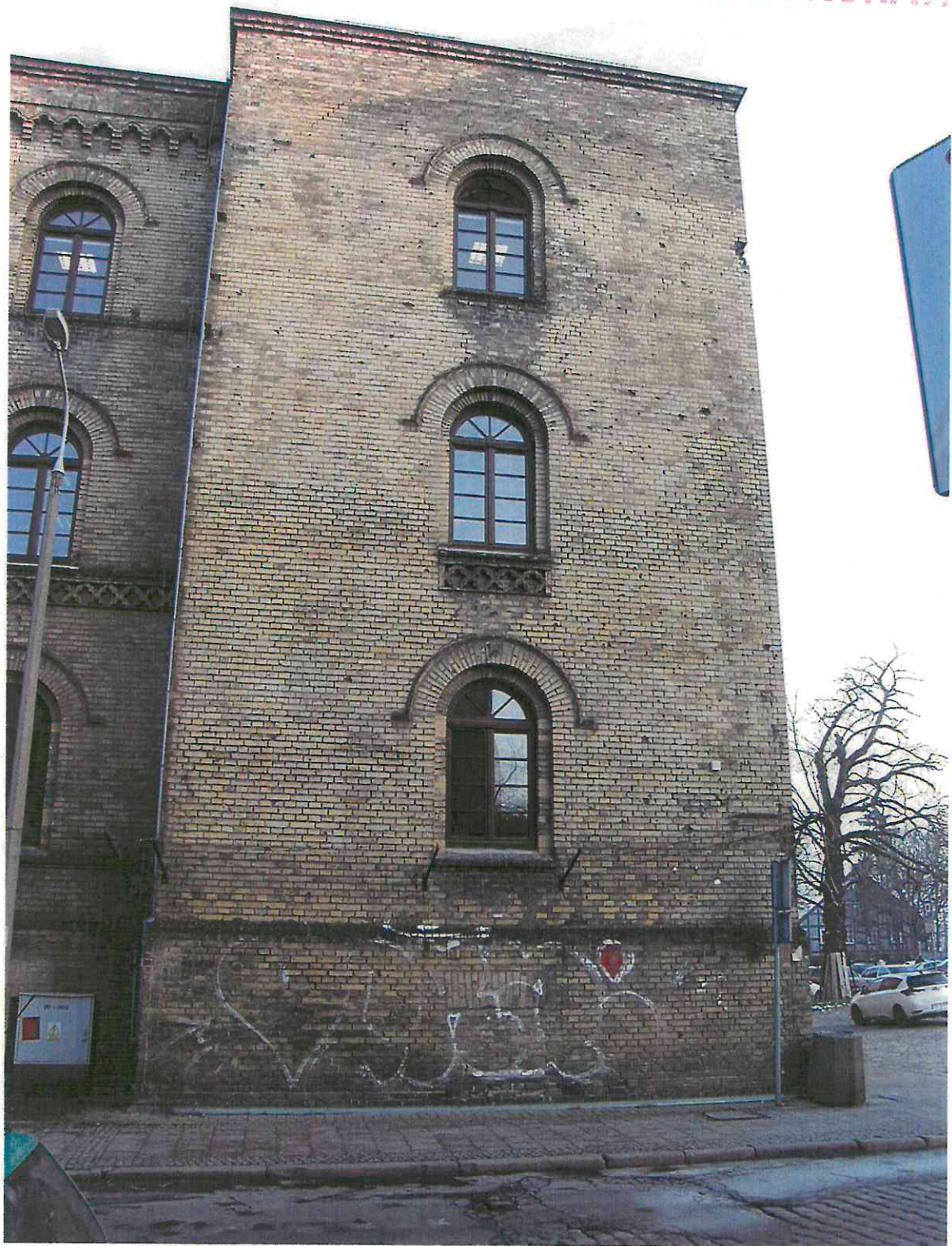
fot.55 Ryzalit narożny.- widoczne zamurowane okno w strefie cokołowej.
