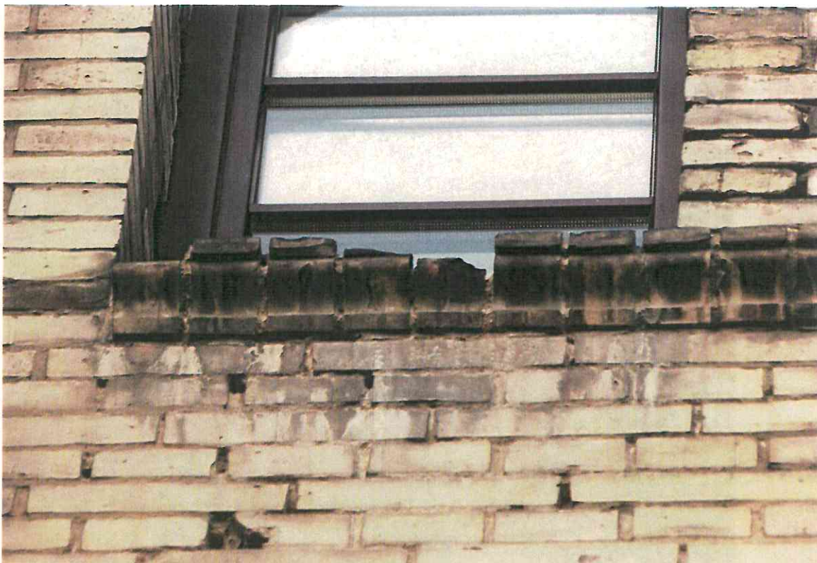
fot.20 Zabrudzenia i ubytki kształtek w gzymsie podokiennym będącym jednocześnie podstawą parapetu.
