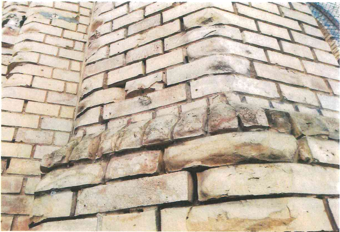
fot.16 Zniszczenia cegieł i spoin w obrębie gzymsu wieńczącego odsadzkę strefy partii cokołowej.
