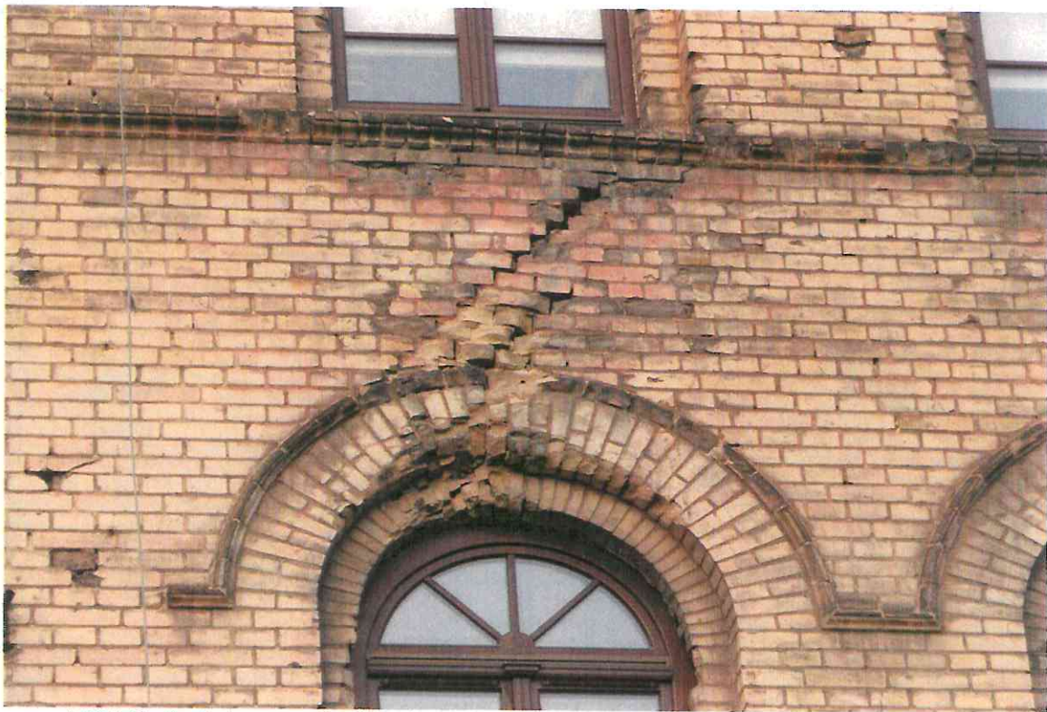
fot.22 Spękania i przemurowania wykonane czerwoną cegłą pomiędzy oknami III i IV kondygnacji.
