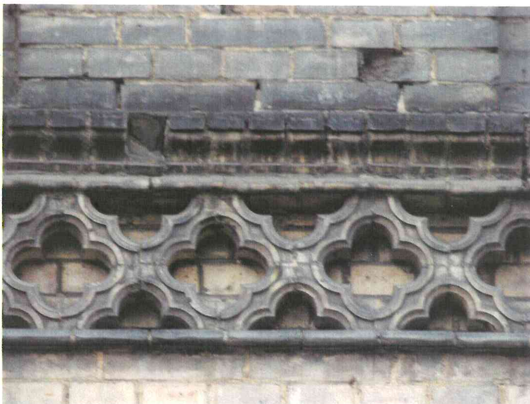
Fot.46 Zabrudzenia i ubytki w partiach gzymsu i fryzu międzykondygnacyjnego.
