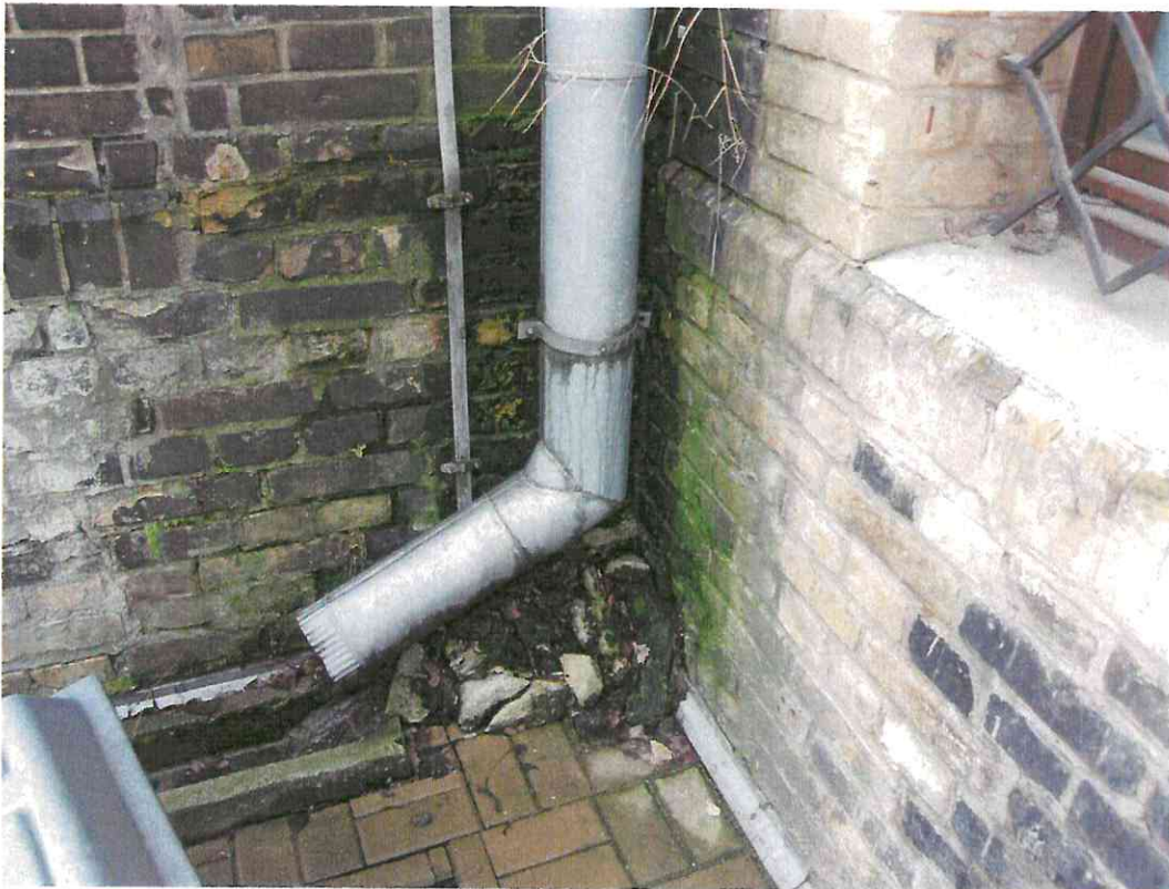
fot.50 Zniszczenia w obrębie rury spustowej , powstałe na skutek nieszczelności i niewłaściwego sposobu odprowadzenia wody.opadowej.
