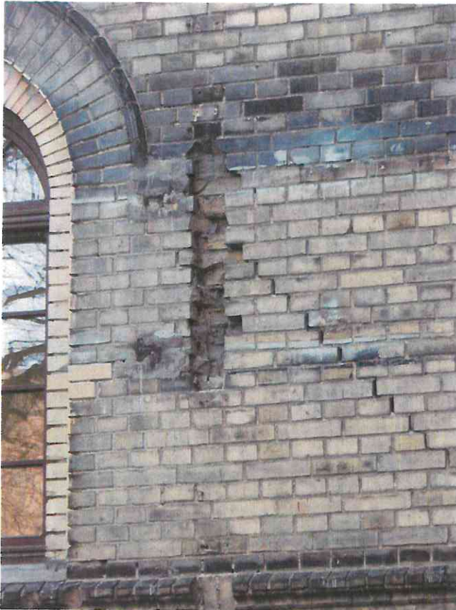
fot.37 Spękania w obrębie elewacji wewnętrznej
