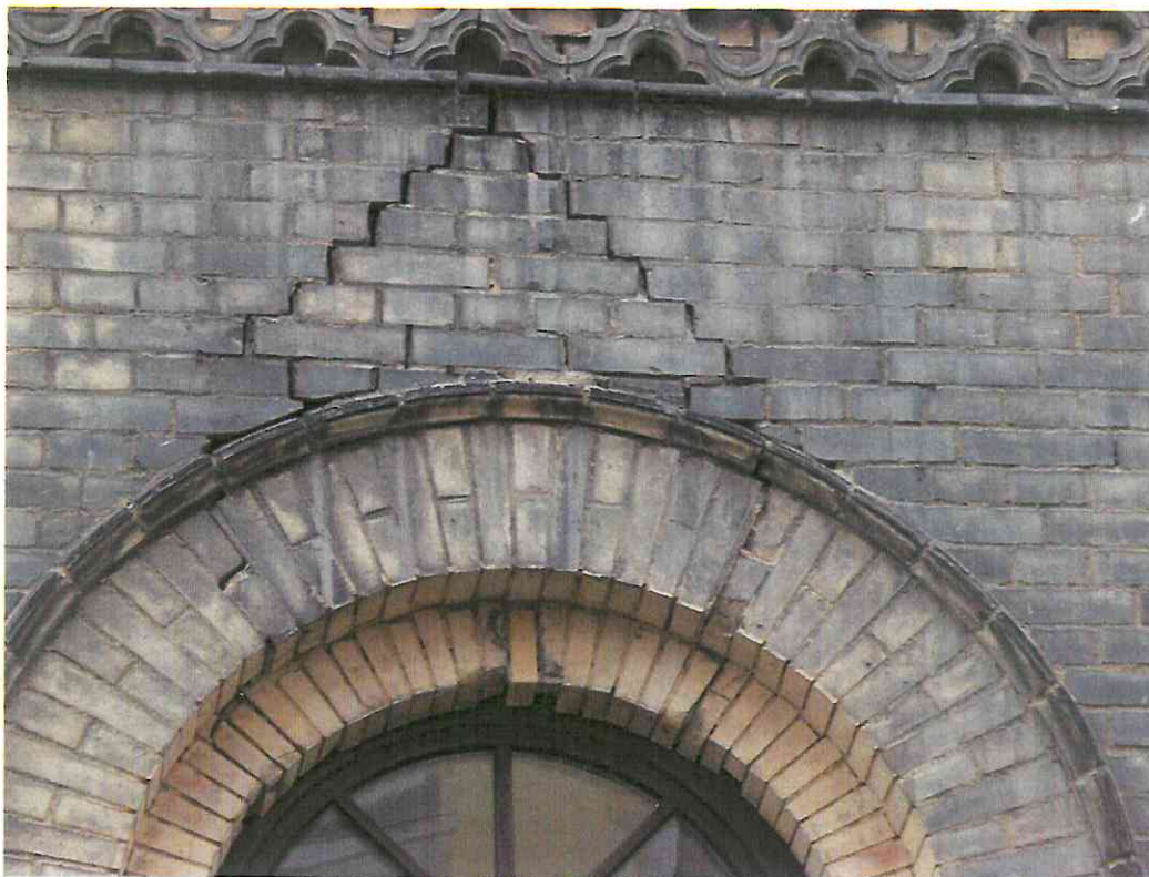
Fot.45 Spękania pomiędzy II i III kondygnacją.
