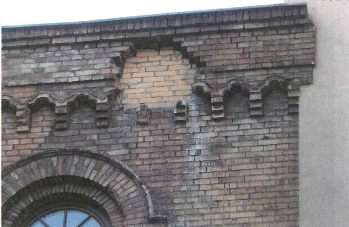
fol.30 Uszkodzenia gzymsu wieńczącego skrzydła zachodniego na styku z budynkiem Urzędem Skarbowym, zamurowany otwór prawdopodobnie po demontażu instalacji wentylacyjnych..
