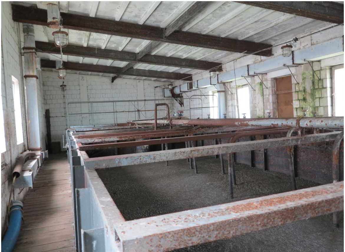
Zdj. 5. Wnętrze budynku reaktora biologicznego
