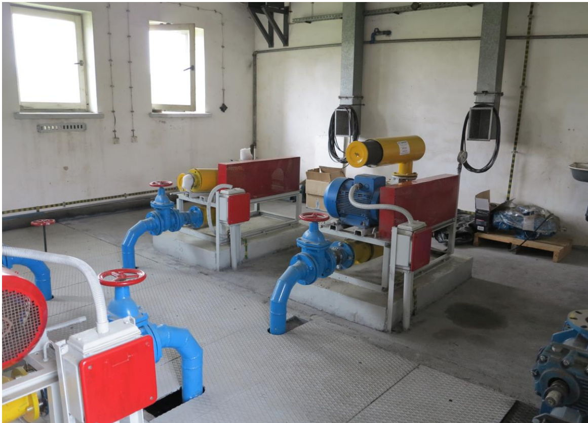
Zdj. 6. Wnętrze stacji dmuchaw i sprężonego powietrza
