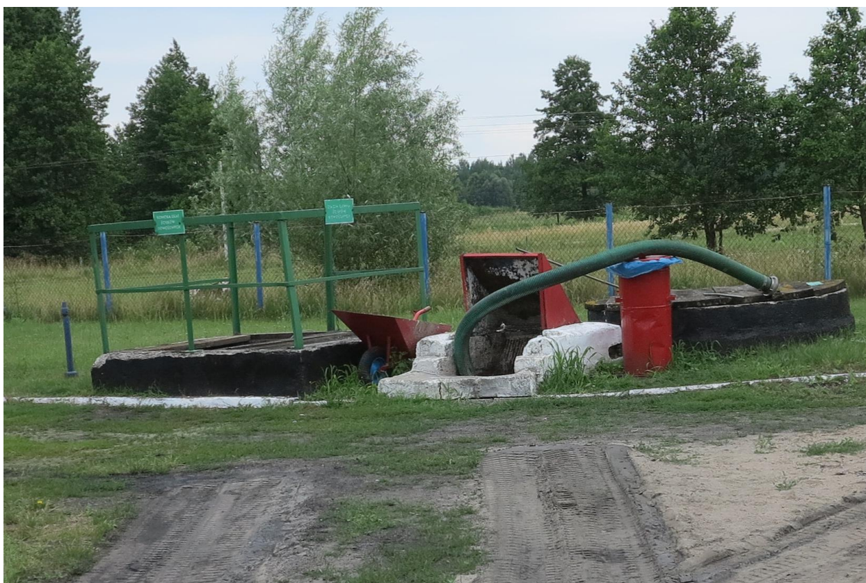
Zdj. 1. Punkt zlewny i komora krat ścieków
