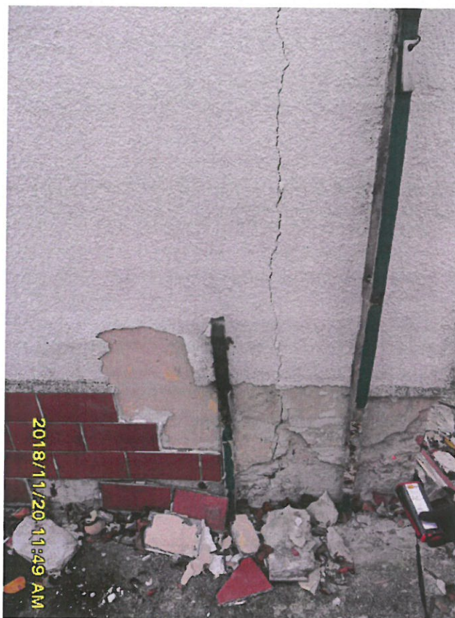
Fot. 3 Rysa w narożniku ściany, zniszczenia cokołu
