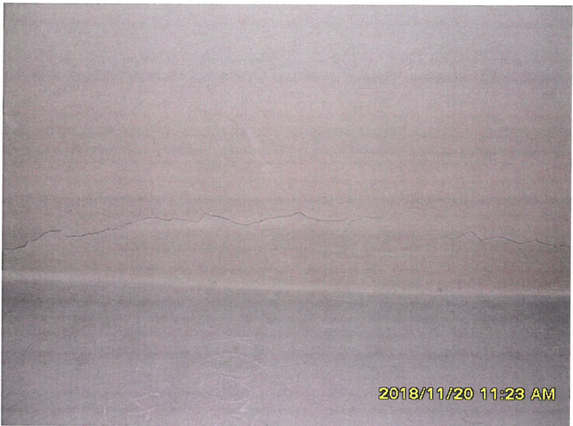
Fot. 5 Rysy na ścianach
