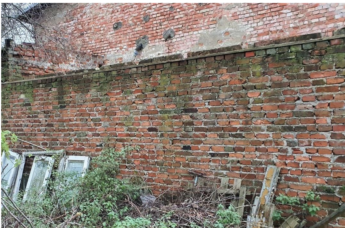
Dostawiony fragment (pozostałości) budynku gospodarczego
