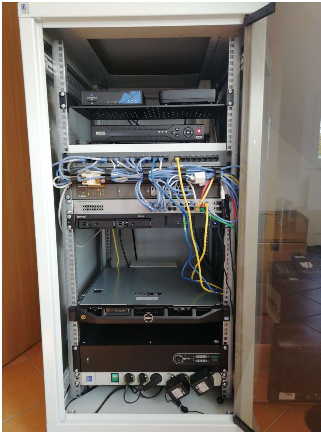
Widok wymienianej istniejącej szfy rack MDF przed modernizacją
