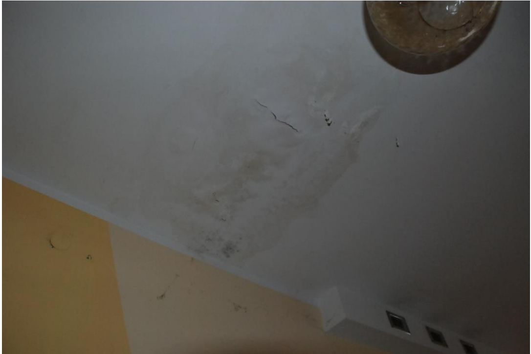
F3. Zacieki/zawilgocenia na suficie (stropie).
