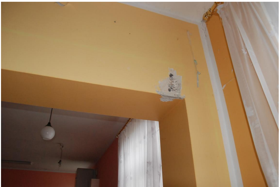
F4. Uszkodzony tynk nadproża/belki.
