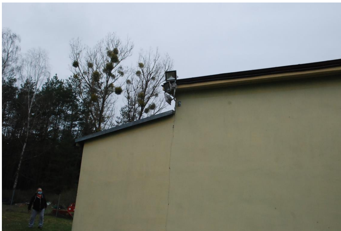
F7. Zarysowanie na styku dobudówki i budynku głównego.
