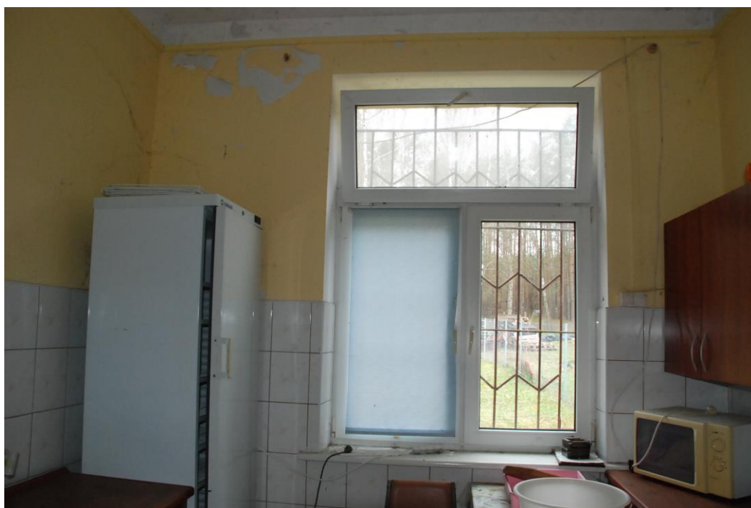
F2. Uszkodzenia tynku przy stropie w narożu ściany.
