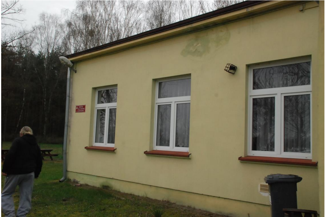
F5. Zawilgocenia elewacji przy dachu i rurach spustowych rynny.
