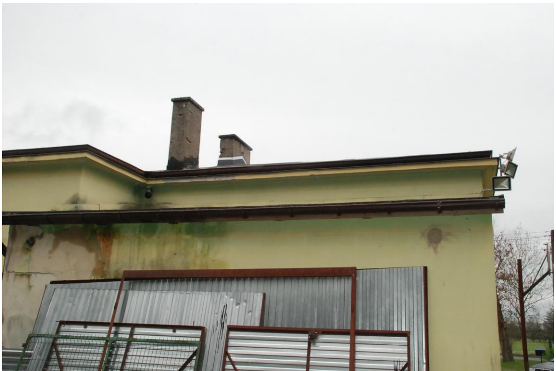
F6. Zawilgocenia i korozja biologiczna (grzyby) elewacji dobudówki.
