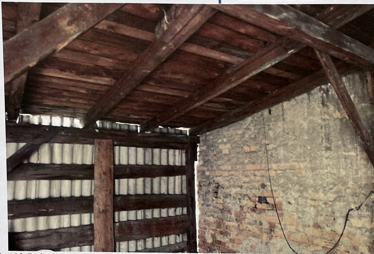
Fot. 15. Podczas kontroli przeprowadzono również kontrole wnętrza budynków. Drewniana konstrukcja sprzyja powstawaniu gniazd kopciuszka. Kontrola nie wykazała takich miejsc.
