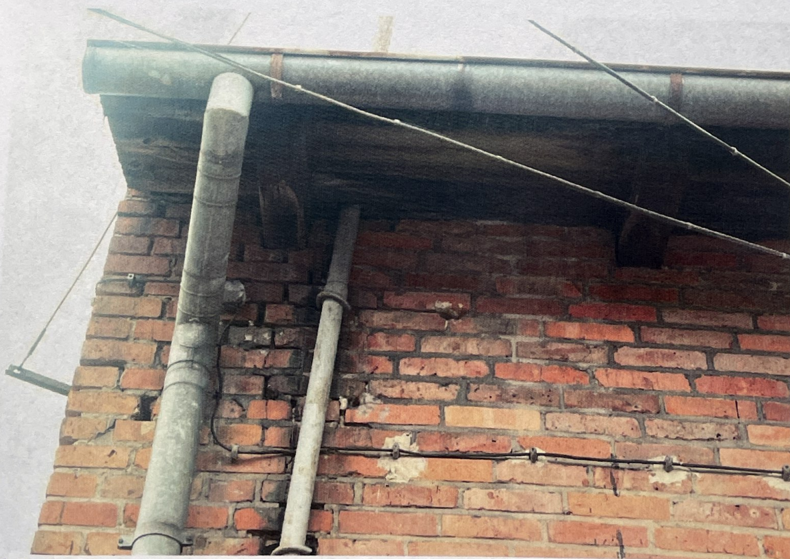
Fot. 6. Podczas kontroli szczególną uwagę poświęcono na kontrole miejsc łączenia elewacji i podbitki. Przestrzenie te często zajmowane są przez ptaki. Kontrola nie wykazała takich miejsc.
