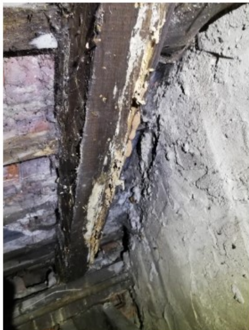
Fot. Nr 9. Destrukcja biologiczna krokwi
