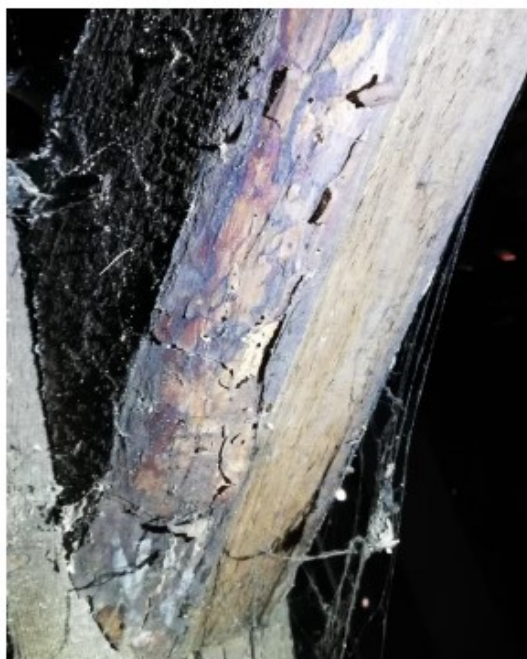
Fot. Nr 6. Uszkodzenia krokwi – degradacja wywołana szkodnikami biologicznymi owadami.
