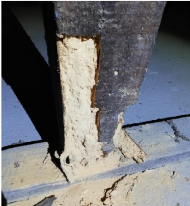
Fot. Nr 13. Destrukcja wgłębna –żywa forma owada, widoczne zwierciny.
