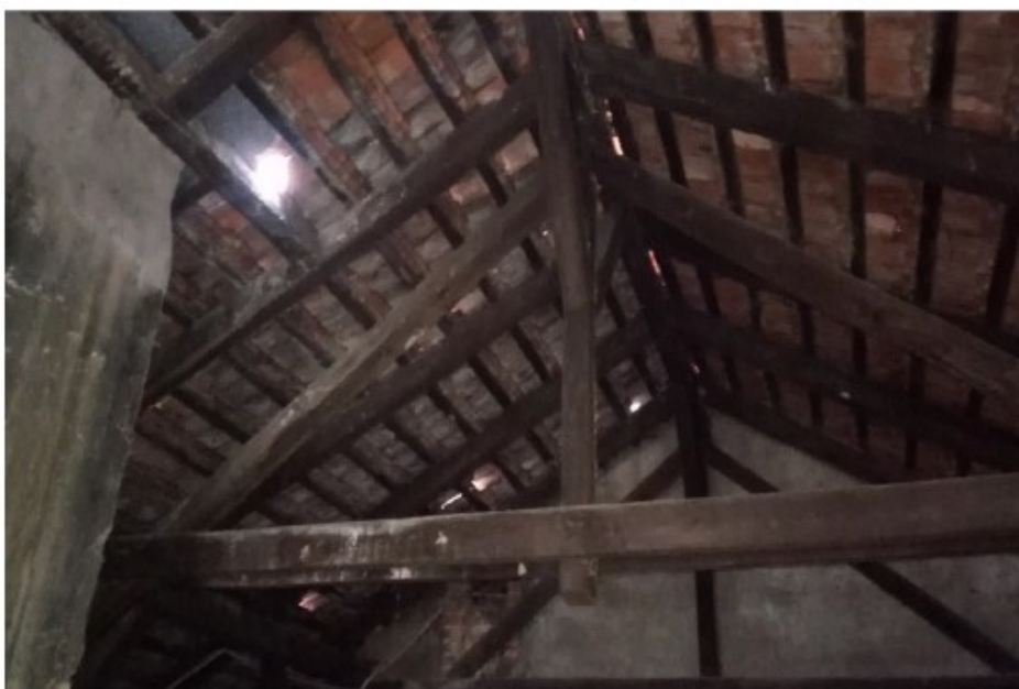
Fot. Nr 23. Układ wieszarowy z ubytkami dachówek w pokryciu dachowym przy kominie.
