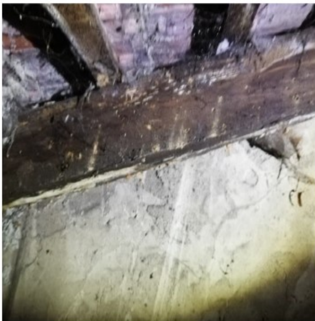
Fot. Nr 14. Zwierciny na elementach więźby– widoczne ślady żywej formy owada
