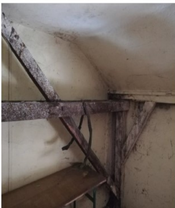
Fot.Nr 16. Ślady zawilgocenia i wysolenia w części poddasza obudowanego
