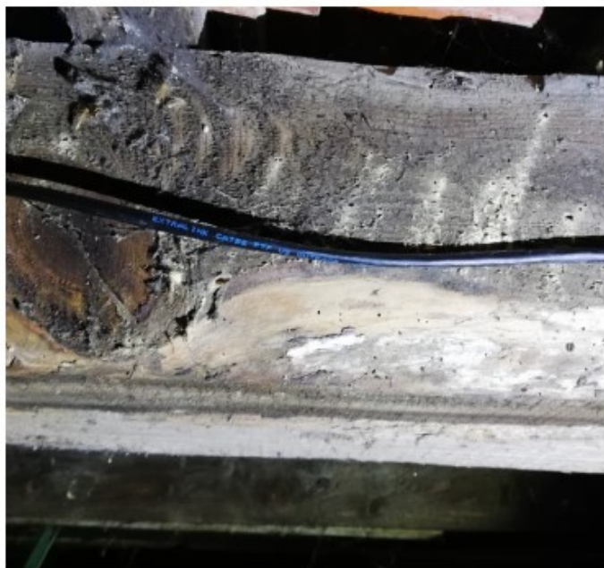
Fot. Nr 17. Otwory świadczące o destrukcji szkodników
