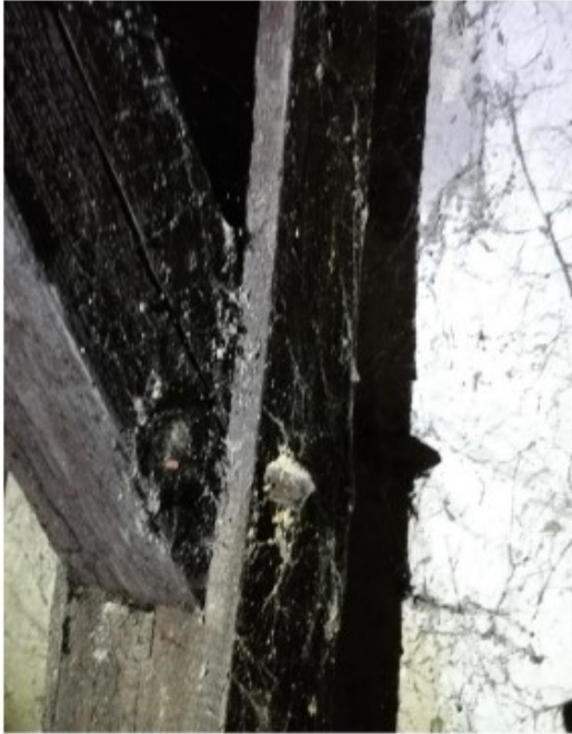
Fot. Nr 11. Zwierciny na połączeniu słupa i mieczy – widoczne ślady żywej formy owada
