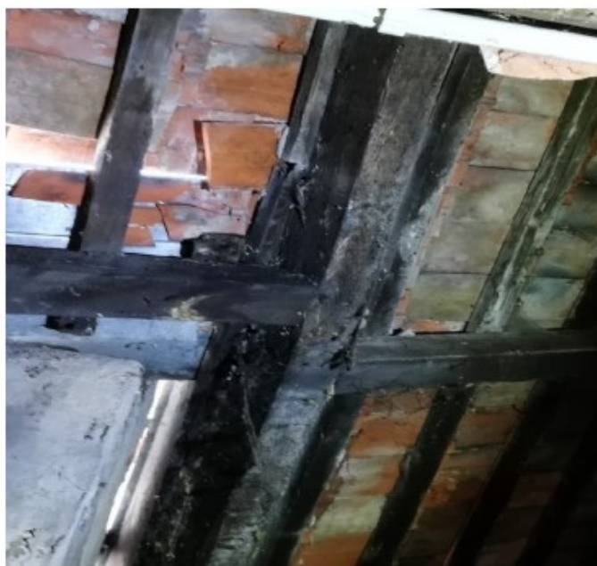
Fot. Nr 18. Uszkodzone wzmocnione belki krokwiowe, nieuszczelne pokrycie.
