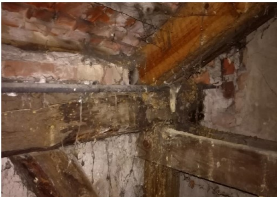
Fot. Nr 22. Węzeł ścianki kolankowej zainfekowany korozją biologiczną.
