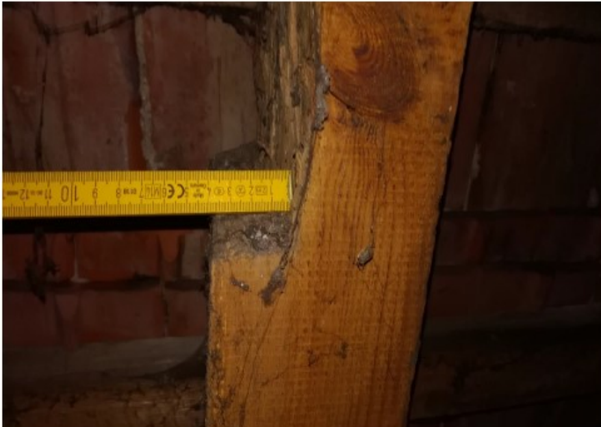
Fot. Nr 27. Ubytek 35 % przekroju w krokwi świadczy o jej pierwotnym innym położeniu (pochodzenie wtórne- spasowanie do innego węzła)
