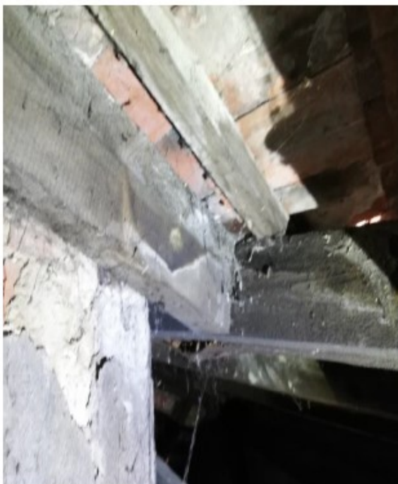
Fot. Nr 15. Ślady zawilgocenia i wysolenia
