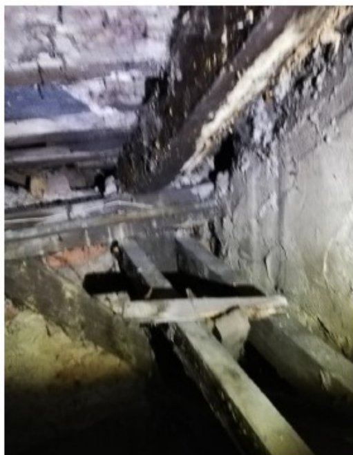
Fot. Nr 10. Destrukcja biologiczna krokwi
