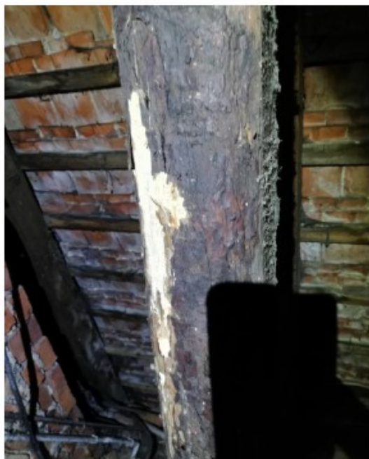
Fot. Nr 5. Uszkodzenia krokwi – degradacja wywołana szkodnikami biologicznymi owadami.
