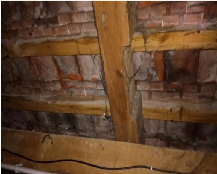
Fot. Nr 28. Ubytek przekroju w kolejnej krokwi świadczy o jej pierwotnym innym położeniu (pochodzenie wtórne- spasowanie do innego węzła)
