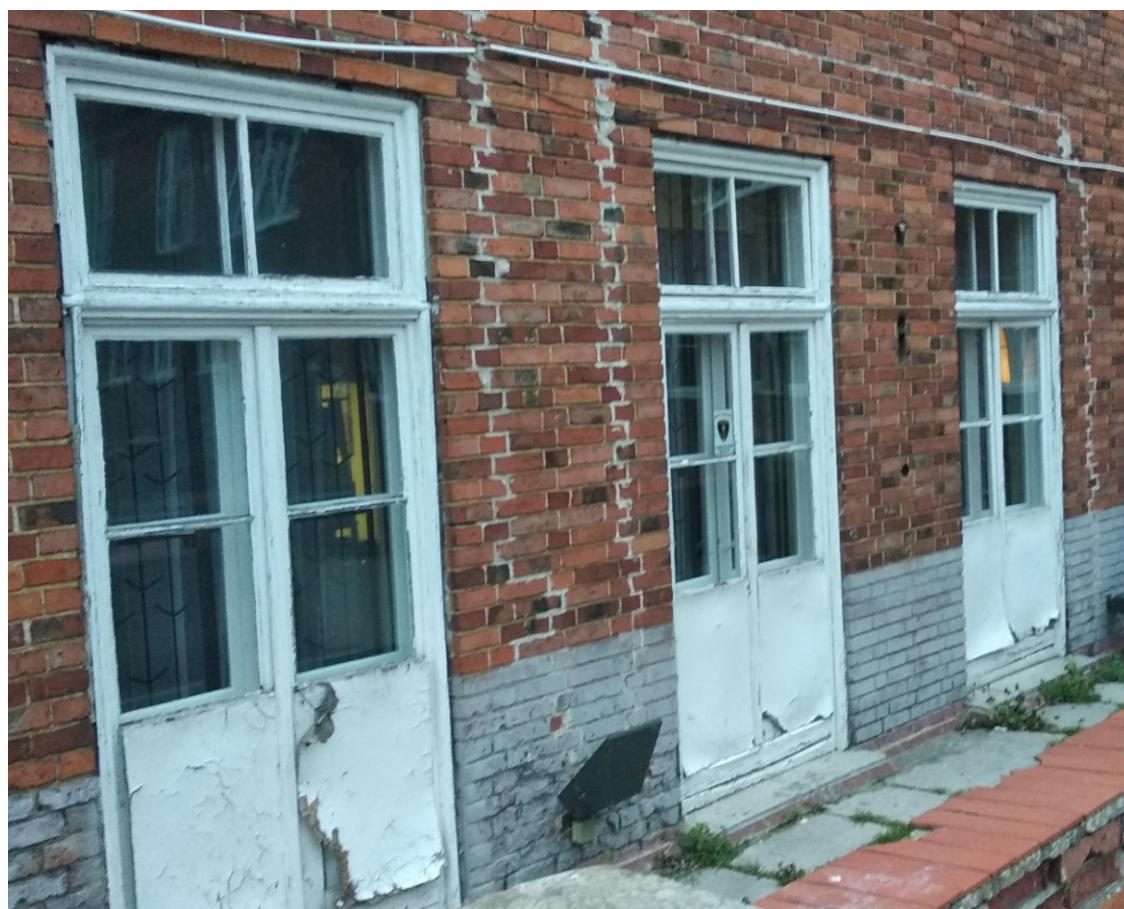
Widok na stan stolarki drzwiowej
