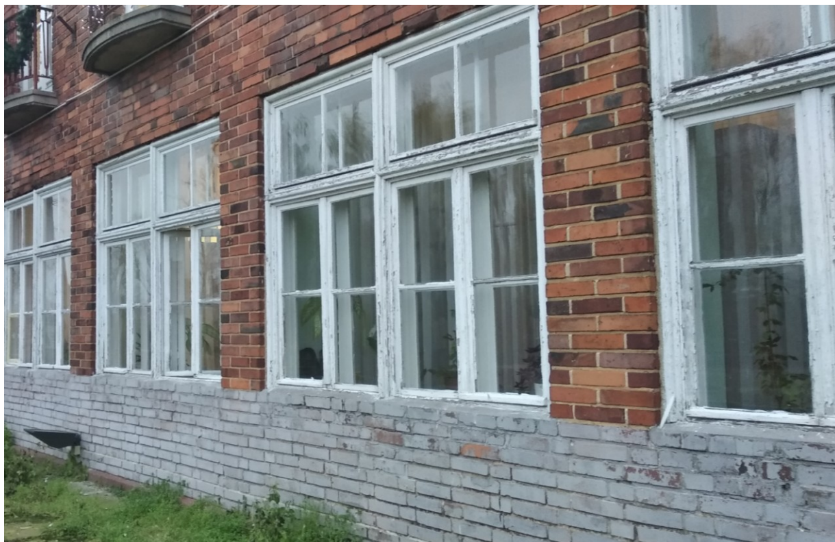
Widok na stan stolarki okiennej do wymiany.
