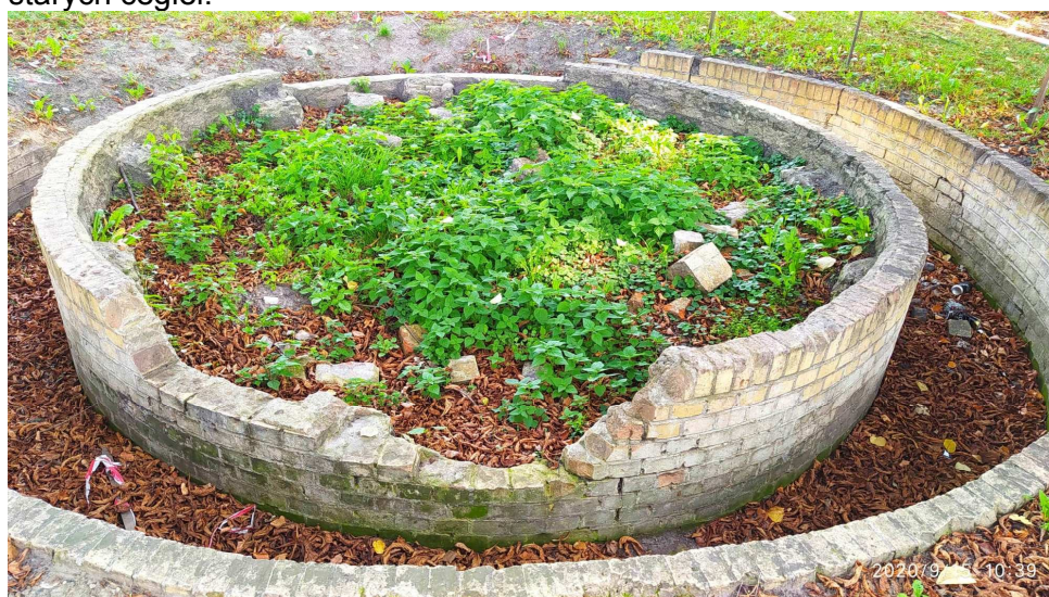
Stan istniejący fontanny do remontu
