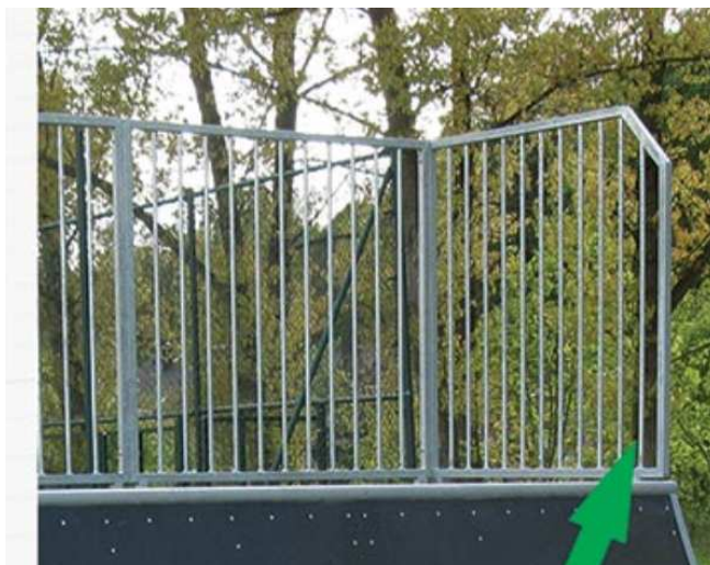
Zdjęcie 1. Ścięty kant barierki
