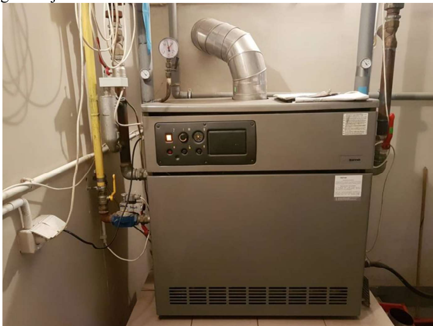
Fot. 21. Kocioł w kotłowni
