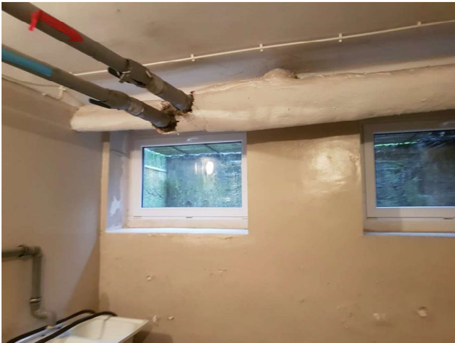
Fot. 16. Instalacja c.o. w piwnicy – włączenie z kotła
