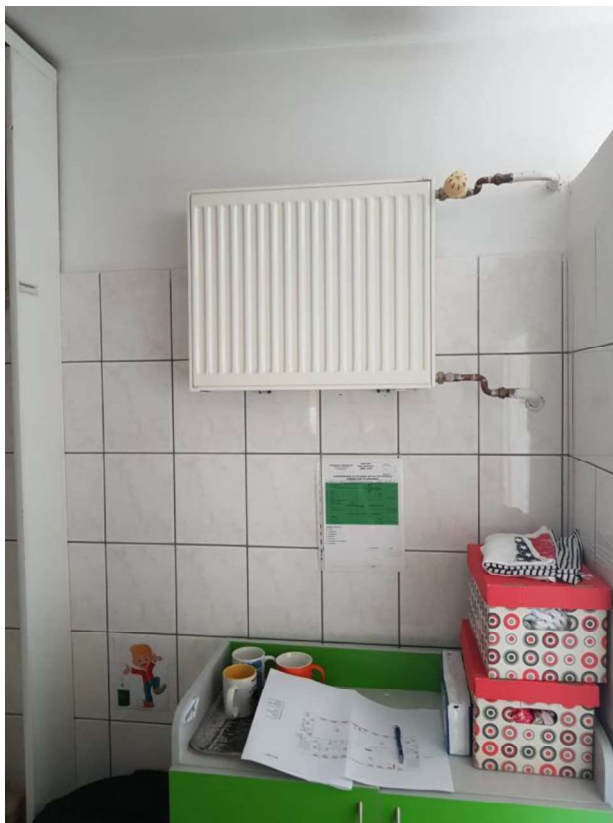
Fot. 20. Grzejnik płytowy w łazience dzieci
