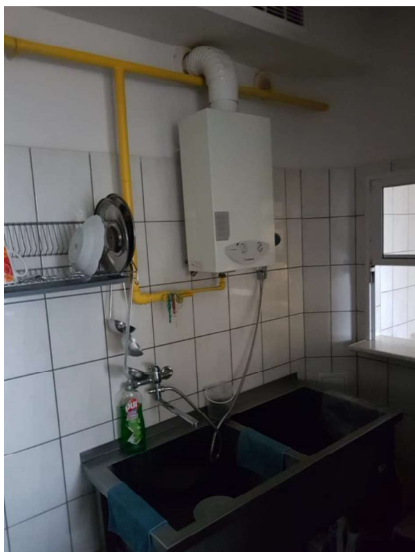
Fot. 9. Terma gazowa w pomieszczeniu kuchennym
