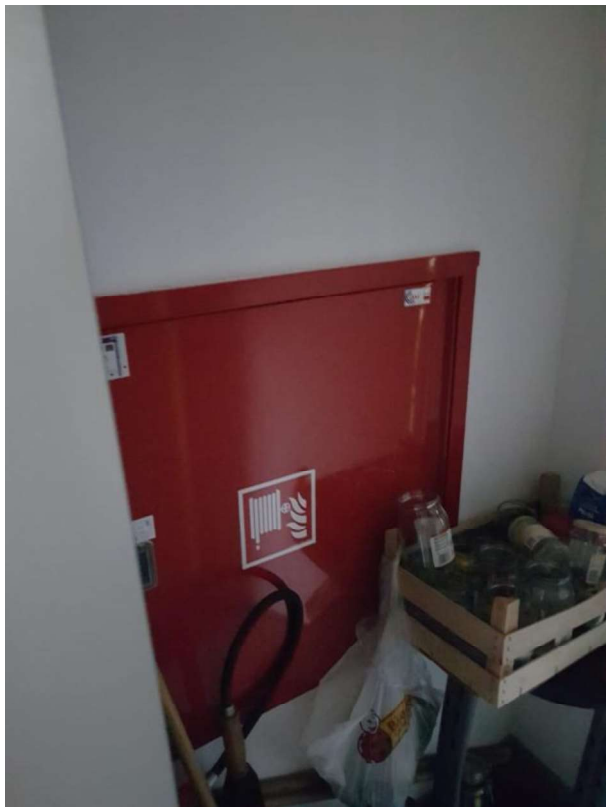
Fot. 6. Hydrant wewnętrzny dn25 podtynkowy
