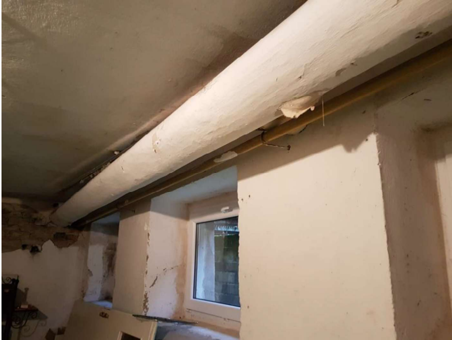
Fot. 15. Instalacja c.o. w piwnicy
