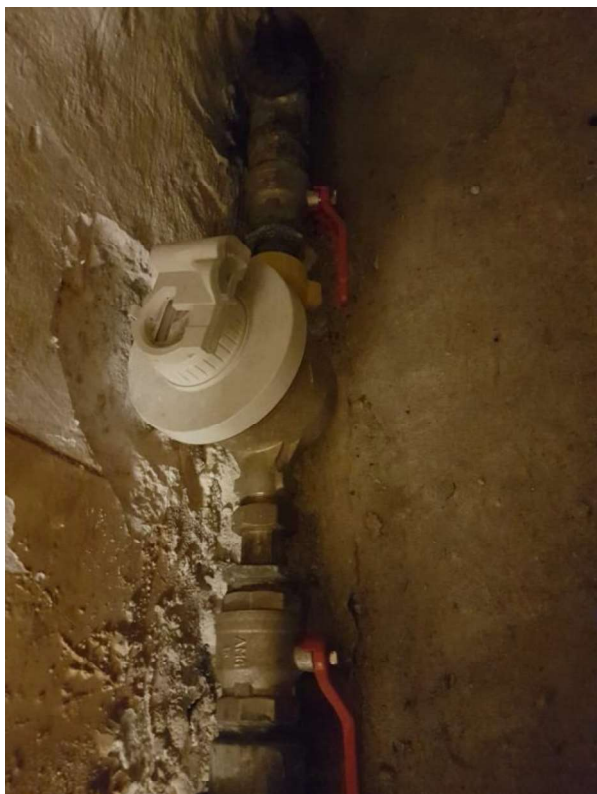
Fot. 5. Wodomierz zamontowany w budynku
