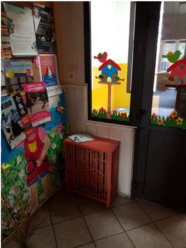
Fot. 18. Obudowany grzejnik żeliwny w holu
