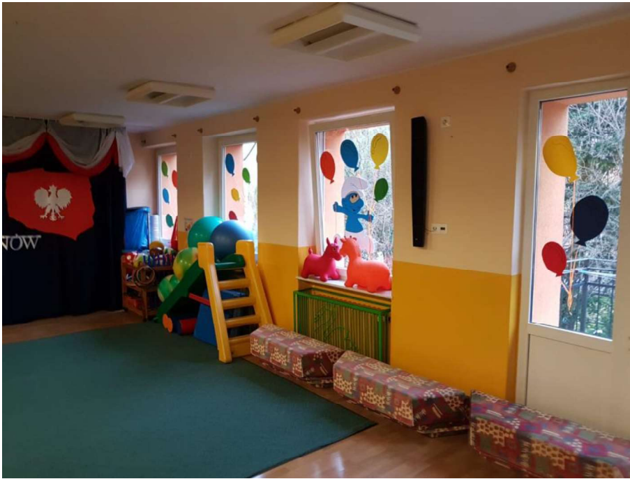
Fot. 17. Obudowane grzejniki żeliwne w sali sportowej
