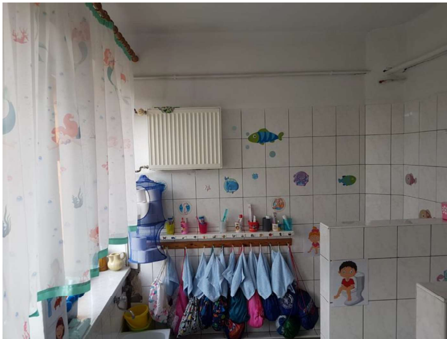
Fot. 19. Grzejnik płytowy w łazience dzieci
