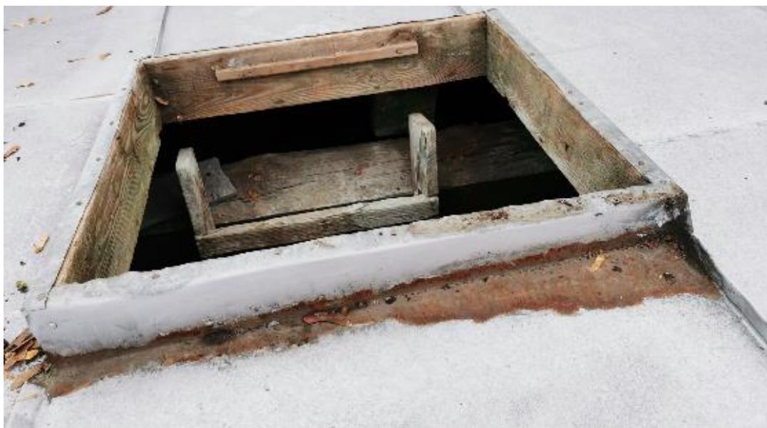
Fot. 3. Korozja i przecieki przy wyłazach dachowych
