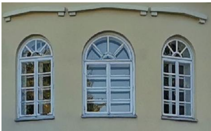
Fot. 24. Okna na piętrze budynku od strony zachodniej przeznaczone do wymiany
