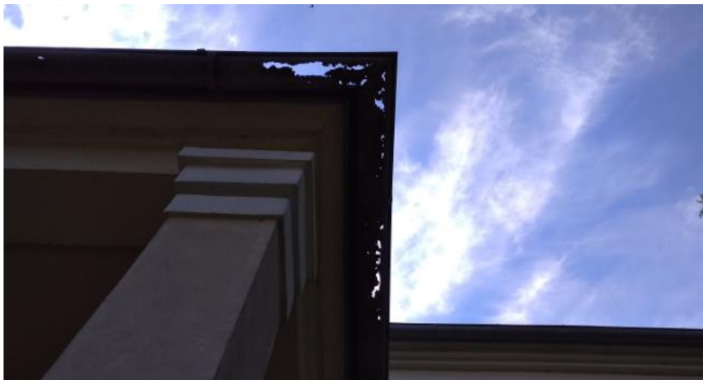
Fot. 6. Dziury w rynnie powstałe w skutek korozji
