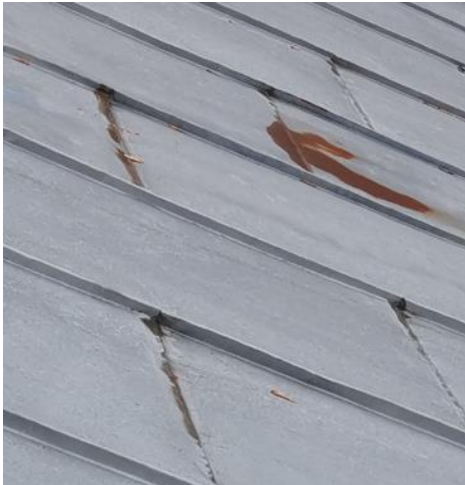
Fot. 4. Korozja dolnych rantów paneli dachowych
