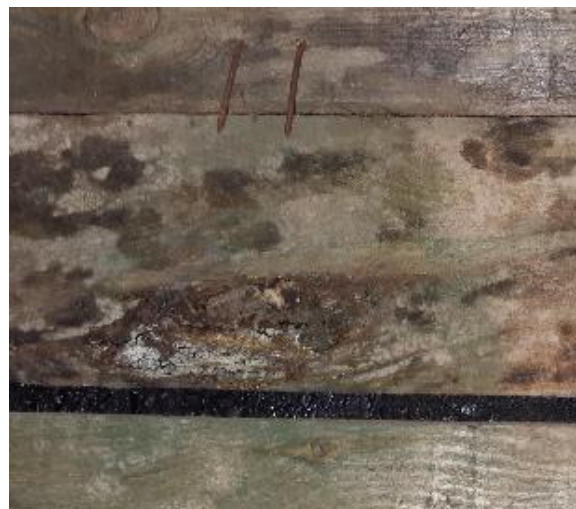
Fot. 30. Korozja biologiczna deskowania
