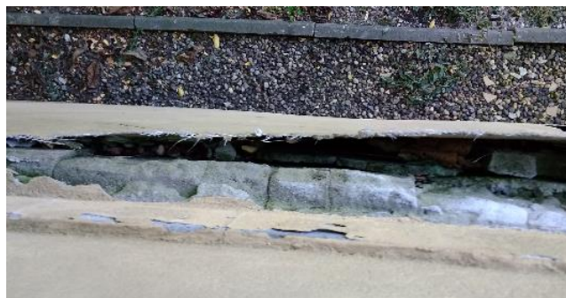
Fot. 20. Odspojenie tynku na siatce przy ścianie podjazdu dla niepełnosprawnych
