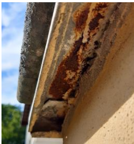
Fot. 12. Skorodowana obróbka pod płytą spocznika schodów
