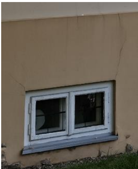
Fot. 7. Pęknięcia tynku na elewacji przy narożach otworów okiennych
