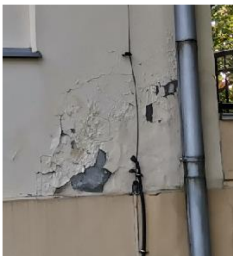
Fot. 9. Złuszczenia farby na elewacjach
