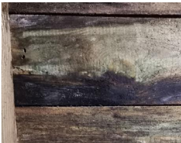
Fot. 29. Korozja biologiczna deskowania
