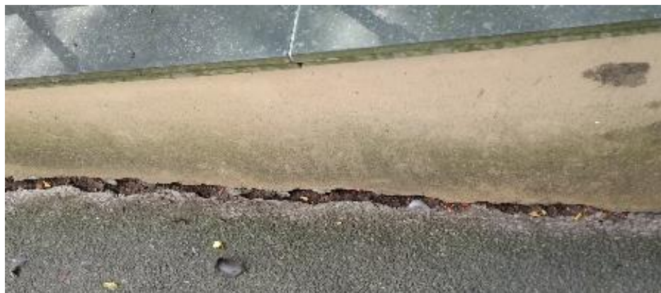
Fot. 18. Ubytki przy połączeniu płyt nawierzchni podjazdu dla niepełnosprawnych z ścianą balustrady
