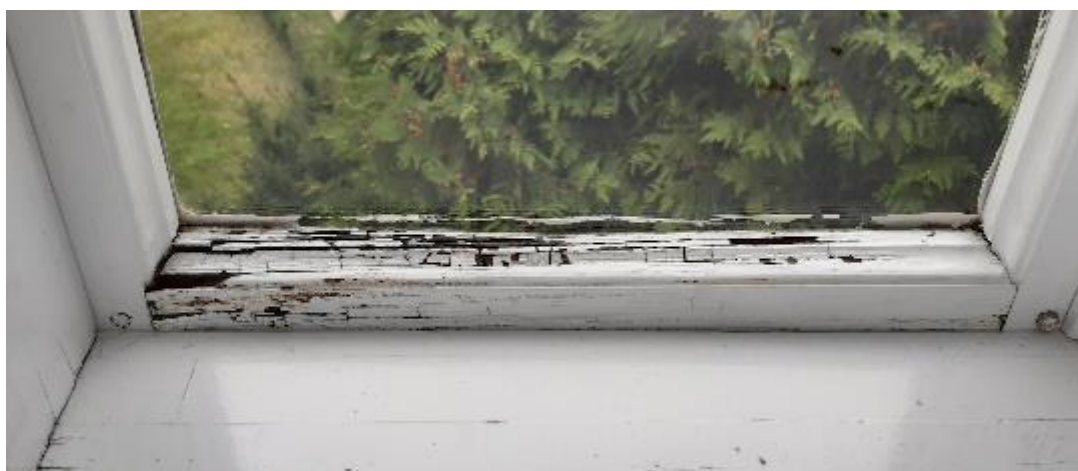
Fot. 26. Przegnite elementy skrzydła do wymiany
