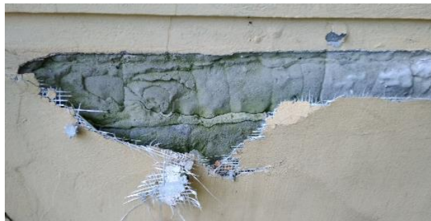
Fot. 21. Odspojenie tynku na siatce przy ścianie podjazdu dla niepełnosprawnych
