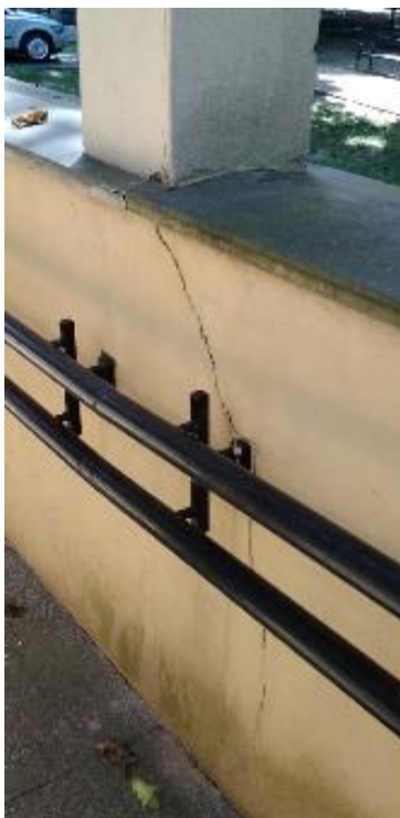
Fot. 19. Pęknięcie ściany przy środkowym słupie podjazdu dla niepełnosprawnych
