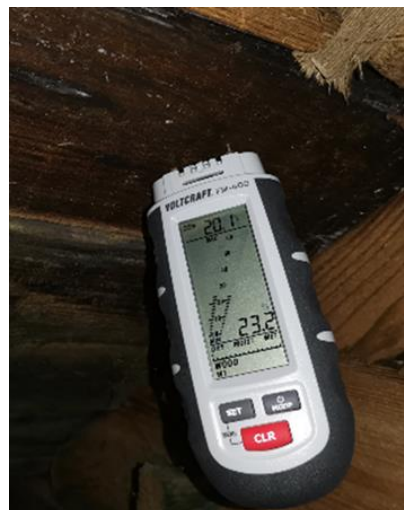
Fot. 28. Pomiar wilgotności deskowania pod północnym wyłazem
