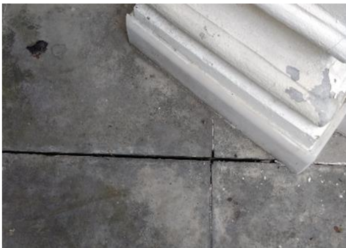
Fot. 14. Brak wypełnienia spoin (fug), deformacje podłoża z płyt kamiennych
