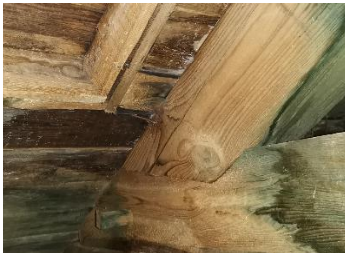
Fot. 27. Widoczne ślady wilgoci przy północnym wyłazie dachowym
