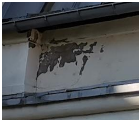
Fot. 10. Złuszczenia farby na elewacjach
