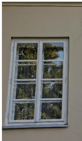
Fot. 8. Pęknięcia tynku na elewacji przy narożach otworów okiennych
