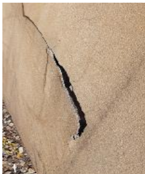
Fot. 13. Pęknięcia i odspajanie tynku ścian bocznych schodów
