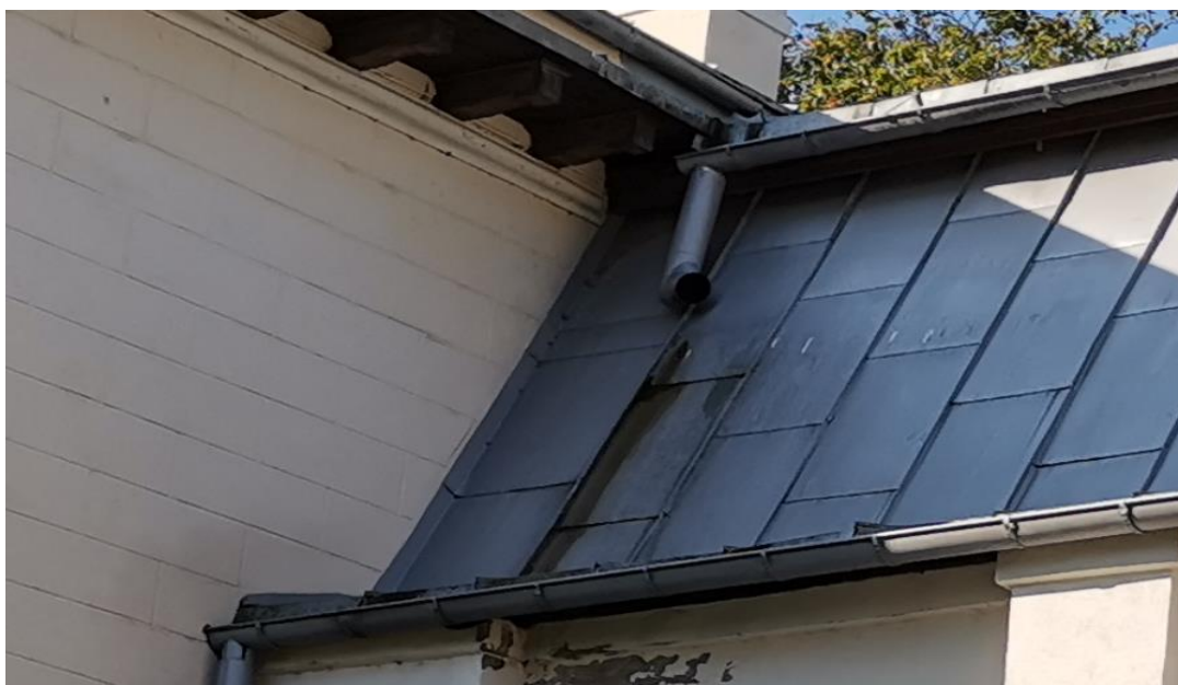
Fot. 2. Miejscowa korozja poszycia dachowego przy wylotach z rynny
