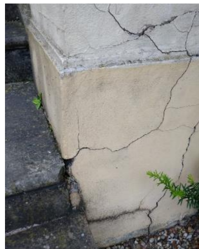
Fot. 15. Znaczne spękanie i odspajanie tynku ścian bocznych i słupów schodów
