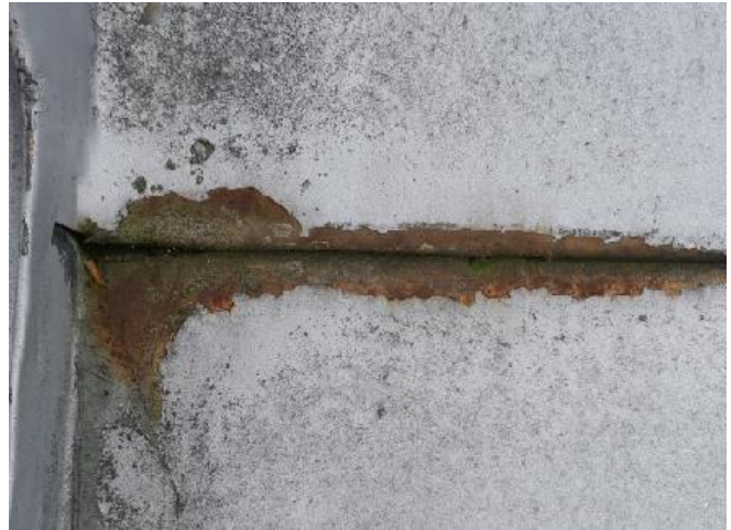
Fot. 5. Korozja dolnych rantów paneli dachowych
