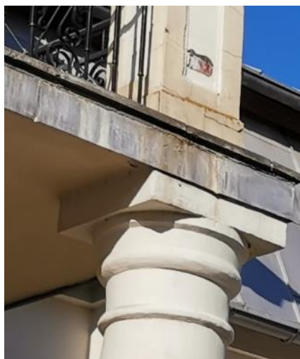
Fot. 23. Zabrudzenia i korozja obróbki blaszanej balkonu
