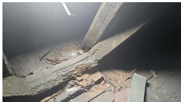
Porażenie biologiczne grzybem domowym
