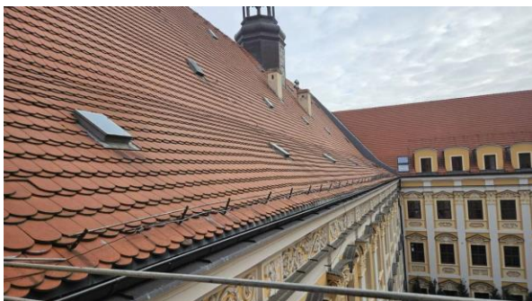
Widoczne pofalowania więźby dachowej w niższych połaciach dachu
