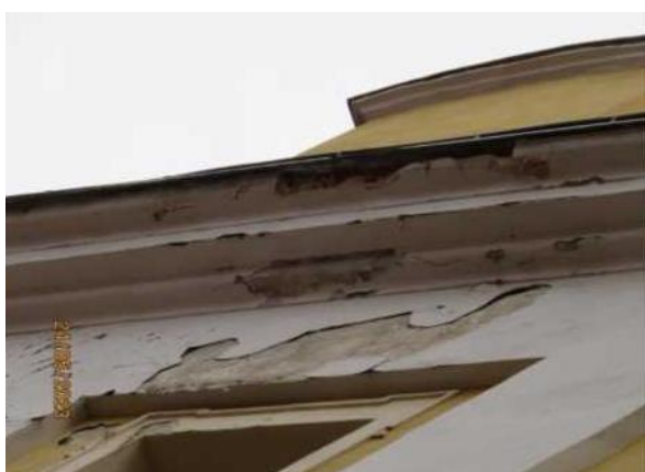
Korozja tynków i stref podgzymsowych
