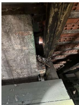
zdj.1. Konieczność uszczelnienia dachu
