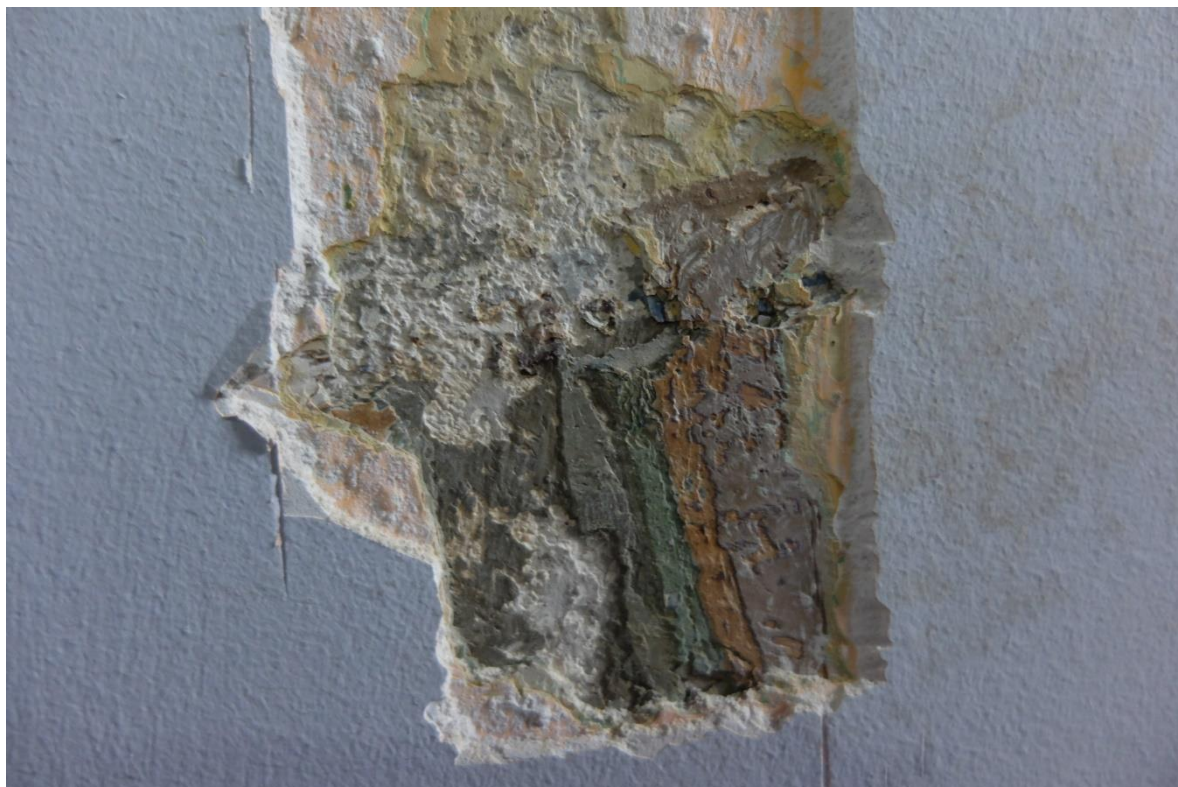
FOT. 55 - Klatka schodowa pomocnicza - II bieg w kierunku kondygnacji piętra, ściana północna, powłoki farb olejnych lamperii.
