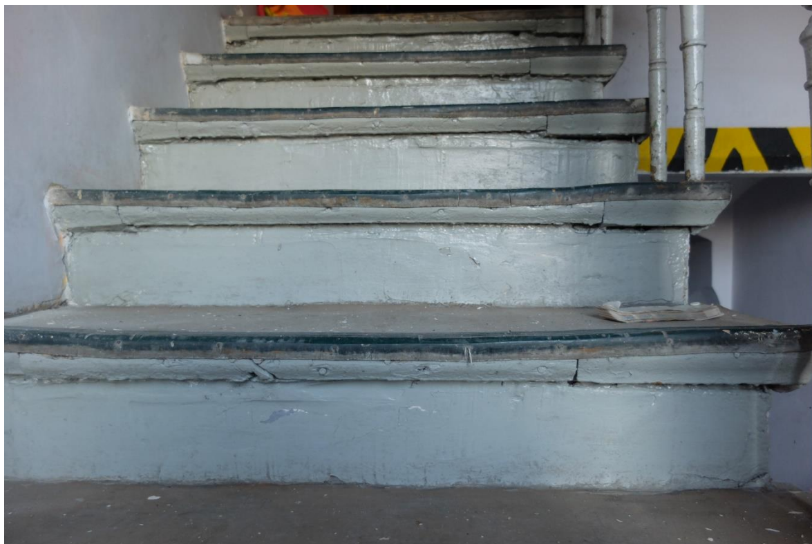
FOT. 61 - Klatka schodowa pomocnicza - stopnie schodów na poziom parteru, uzupełnienia i deformacje detalu..
