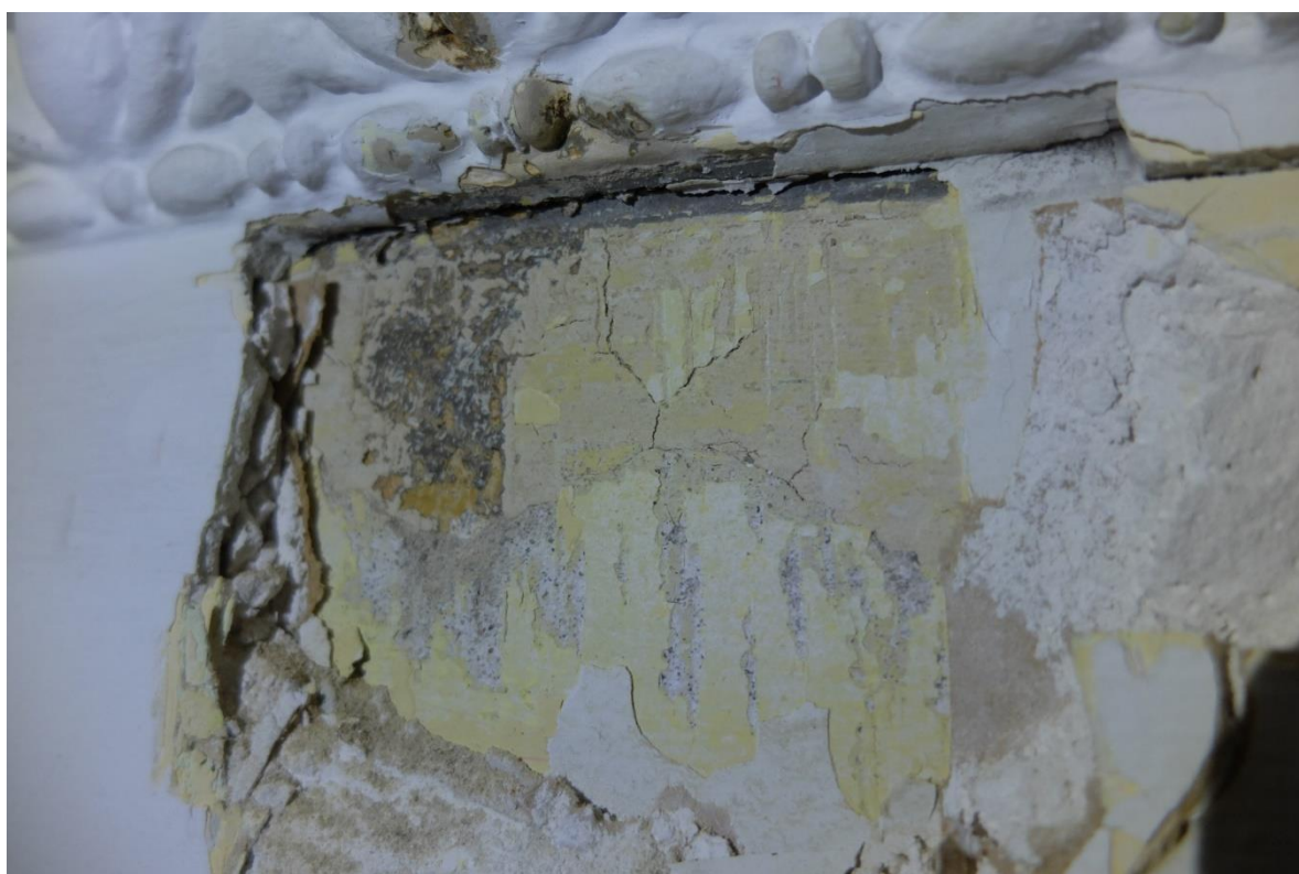
FOT. 28 - detal fot. 27 - strzęp tynku I fazy chronologicznej pod listwą dekoracyjną, niżej wypełnienie wtórne. Całość zastonięta płytą gk i wyrównującą warstwą gipsu.
