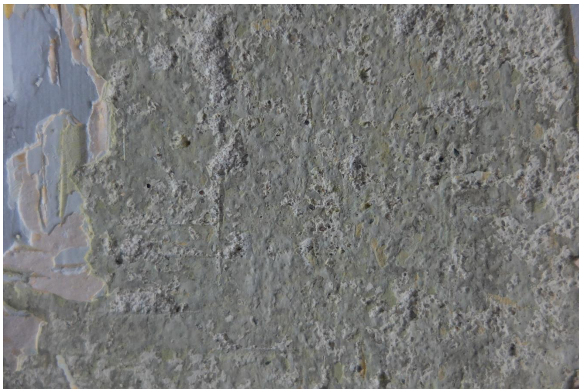
FOT. 59, 60 - Klatka schodowa pomocnicza - poddasze, podest, ściana północna, fragment i detal odkrytki na powierzchni tynku.
