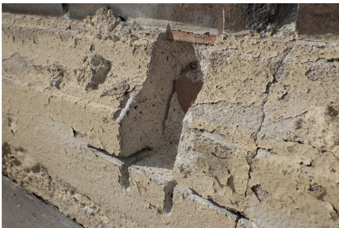
FOT. 6 - Elewacja wschodnia, profil tynkarski nad opierzeniem gzymsu nad I kondygnacją w miejscu pobrania próbki nr 6.
