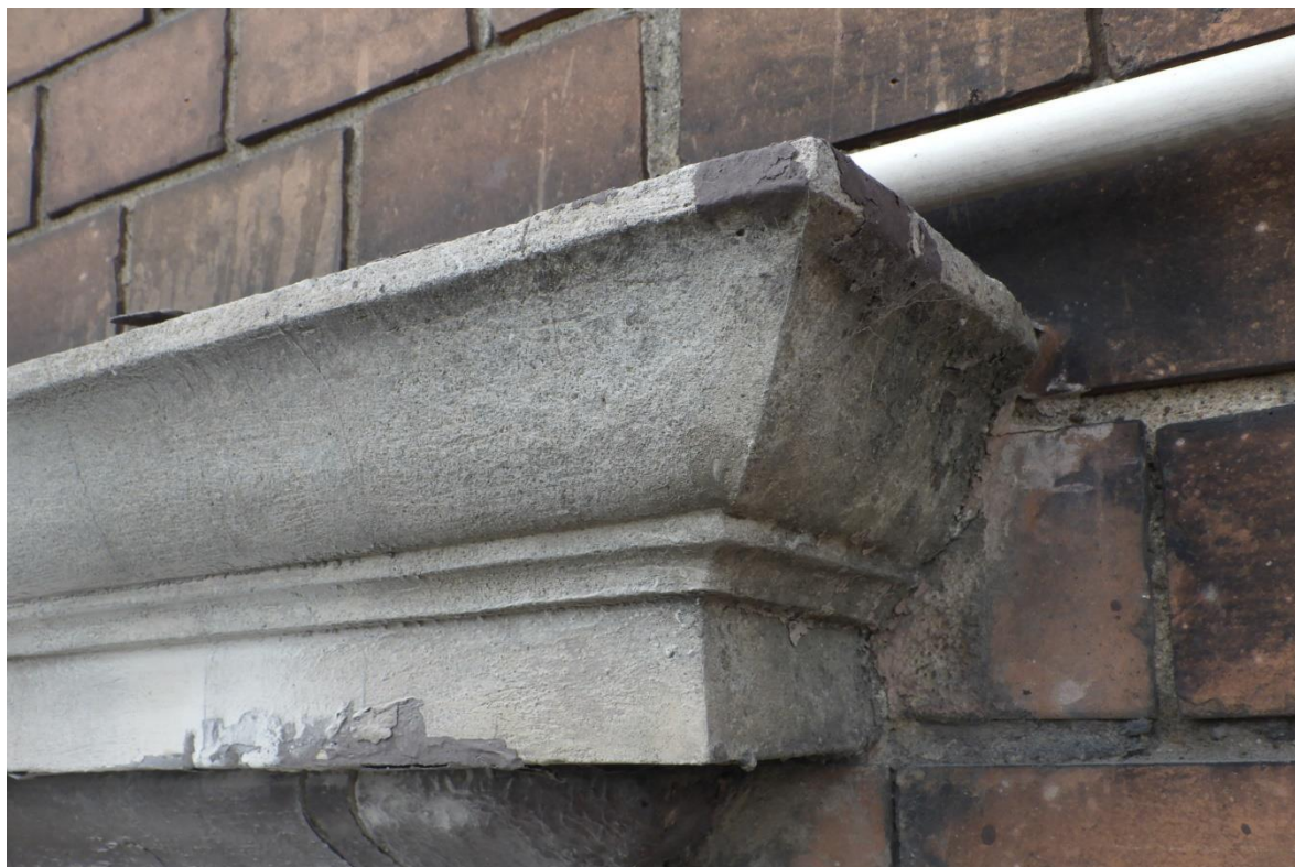
FOT. 7 - detal fot. 4 - naczótek okna klatki schodowej, fragment - zaprawa cementowa.
