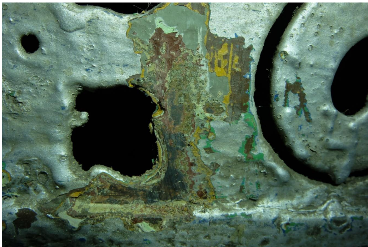
FOT. 42 - detal fot. 41 - odkrywanie z odstąpieniem powierzchni blachy stalowej.
