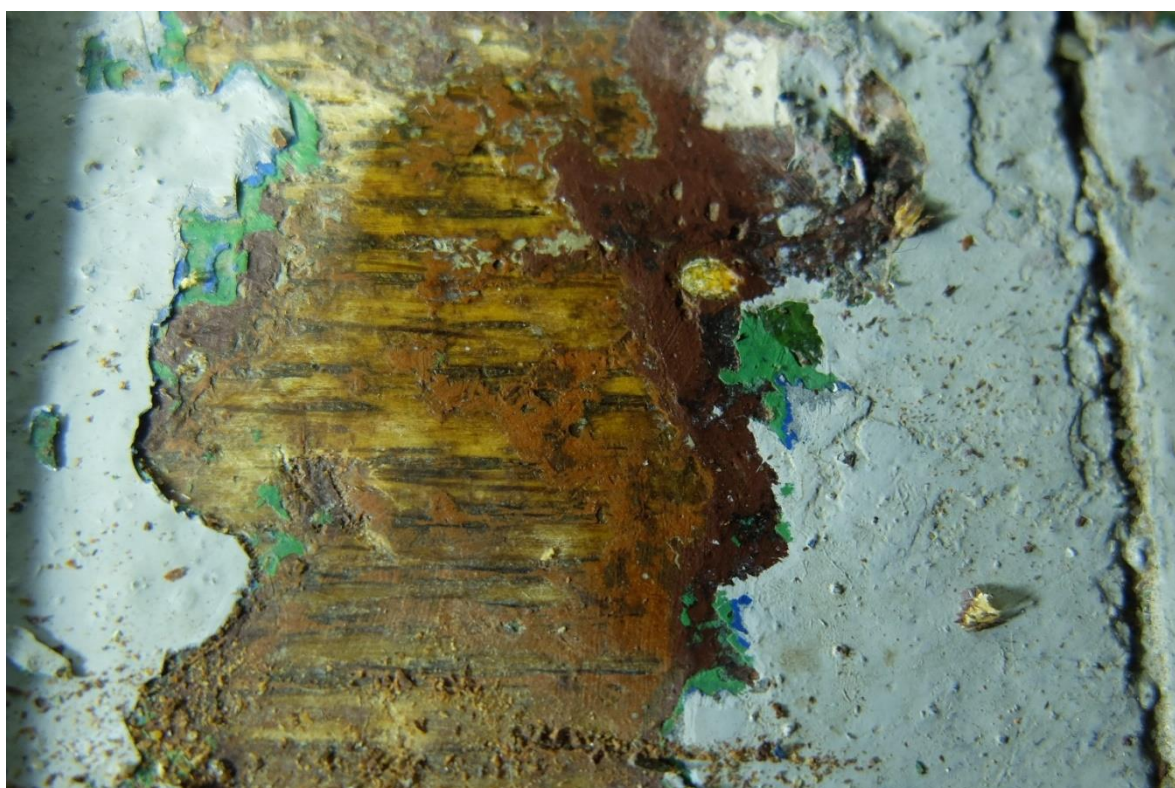
FOT. 46 - Klatka schodowa główna - nawarstwienia na powierzchni drewnianej stopnicy.
