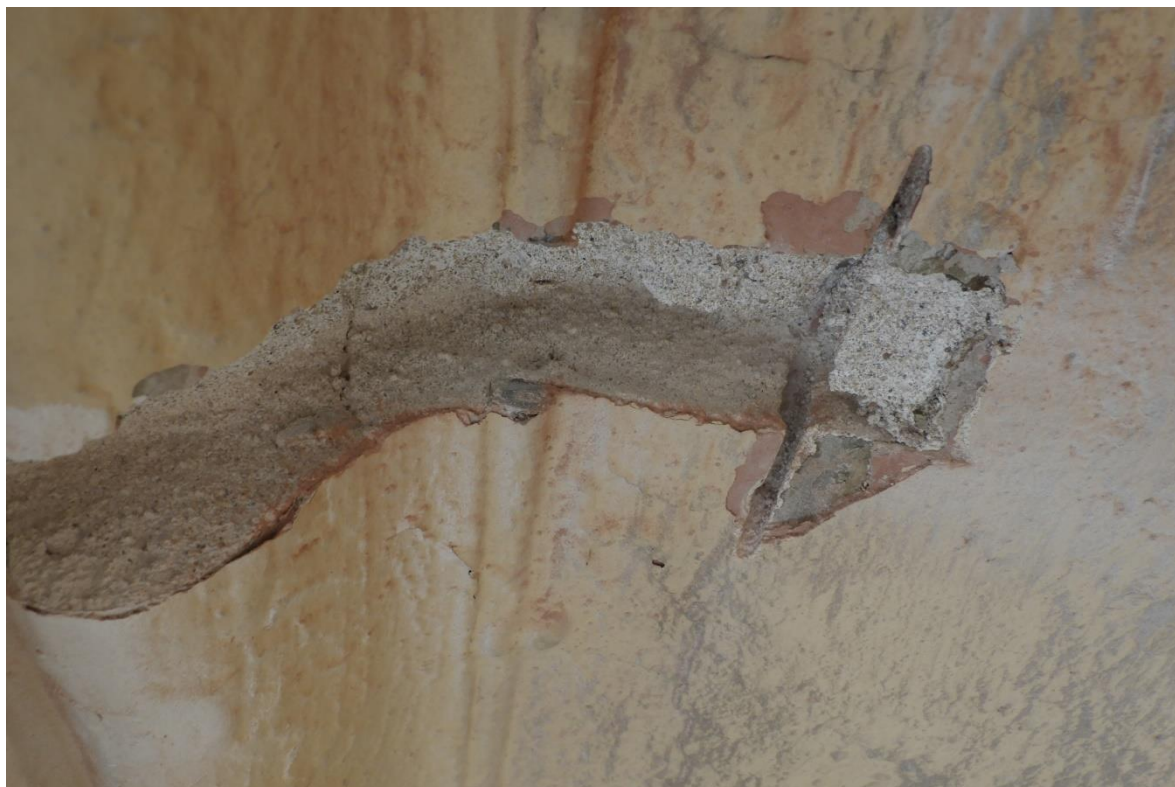
FOT. 9 - Elewacja wschodnia, fragment - profil gzymsu wieńczącego kondygnację parteru w miejscu pobrania próbki nr 11. Tynk wapienny I fazy chronologicznej . ←
