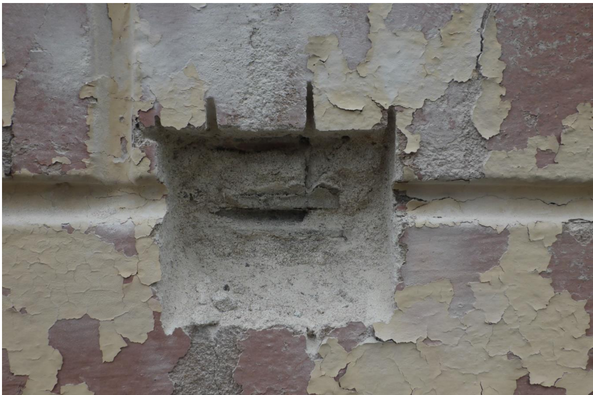
FOT. 18 - detal fot. 17- boniowanie w miejscu pobrania próbki nr 23, w głębi widoczny utracony profil boniowania I fazy chronologicznej.
