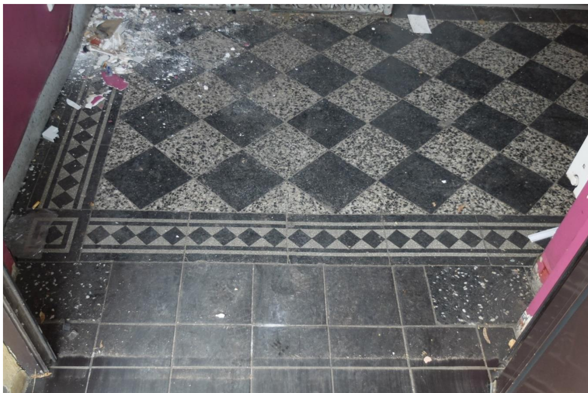
FOT. 20 - Klatka schodowa główna - posadzka w przyziemiu, widok ogólny z podcienia elewacji wschodniej.
