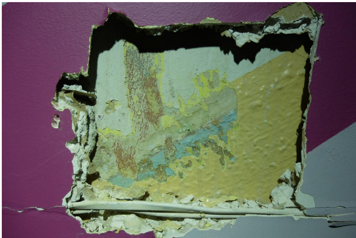
FOT. 37 - detal fot. 36 - lamperie wtórne wystroju historycznego.
