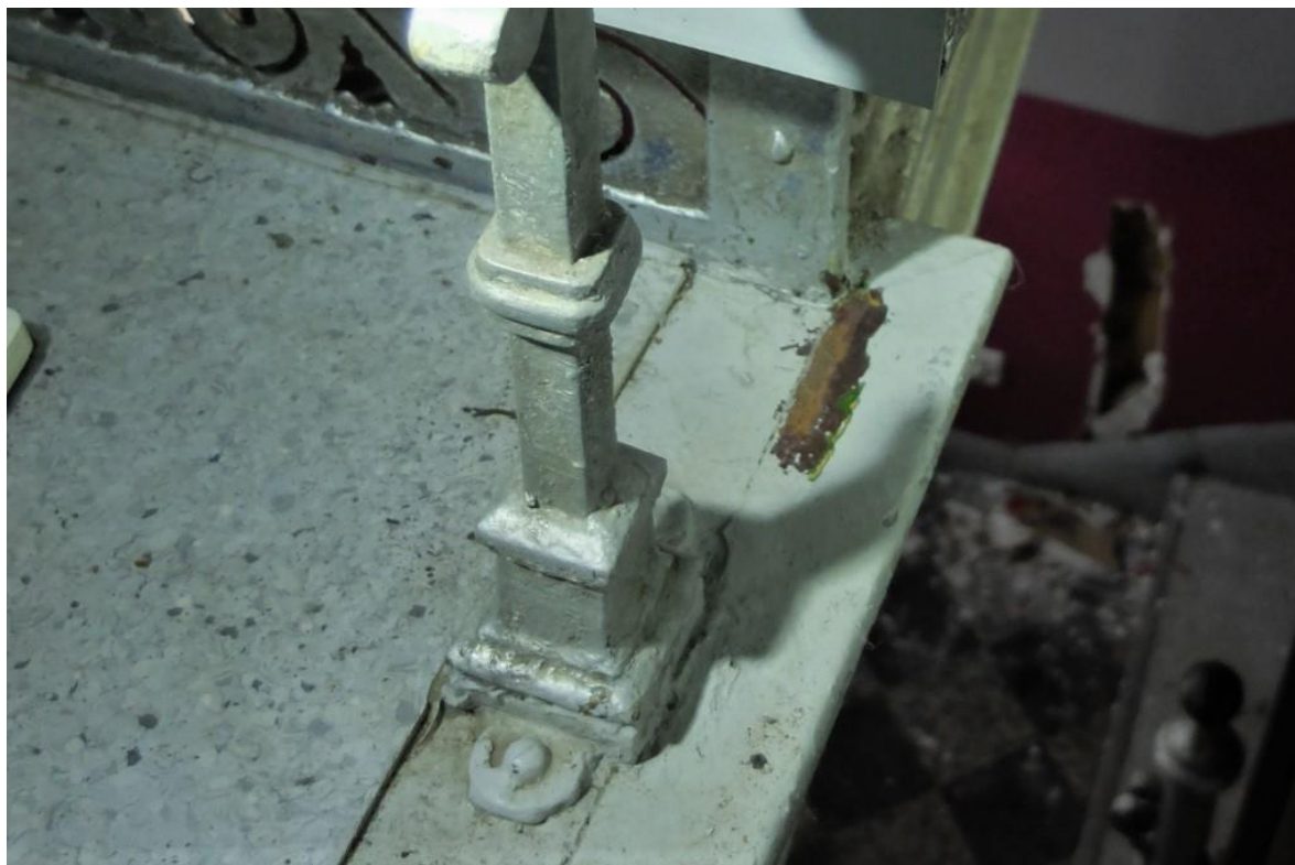
FOT. 45 - Klatka schodowa główna - mocowanie tralki balustrady do stopnicy, odkrywka na powierzchni drewna.
