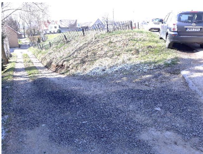
Fotografia 1. Początek drogi w rejonie skrzyżowania z drogą powiatową.
