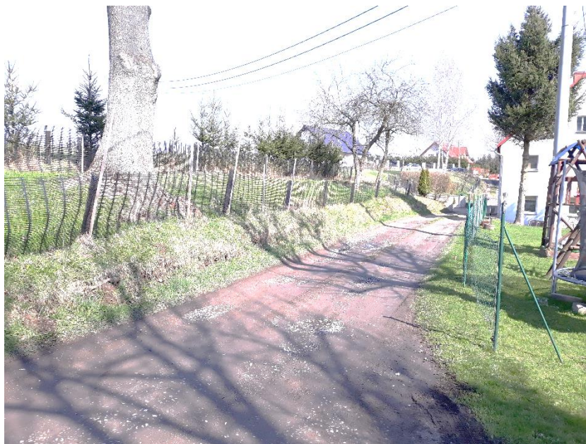
Fotografia 3. Końcowa część drogi. Ubytki i zastoiska wody na jezdni, zawyżone pobocza.
