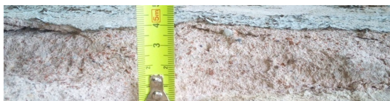
Przekrój warstwy pierwotnego tynku, grubość około 3,5-5 cm, ściana elewacji frontowej budynku biurowego, od strony podwórza wewnętrznego.
