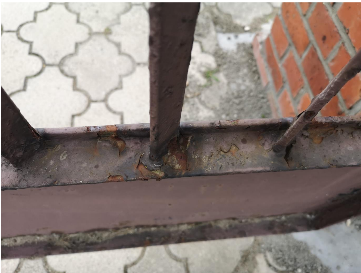
Brama główna ze śladami zardzewień pod warstwą przemalowań.
