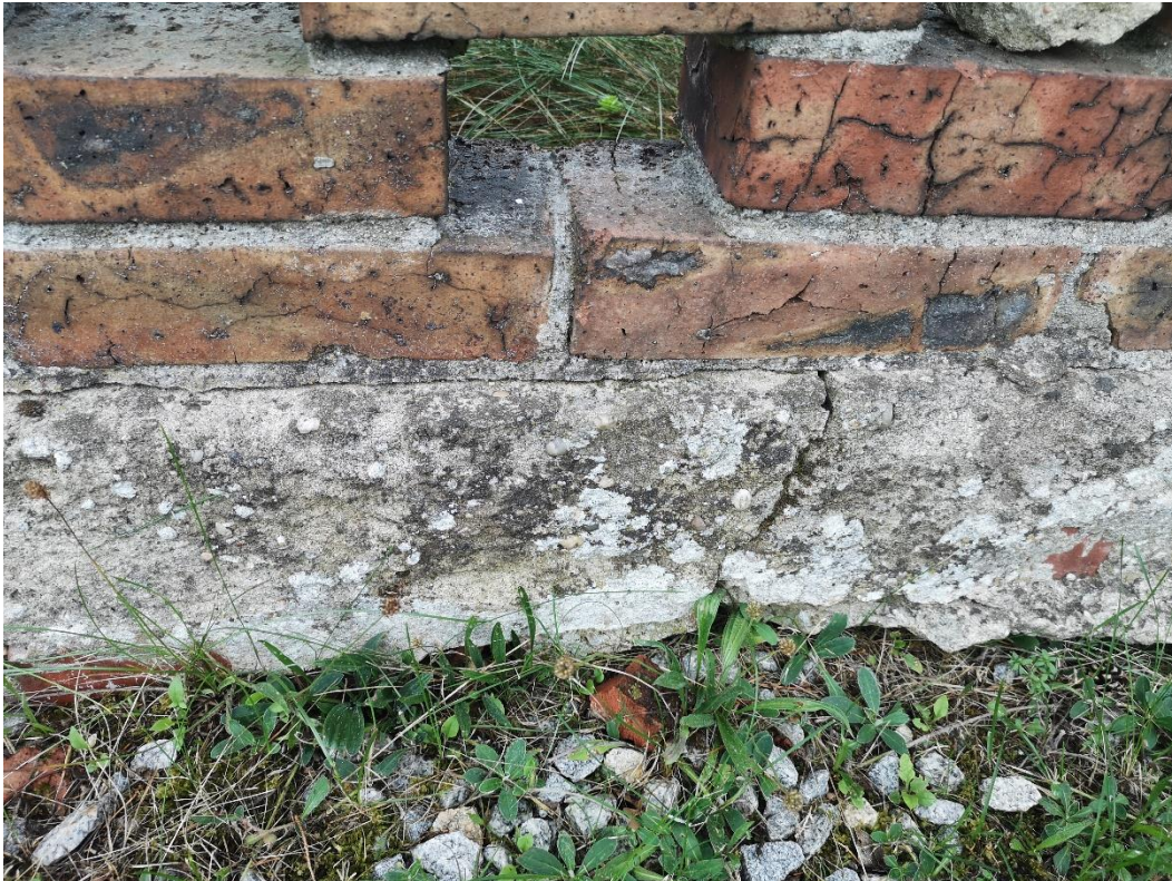
Spękania fundamentu i duże ubytki posadowienia
