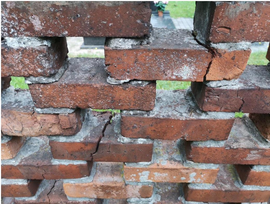
Pęknięcie na całej wysokości wypełnienia
