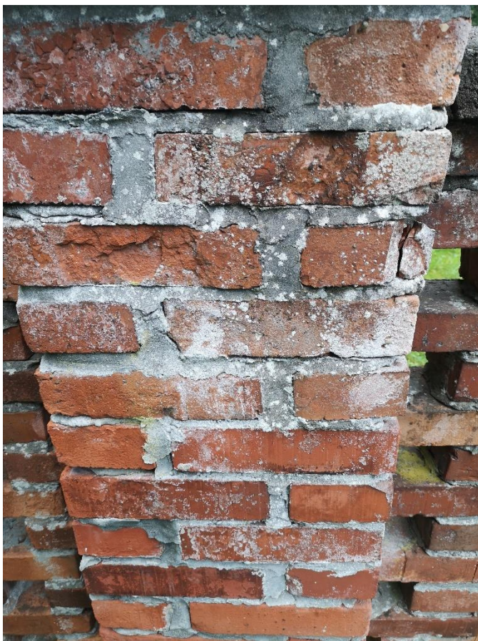
Korozja biologiczna cegieł słupka, niefachowe uzupełnienia zaprawą cementową
