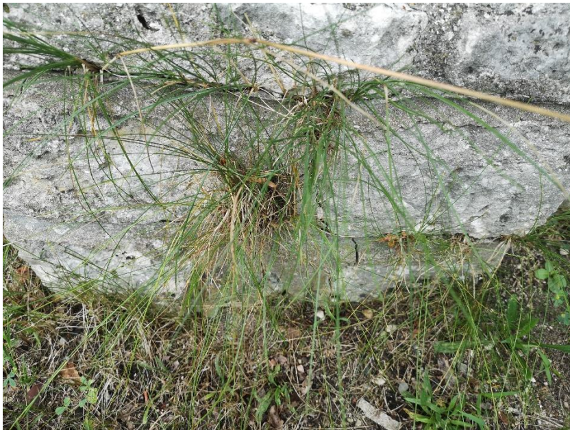
Pęknięcie i porosty fundamentu
