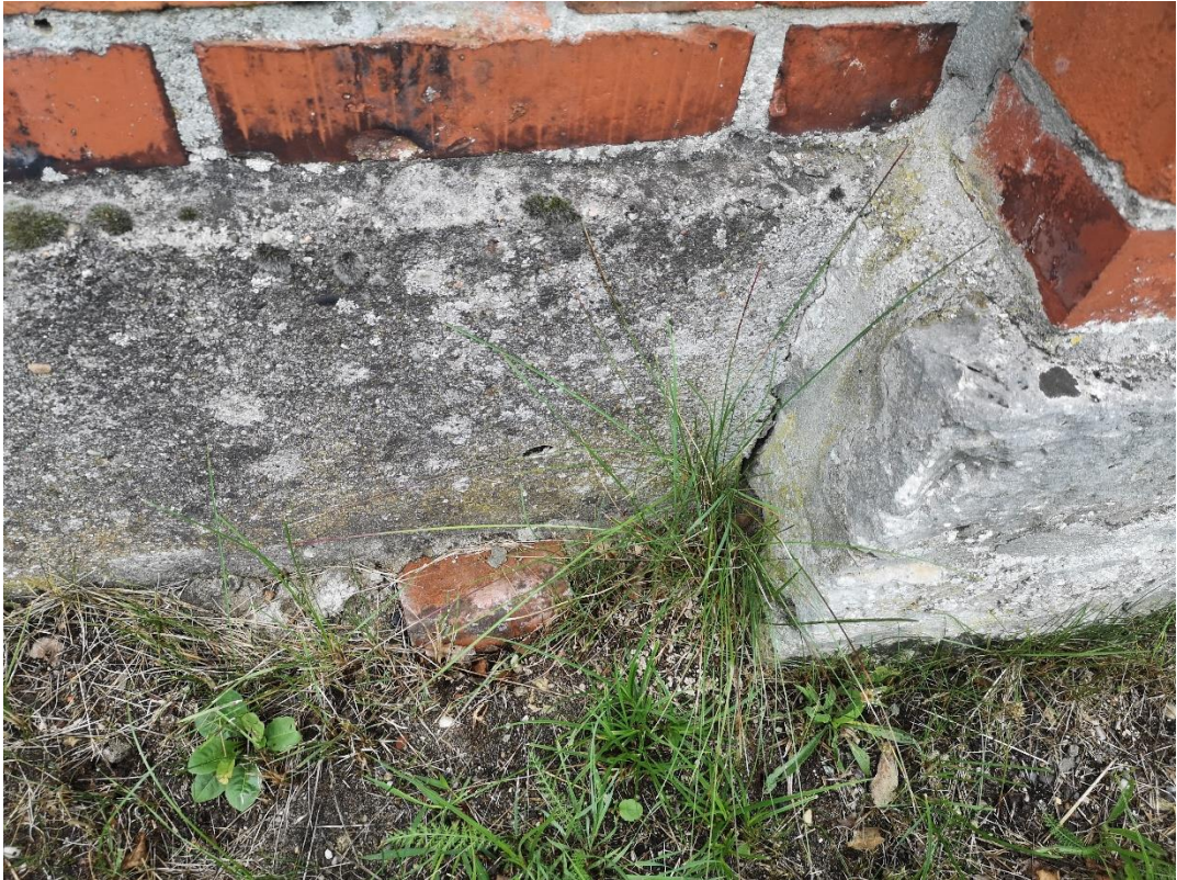
Pęknięcia fundamentu ogrodzenia
