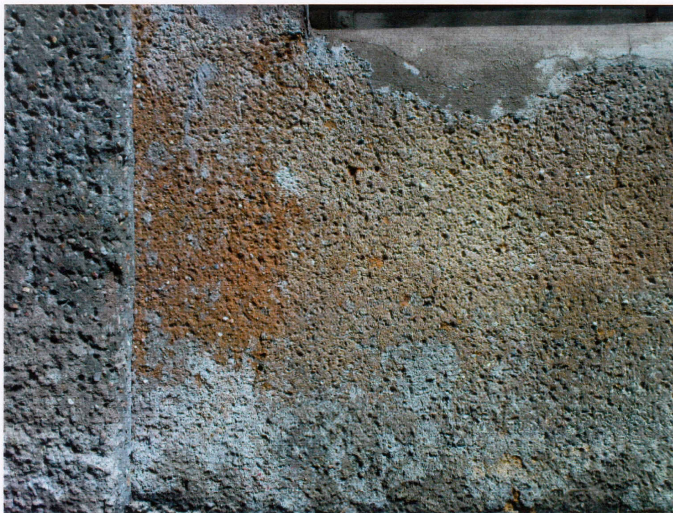
Fot. 1. Oczyszczona powierzchnia żółtego tynku. Widoczne odbarwienia spowodowane działaniem HF.
