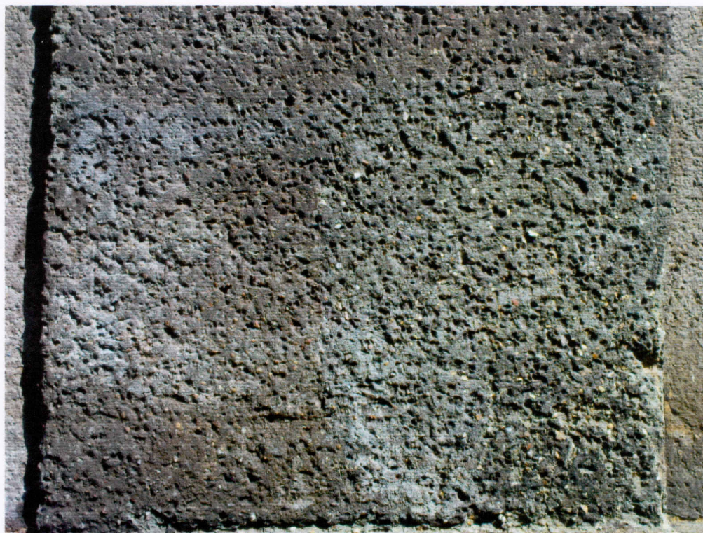
Fot. 2. Oczyszczona powierzchnia szarego tynku. Widoczne zielonkawe zabarwienie oczyszczonej zaprawy (prawa strona).
