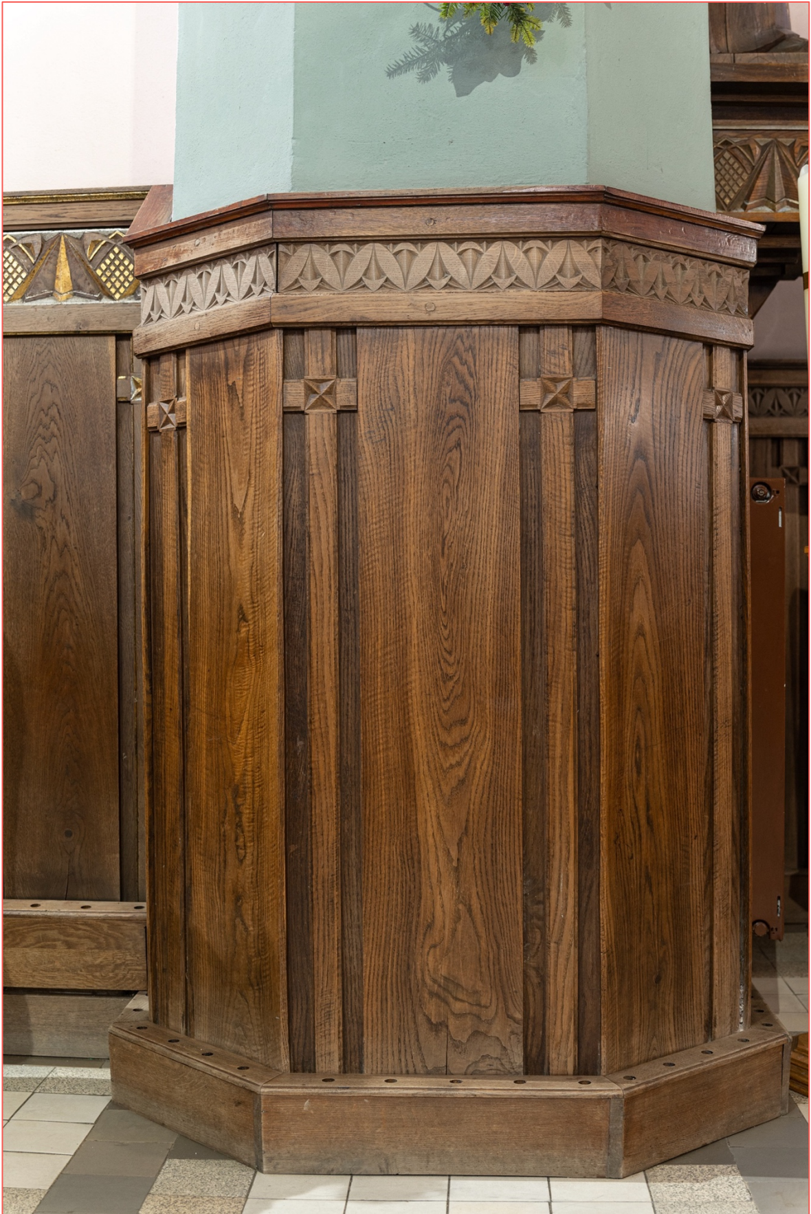
61. Boazeria w dolnej części filara pomiędzy nawą a prezbiterium. Fot. Z. Możdziej, 14 I 2023
