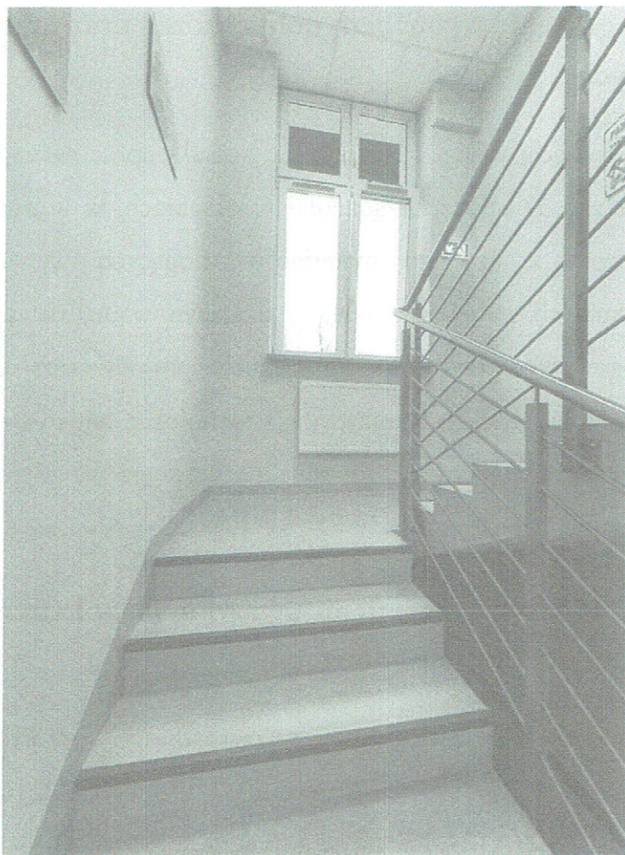
Zdjęcie 3. Grzejnik do usunięcia oraz parapet do zmiany w skrzydle zachodnim
