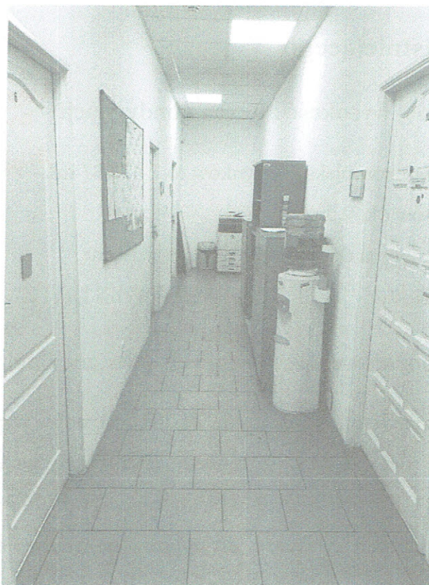
Zdjęcie 1. Niezgodne z wymaganiami składowanie materiałów palnych na drodze ewakuacyjnej
