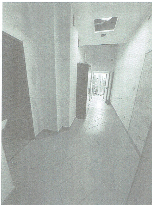
Zdjęcie 2. Niezgodne z wymaganiami składowanie materiałów palnych (szafa z cieciami palnymi) na drodze ewakuacyjnej
