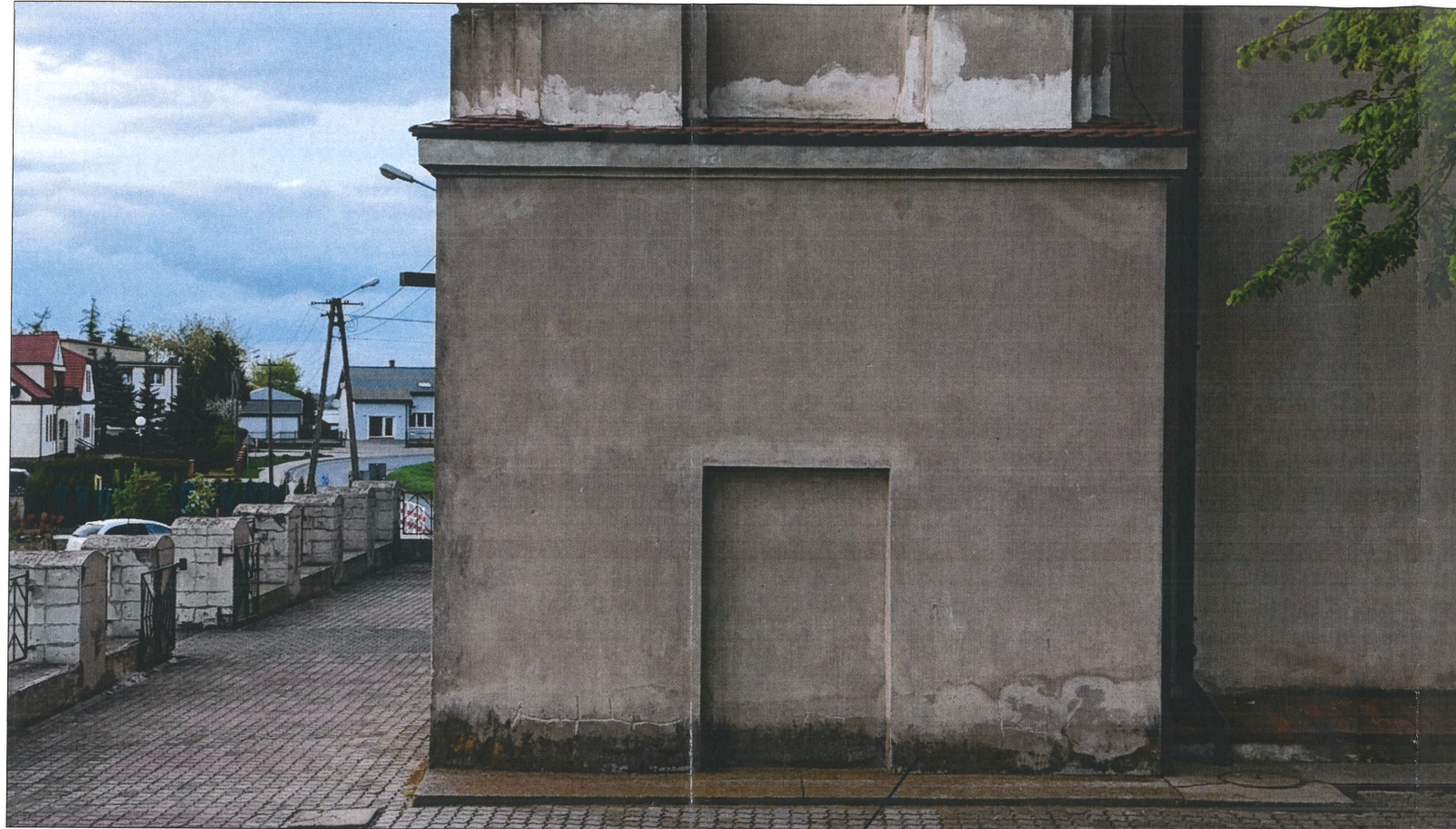
Miejsce występowania zawilgoconych - zasolonych tynków, spękania wypraw tynkarskich
