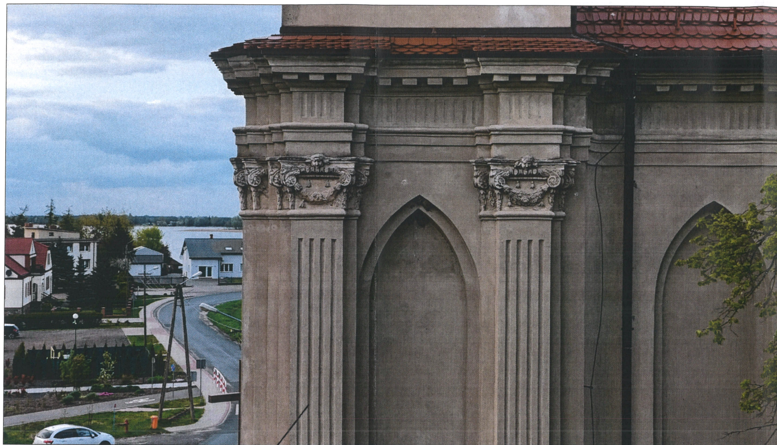
Środkowa część elewacji południowej wieży. Liczne spękania wypraw tynkarskich uzupełnienia o nieodpowiedni dobranej barwie oraz fakturze
