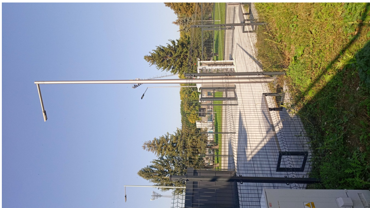
12. Istniejące oświetlenie zewnętrzne LED.
