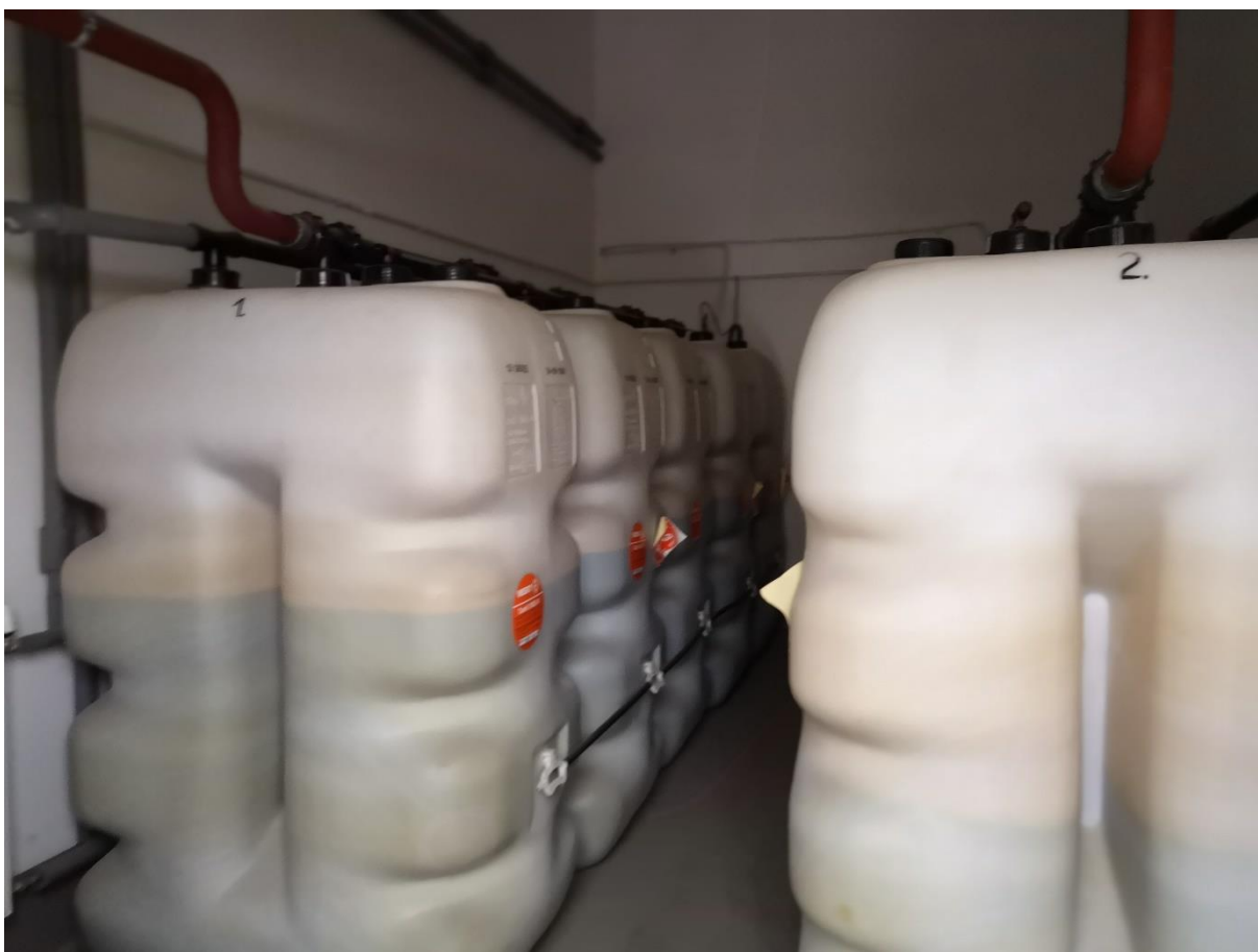
Zdjęcie 4. Magazyn oleju opałowego – obiekt 600
