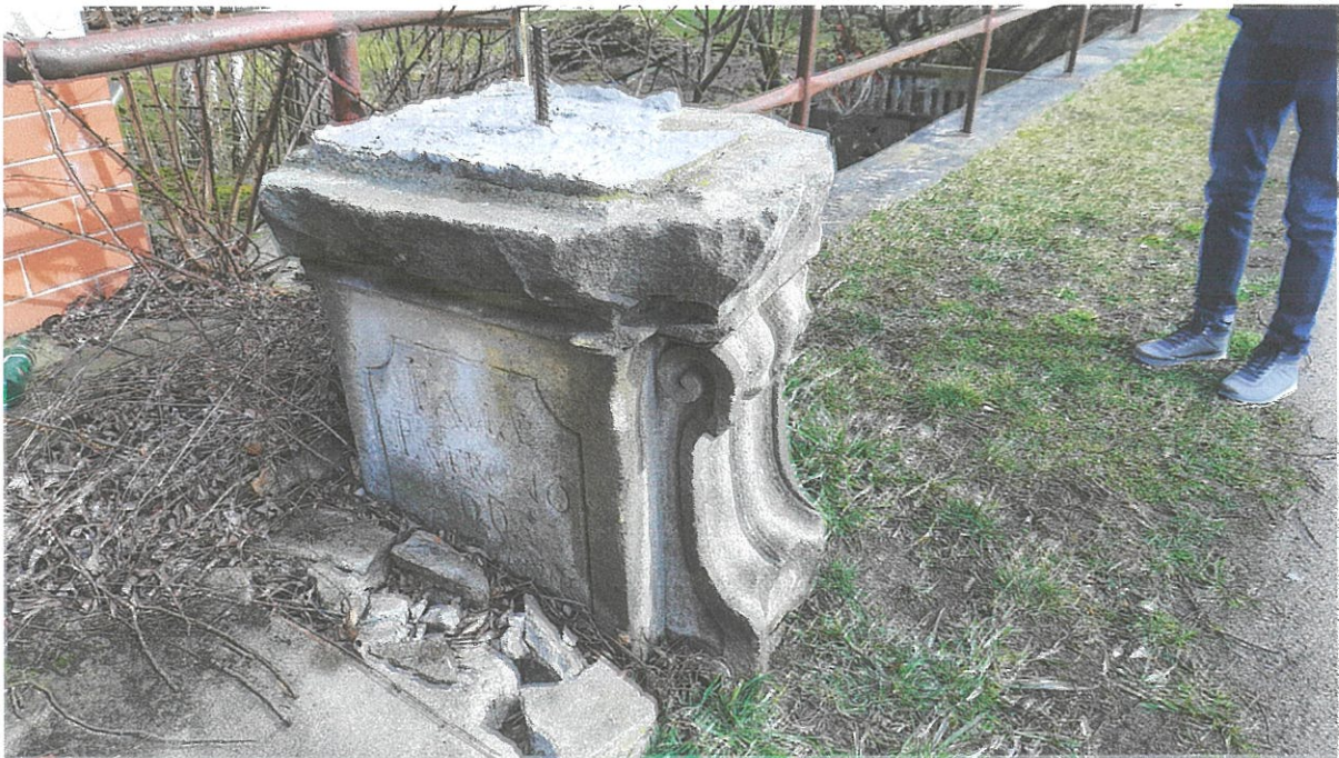
Fot. 6. Województwo dolnośląskie, powiat legnicki, Kościelec, Rzeźba kamienna, wolnostojąca, przedstawiająca św. Jana Nepomucena, część cokołowa, widoczne liczne uszkodzenia, zabrudzenia powierzchni, powierzchnia mocno zdegradowana, liczne uszkodzenia formy rzeźbiarskiej, K. Łopatowska 2021.
