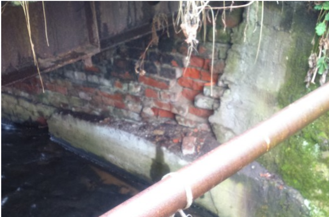
Zdjęcie nr 3.7 : Wykruszony fragment przyczółka ceglanego
