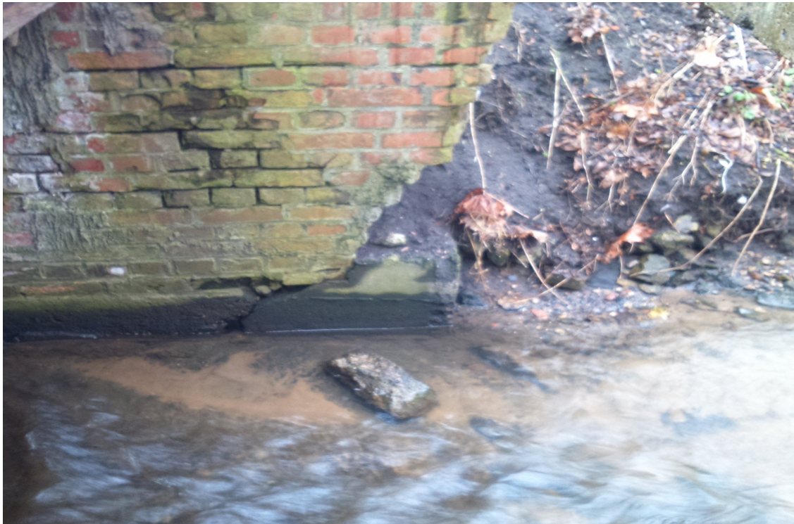
Zdjęcie nr 3.5 : Uszkodzony przyczółek i umocnienie skarpy
