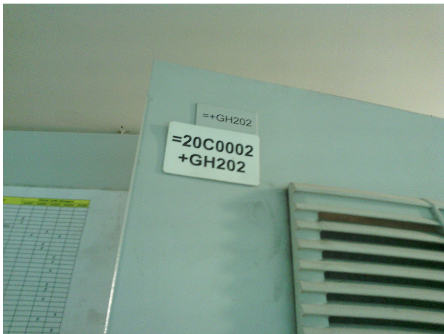
Pomiary kamerą termowizyjną - pomiary szafy GH202
