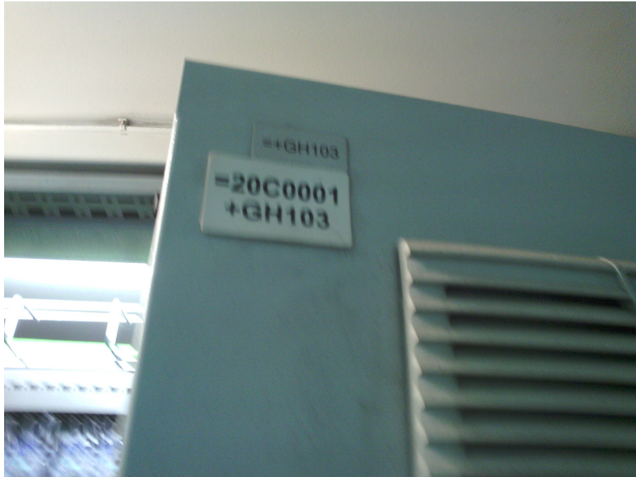
Pomiary kamerą termowizyjną - pomiary szafy GH103
