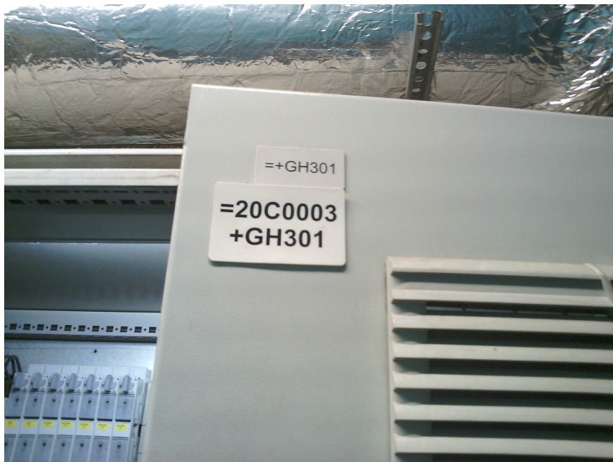
Pomiary kamerą termowizyjną - pomiary szafy GH301
