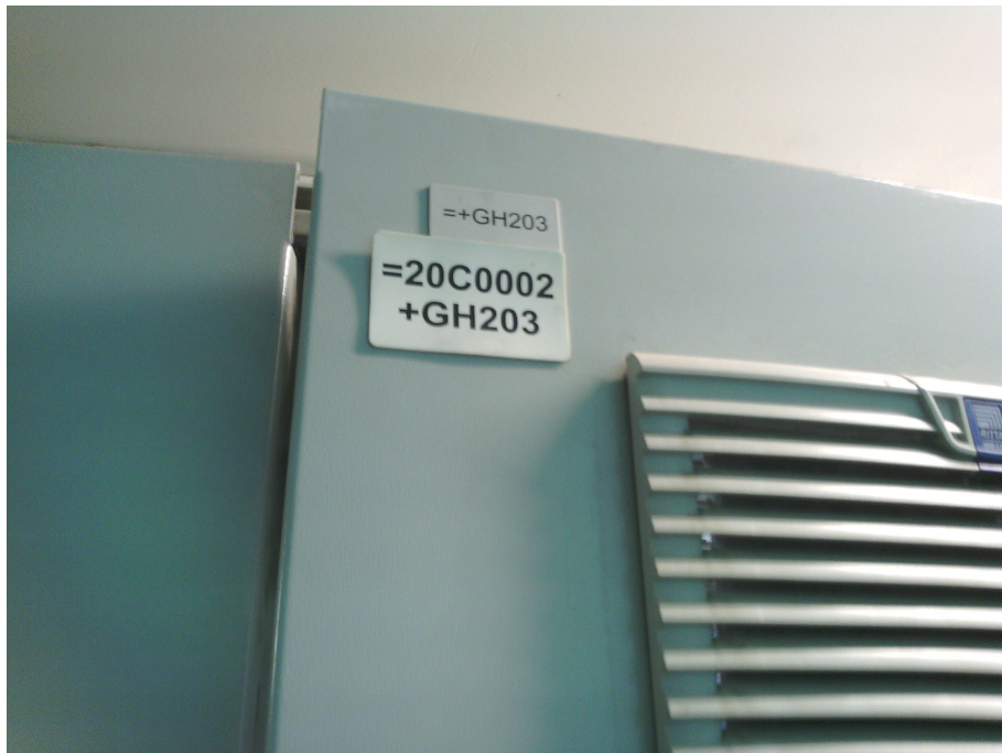
Pomiary kamerą termowizyjną - pomiary szafy GH203
