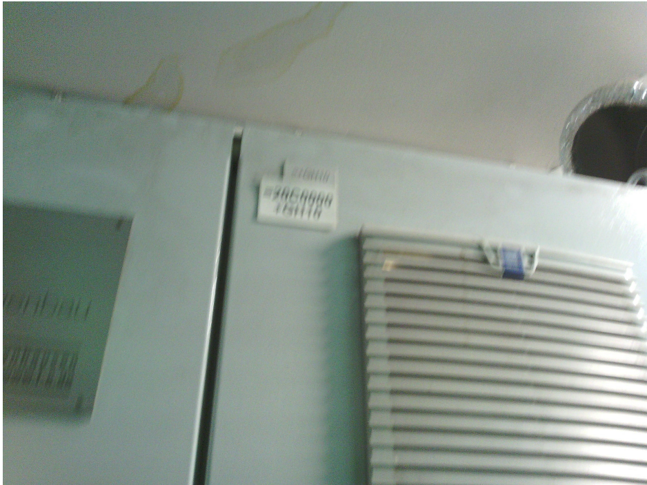
Pomiary kamerą termowizyjną - pomiary szafy GH105
