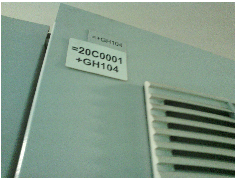
Pomiary kamerą termowizyjną - pomiary szafy GH104
