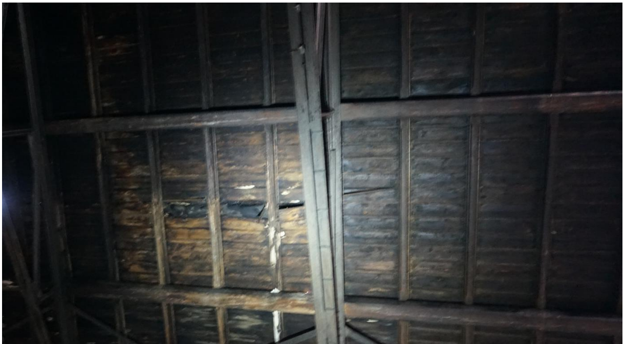
Fot. 7 Uszkodzenie nr 2 w dachu.
