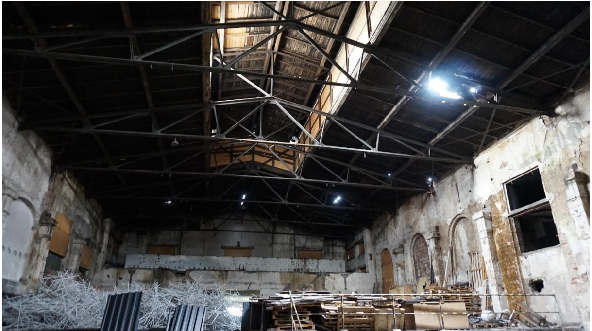
Fot. 6 Uszkodzenie nr 1 w dachu.
