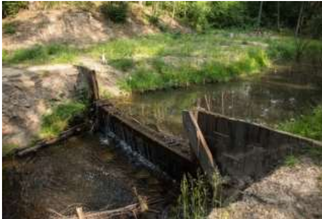
Próg wygięty pod presją naporu wody. Źródło: Archiwum CKPŚ.
