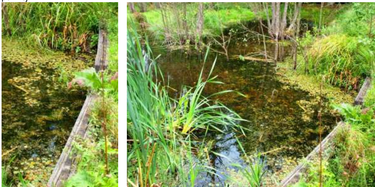
Nawet małe zastawki ulegają naporowi wody jeśli pozbawione są wzmocnień zastrzałem, oczepem i podparciem od dołu umocnieniem. Fot. Z. Filipek Źródło: Archiwum CKPŚ
