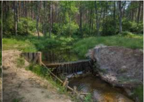
Widoczna erozja dna i skarp prowadząca do osłabienia konstrukcji. Źródło: Archiwum CKPŚ
