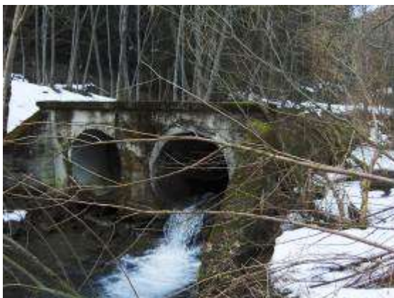
Zniszczony betonowy przepust na nieużytkowanym szlaku zrywkowym, przerywający ciągłość biologiczną cieku
