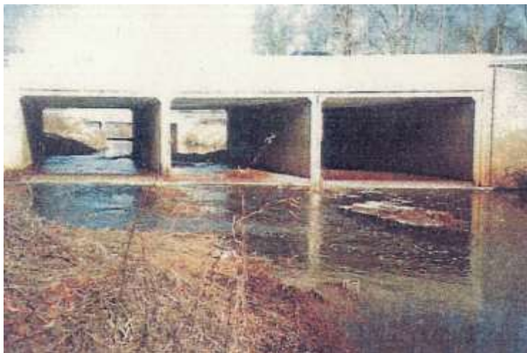
Błędnie zaprojektowana rzędna dna rozlewająca wodę w ciek szerzej niż naturalne koryto. Źródło: „Metody hydraulicznego projektowania przepustów z uwzględnieniem morfologii ciek i wymogów związanych ze swobodnym przepływem ryb.” A.J. Kosicki w „Hydraulika, hydrologia, hydrogeologia”
