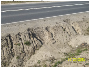
Skarpy, pobocza rozmycia do uzupełnienia
