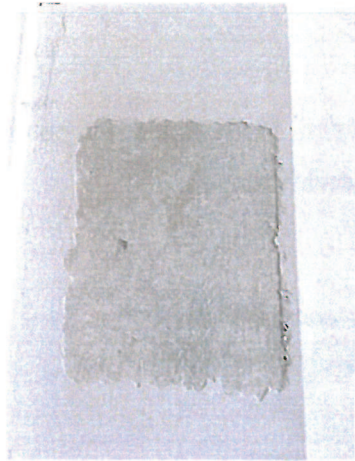
Fot. nr 32. Odkrywka na ścianie w pierwszej części sieni. Brak dekoracji. Jasno szary kolor ściany.
