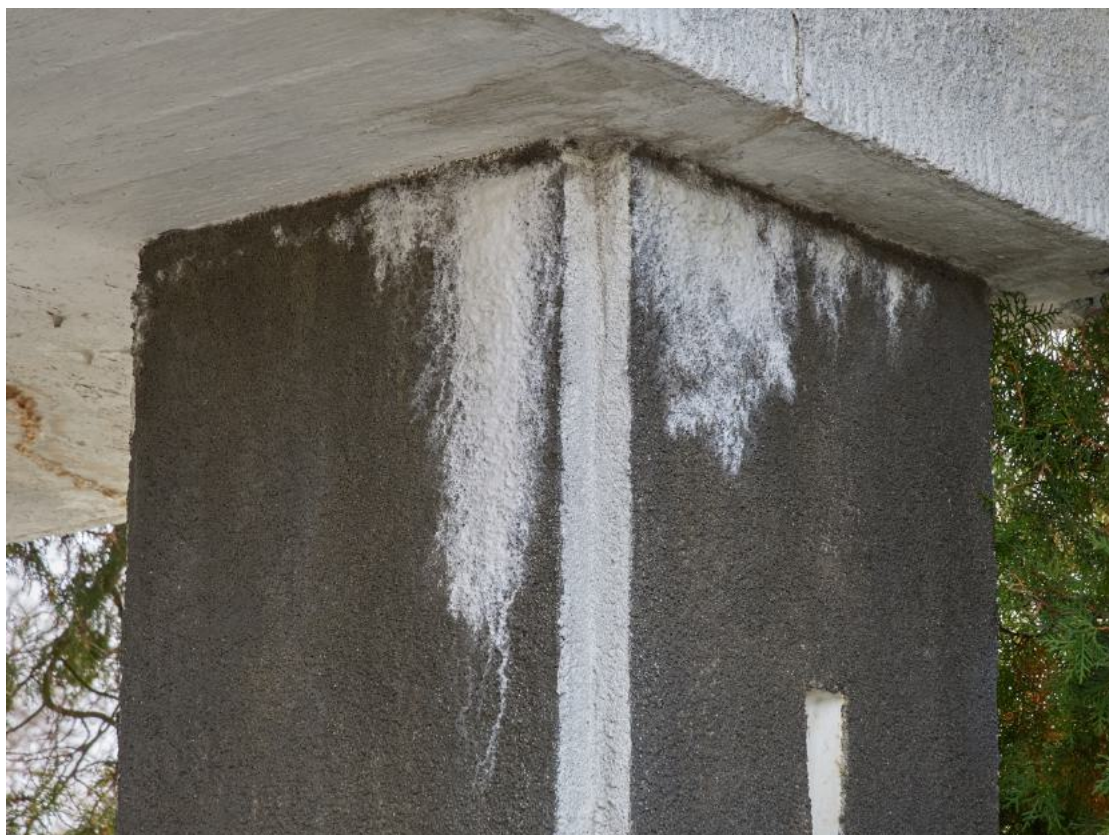
Fot. 27. Wykwity z kalcytu na powierzchni filara, w jego górnej części. Powierzchnia lastriko pokryta wtórnie zaprawą i przemalowana
