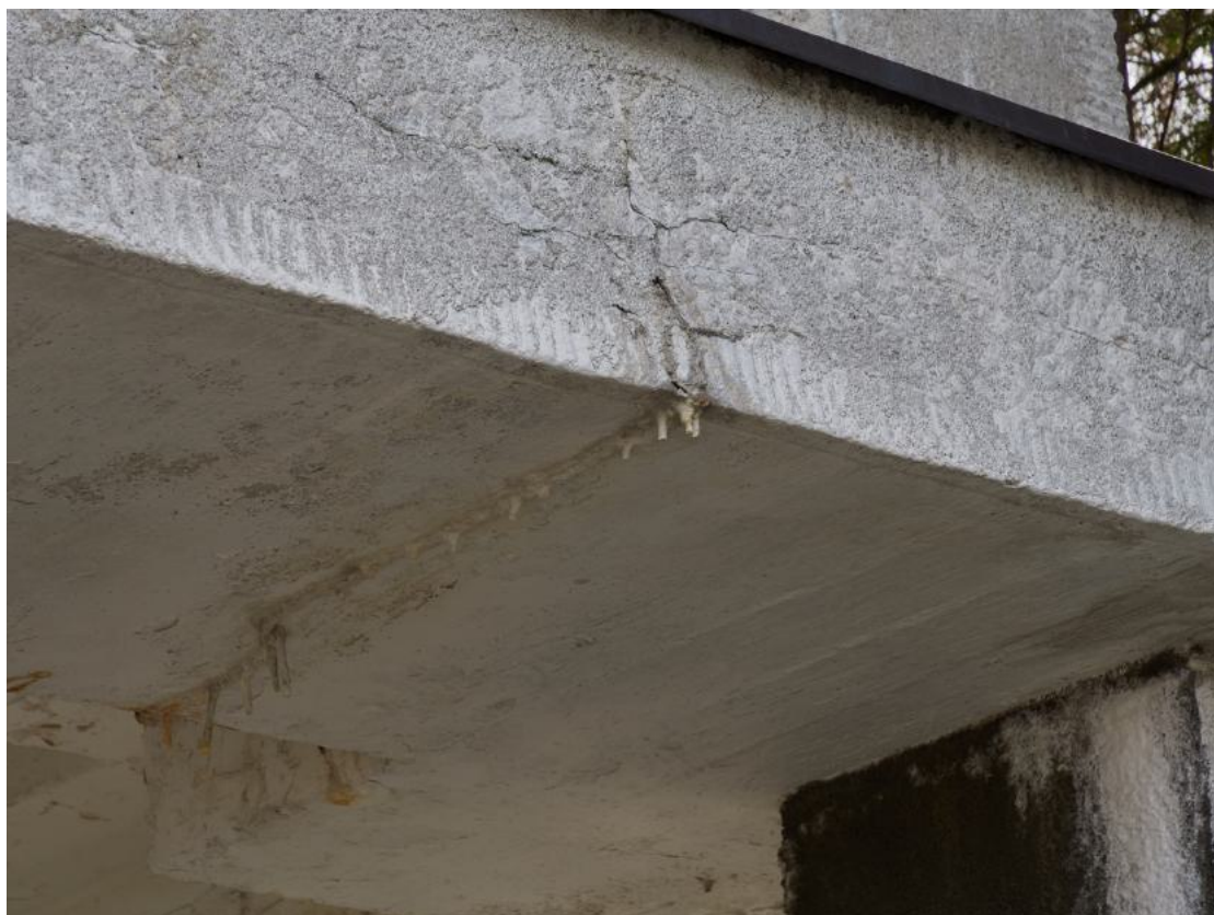
Fot. 26. Spękania z wtórnym wypełnieniem – fragment sklepienia. Na bocznej ścianie widoczna wtórna zaprawa na lastriko
