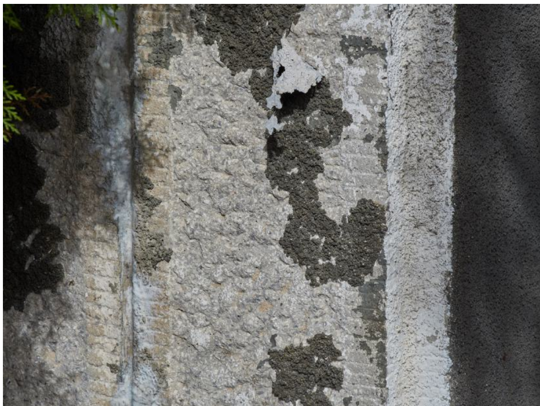
Fot. 37. Powierzchnia pierwotnego lastriko pod złuszczającymi się warstwami wtórnymi
