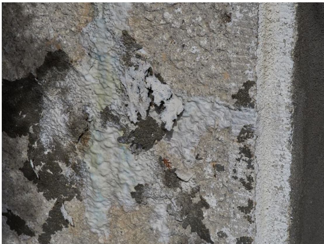
Fot. 36. Powierzchnia pierwotnego lastriko pod złuszczającymi się warstwami wtórnymi
