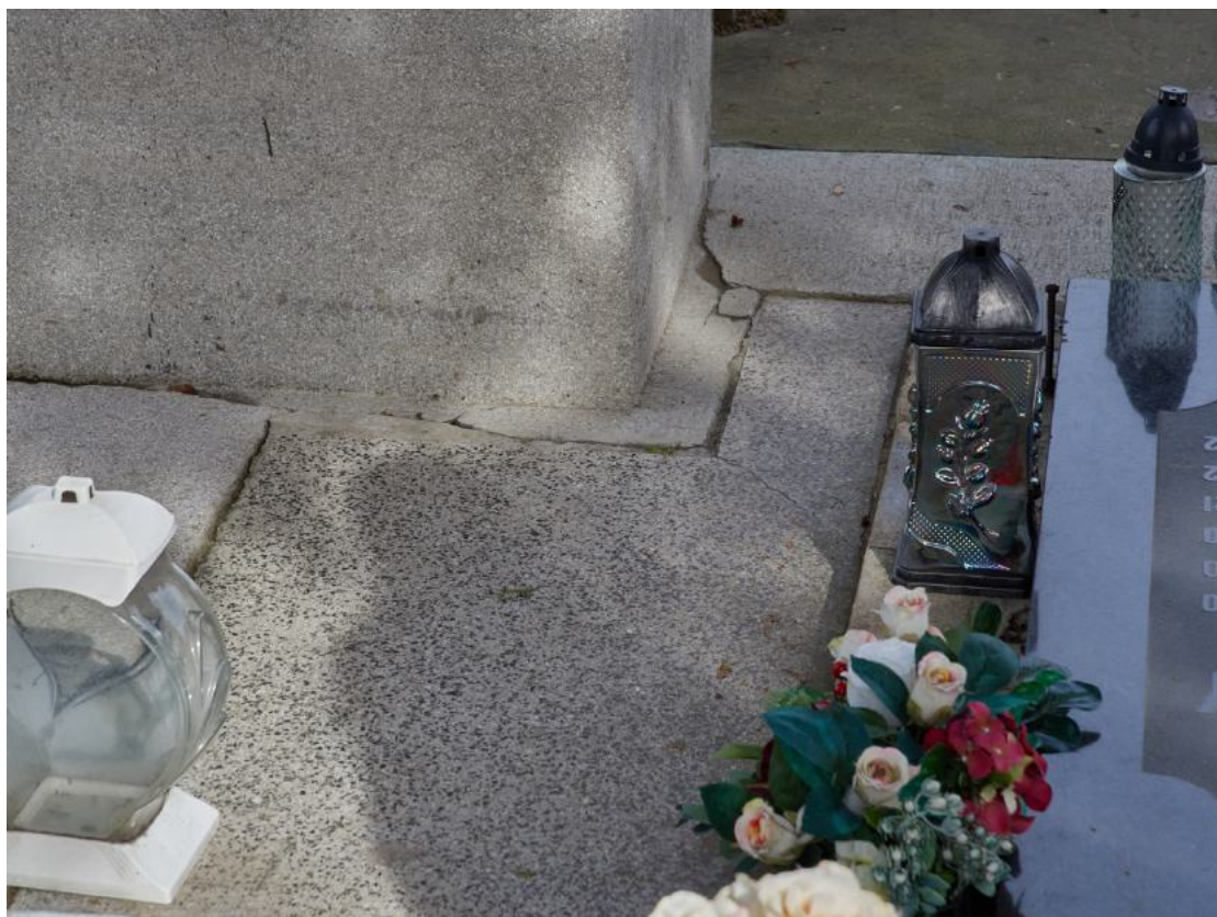
Fot. 32. Posadzka z lastriko z zapadnięciem i spękaniem
