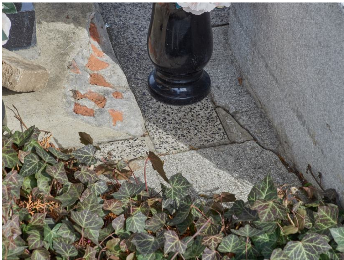
Fot. 33. Zniszczenia posadzki z lastriko
