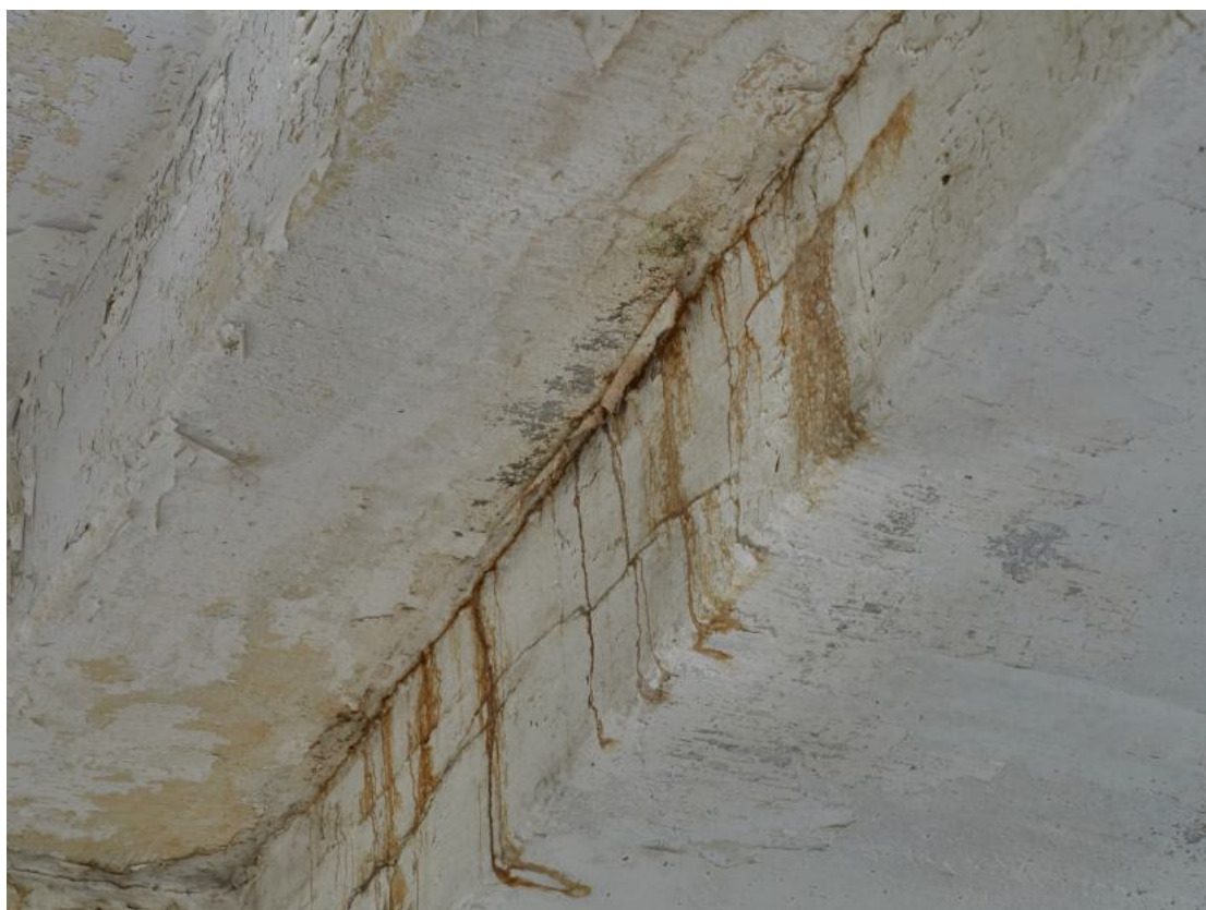
Fot. 25. Zacieki na sklepieniu
