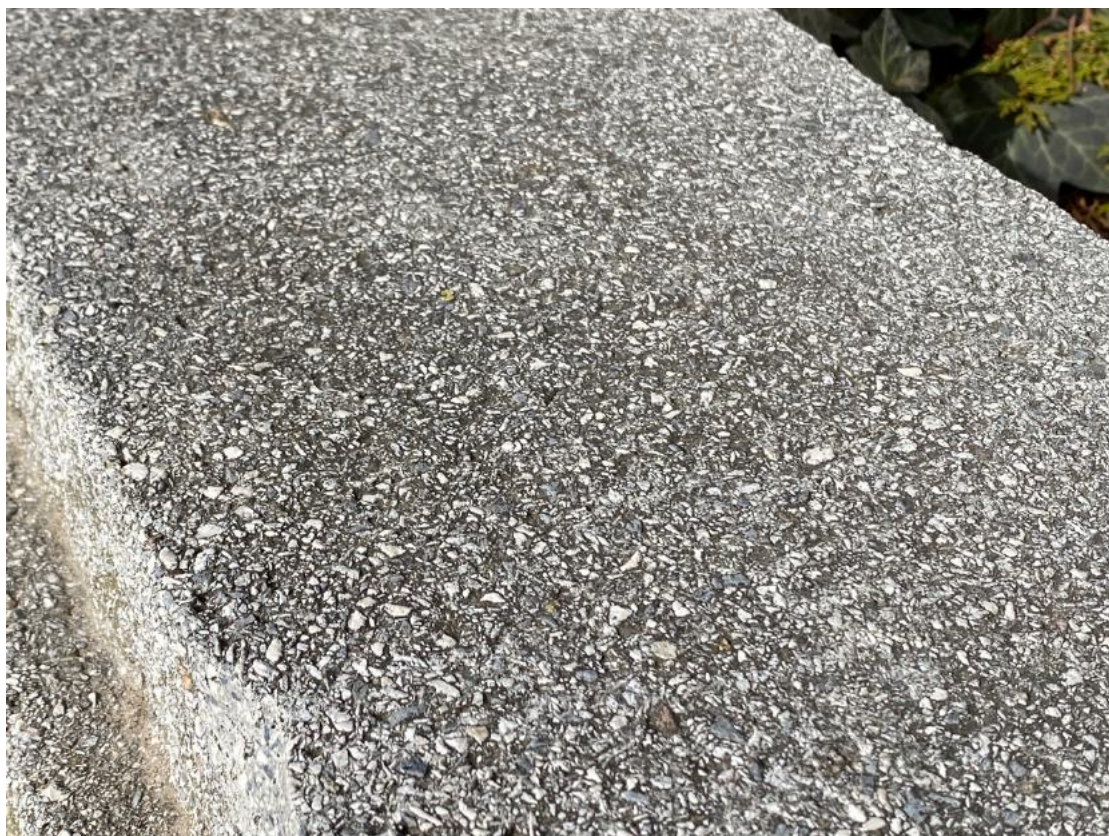
Fot. 40. Lastriko – oryginalna powierzchnia z widocznym wypłukaniem części spoiwa
