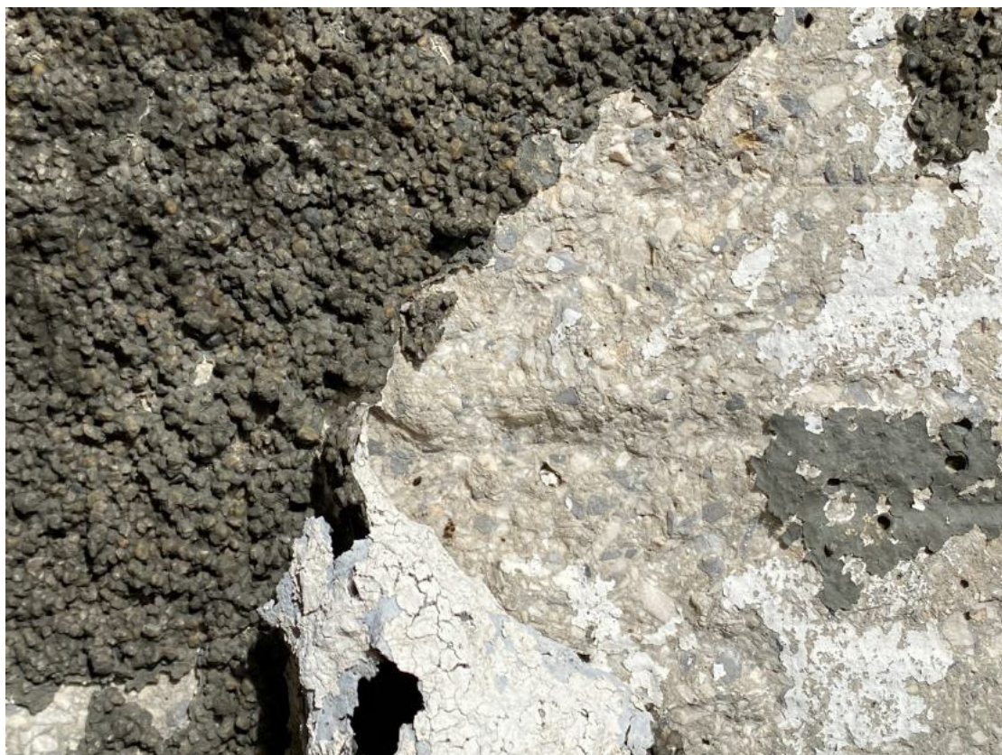
Fot. 38. Powierzchnia pierwotnego lastriko pod złuszczającymi się warstwami wtórnymi
