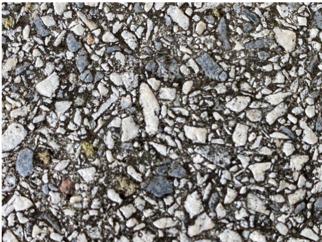
Fot. 41. Lastriko – oryginalna powierzchnia z widocznym wypłukaniem części spoiwa
