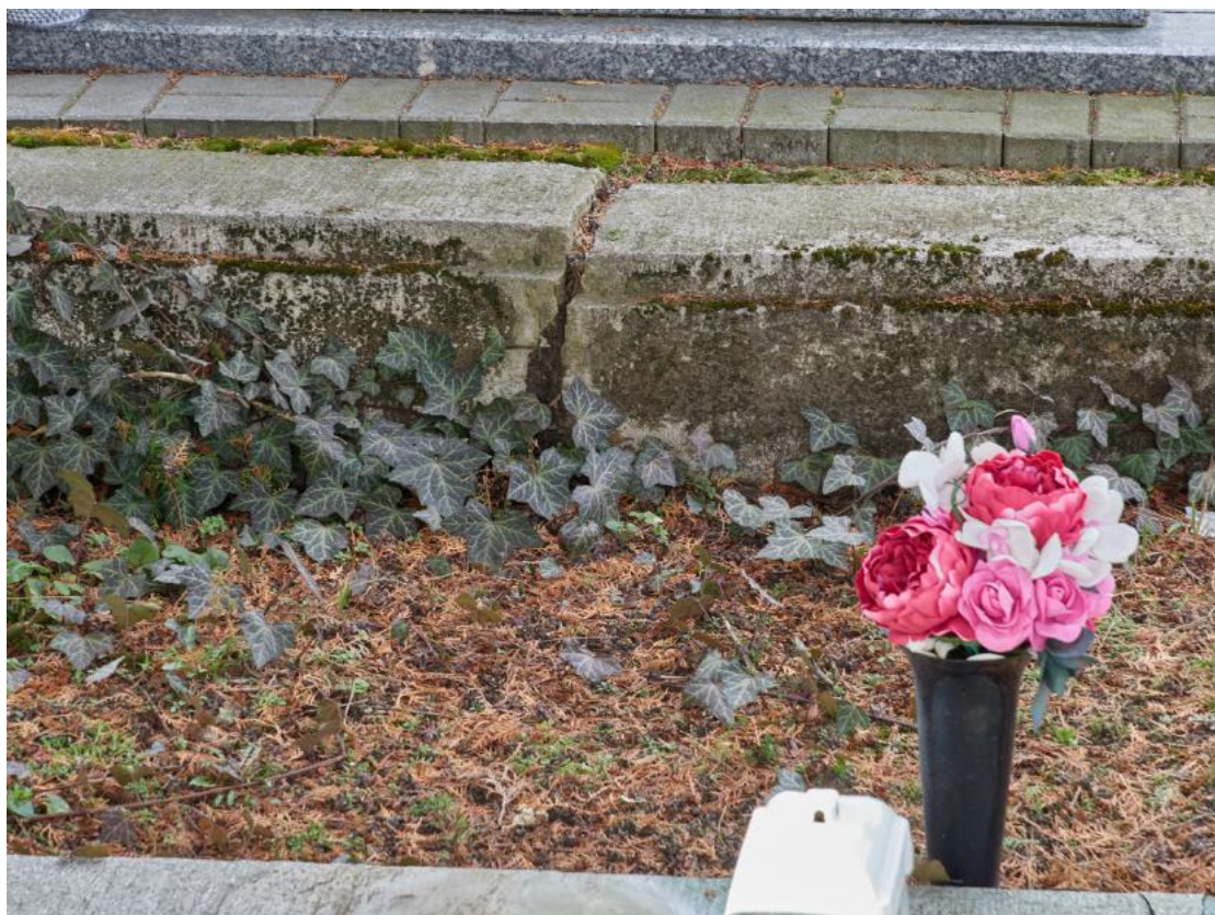
Fot. 35. Fragment ogrodzenia z pęknięciem
