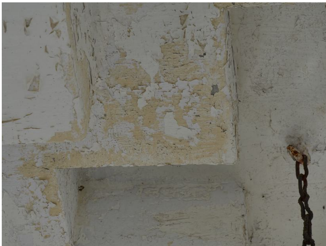
Fot. 24. Fragment wtórnie malowanego sklepienia. Widoczna złuszczająca się farba
