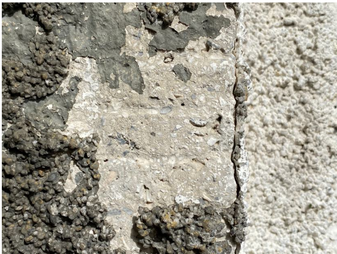
Fot. 39. Powierzchnia pierwotnego lastriko pod złuszczającymi się warstwami wtórnymi
