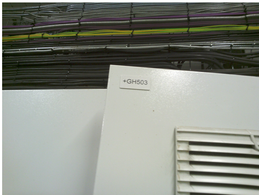
Pomiary kamerą termowizyjną - pomiary szafy GH503
