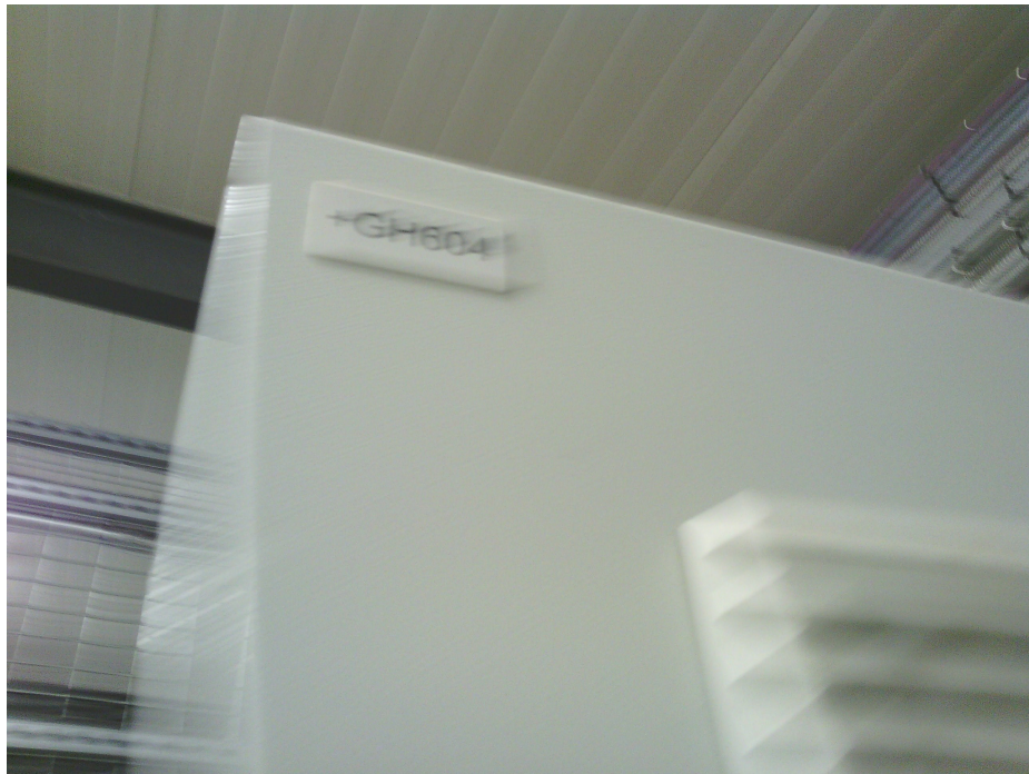
Pomiary kamerą termowizyjną - pomiary szafy GH604
