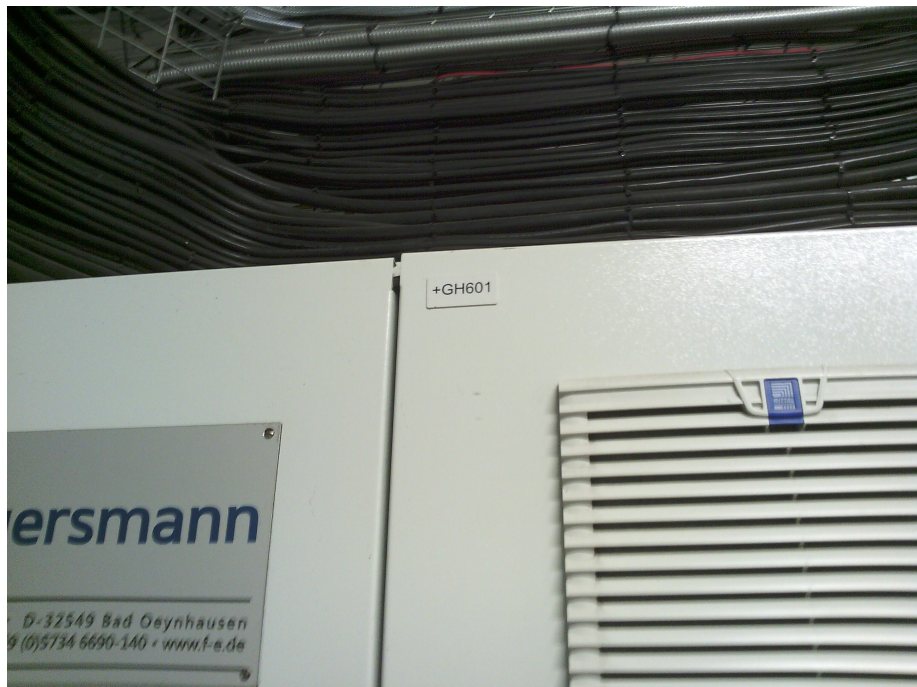
Pomiary kamerą termowizyjną - pomiary szafy GH601
