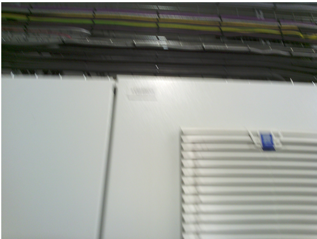
Pomiary kamerą termowizyjną - pomiary szafy GH505
