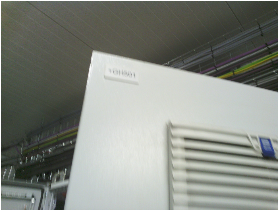
Pomiary kamerą termowizyjną - pomiary szafy GH501
