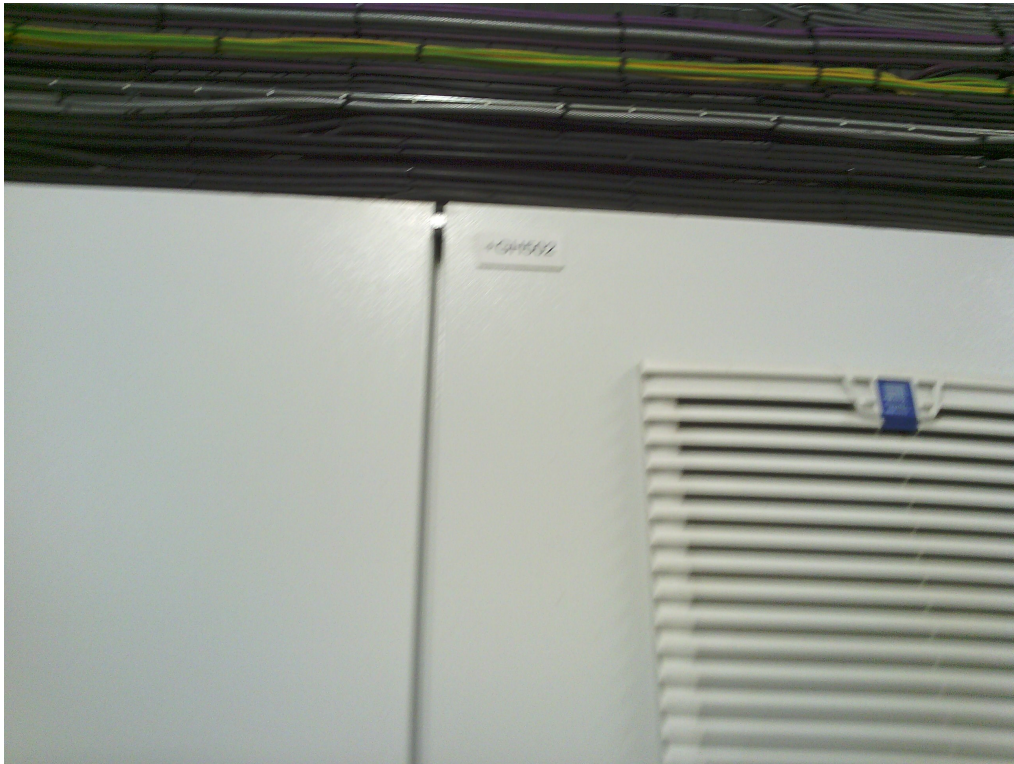
Pomiary kamerą termowizyjną - pomiary szafy GH502
