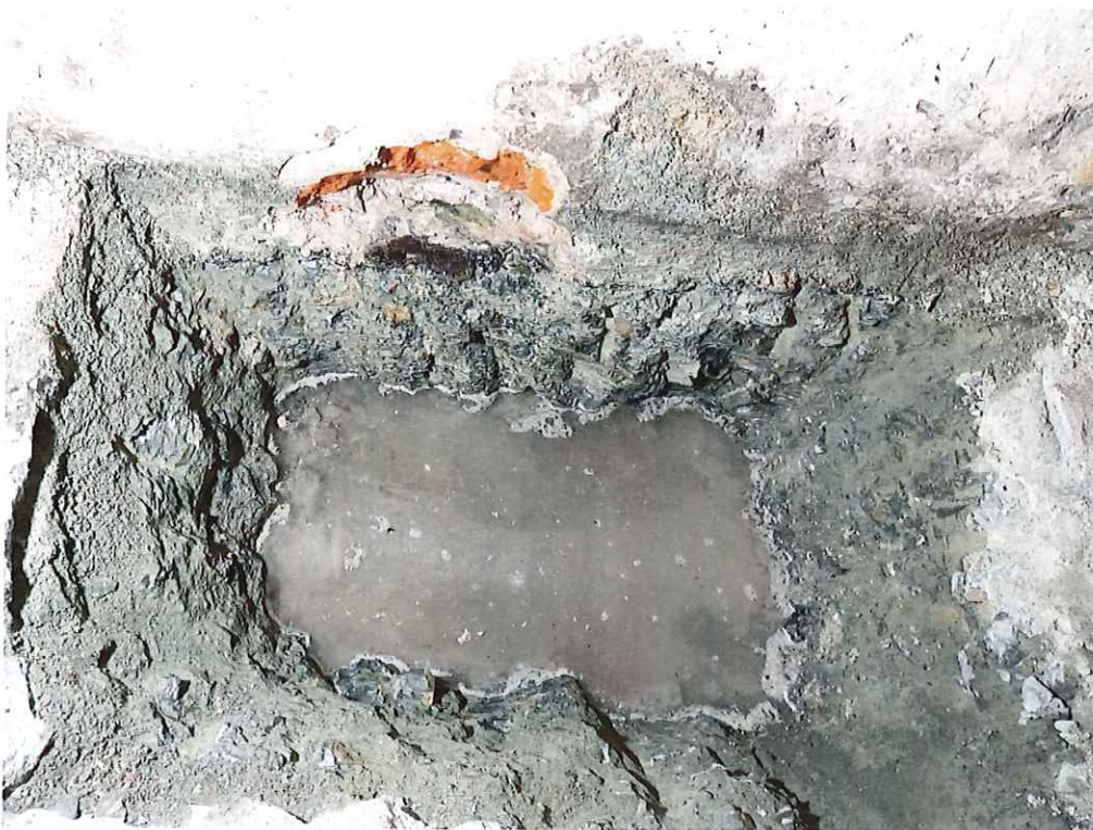
Foto 8 Bardzo wysoki poziom wód gruntowych- odkrywka nr 1 w piwnicy przy ścianie zewnętrznej
