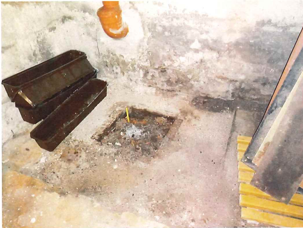
Foto 1 Studzienka drenarska przy ścianie zewnętrznej SD 1
