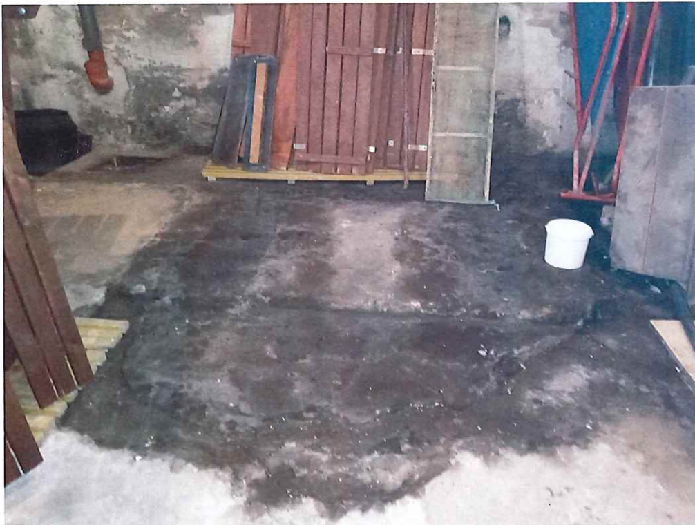
Foto 6 Zawilgocona posadzka w byłej kotłowni
