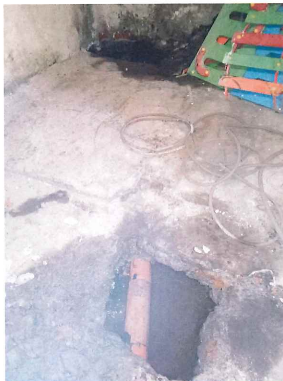
Foto 14 Rura drenarska w pom. kotłowni
