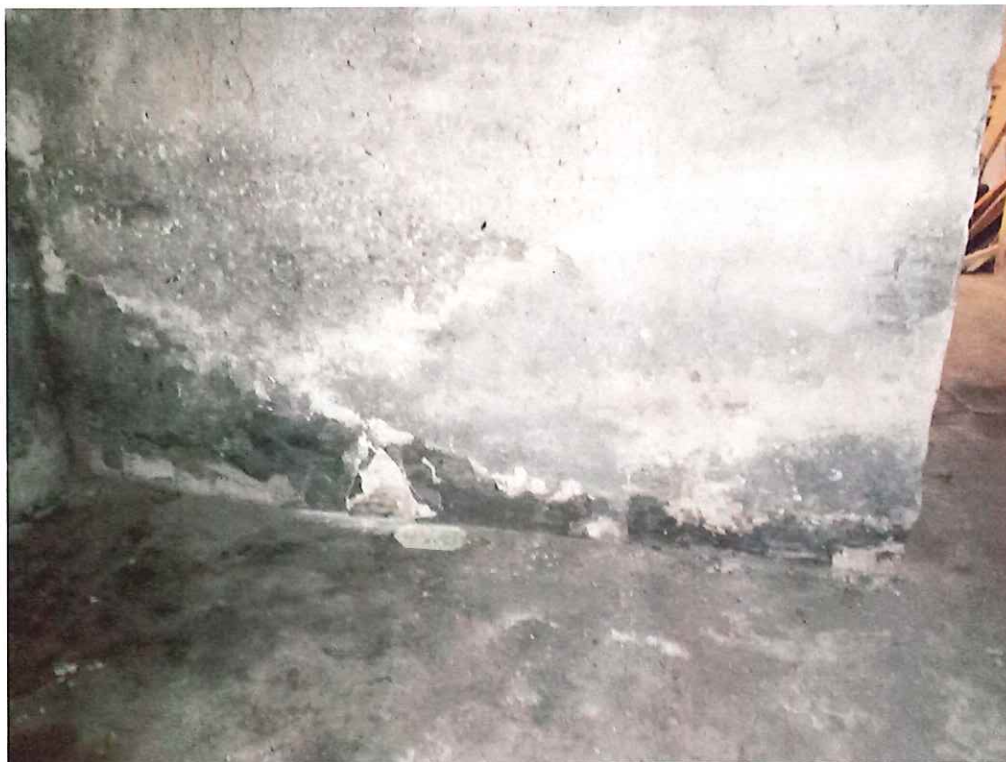
Foto 2 Zawilgocone ściany byłej kotłowni
