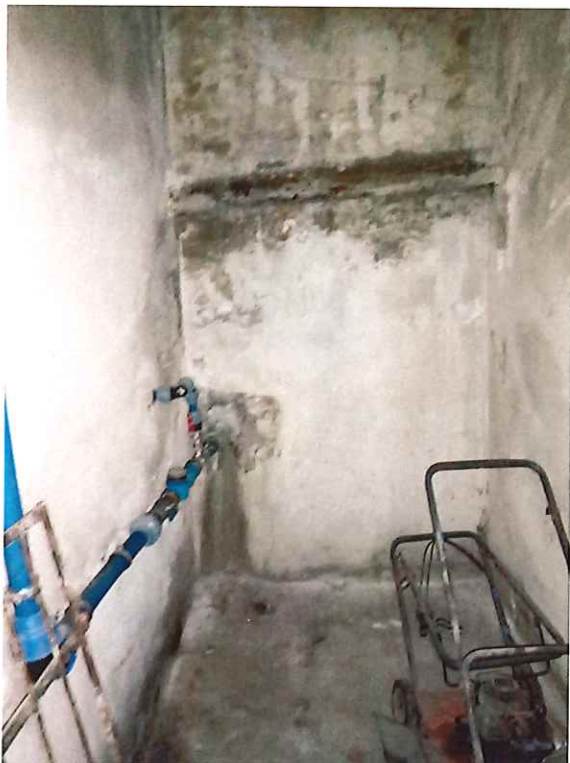
Foto 4 Przyłącz wodociągowy w pom. Byłej kotłowni
