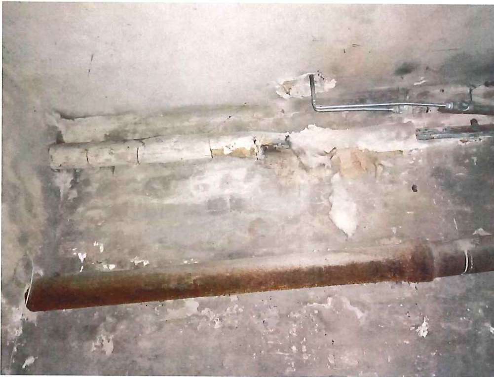
Foto 3 Zawilgocone ściany byłej kotłowni
