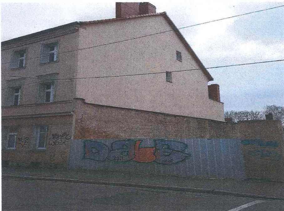
Brak docieplenia na ścianie szczytowej po dokonanej rozbiórce
