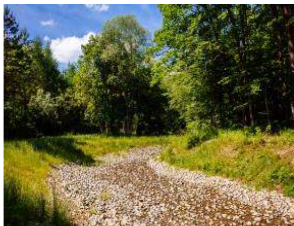
Bystrze o zwiększonej szorstkości w miejscu rozebranego betonowego jazu, przywracające ciągłość biologiczną cieku
