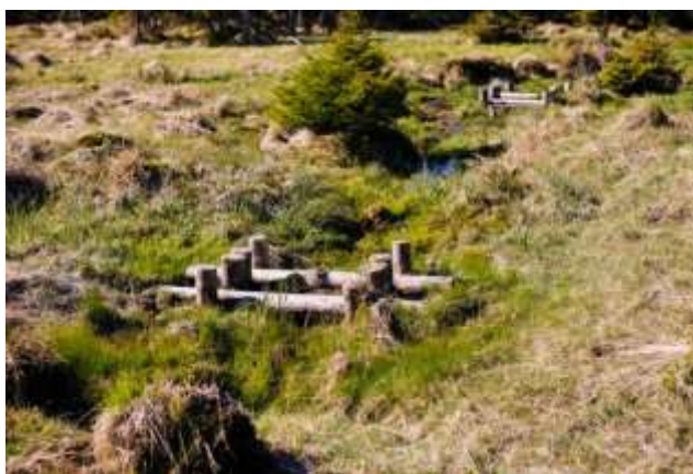
Zarastający rów odwadniający dzięki zastosowaniu przytamoń ziemno-drewnianych – Nadleśnictwo Szklarska Poręba. Źródło: Archiwum CKPŚ
