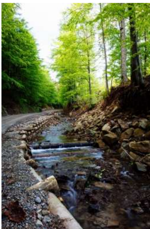
Poniżej progu widoczne są dwa „baseny”, próg pośredni i gurt. Niestety próg nie ma przelewu na małą wodę. Źródło: Archiwum CKPŚ.
