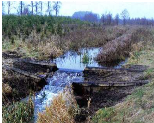
Próg z dwiema ściankami szczelnymi, wypełniony ziemią – brak ubezpieczenia progu dolnego od strony wody dolnej. Źródło: „Natura a gospodarka wodna” P.Kowalczyk, P.Niezanński, R.Stańko, F.M.Mas, M.B.Sanz, 2009 r.
