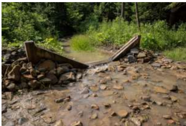
Próg powyżej brodu ukierunkowujący wodę na bród.
