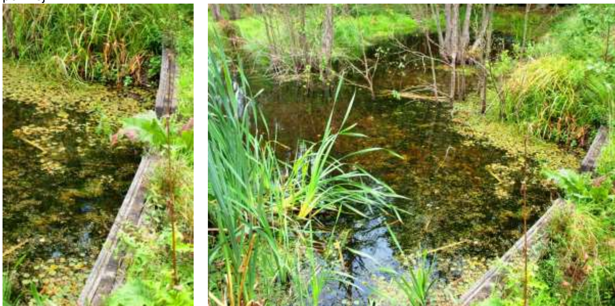
Nawet małe zastawki ulegają naporowi wody jeśli pozbawione są wzmocnień zastrzałem, oczepem i podparciem od dołu umocnieniem. Fot. Z. Filipek Źródło: Archiwum CKPŚ
