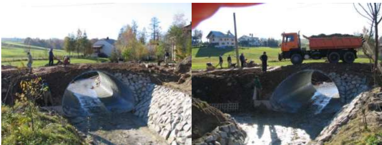
Przykłady adaptacji przepustów do zmian klimatu.
