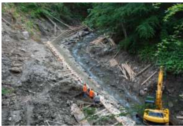
Budowa największej kaszycy w projekcie retencji górskiej – zwraca uwagę solidne ubezpieczenie podstawy kaszycy głazami – Nadleśnictwo Stuposiany Źródło: Archiwum CKPŚ.
