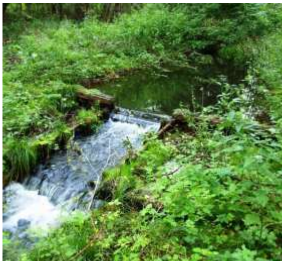
Próg z dwiema ściankami szczelnymi, ubezpieczony palisadą boczną, przelew pomiędzy ściankami, brak ubezpieczenia progu dolnego od strony wody dolnej. Fot. Z. Filipek. Źródło: Archiwum CKPŚ.
